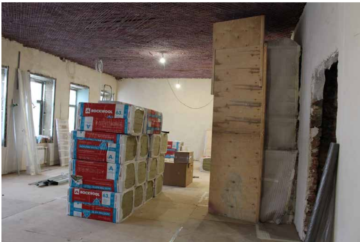
Фото 15. Выявленный объект культурного наследия «Дом, в котором в 1892-1913 годах жил ученый-баллист Н.А. Забудский». Квартира № 8. Вид на печь в помещении № 4.
