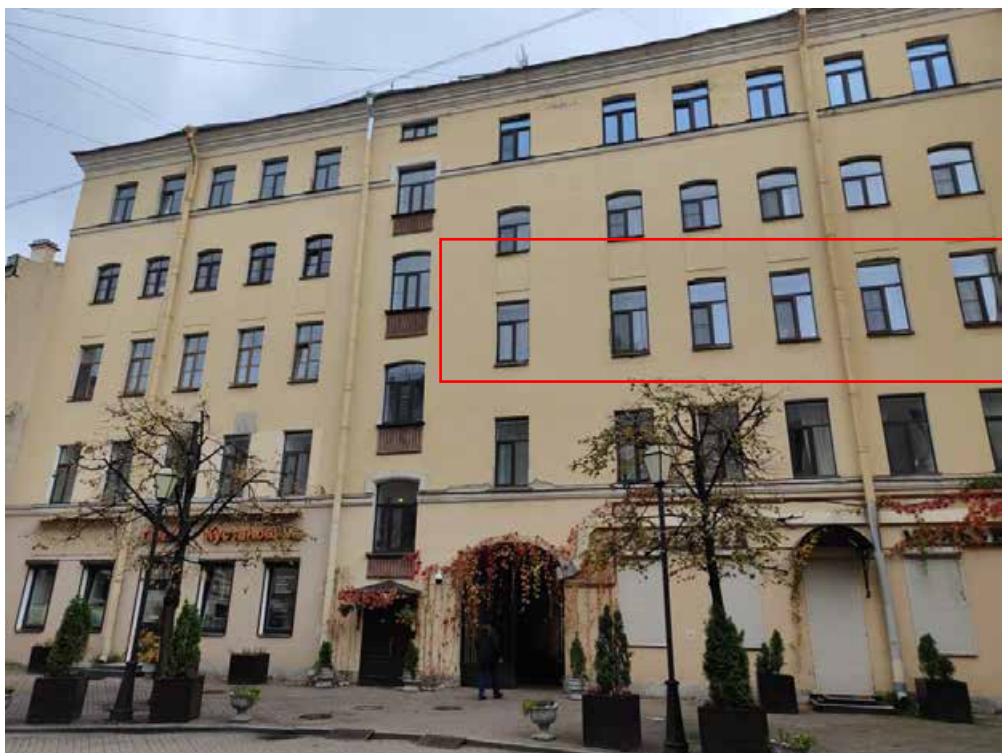
Фото 3. Фрагмент дворового фасада объекта культурного наследия федерального значения «Корпус квартирный с флигелями, входящего в состав объекта культурного наследия федерального значения «Капелла Придворная певческая»
