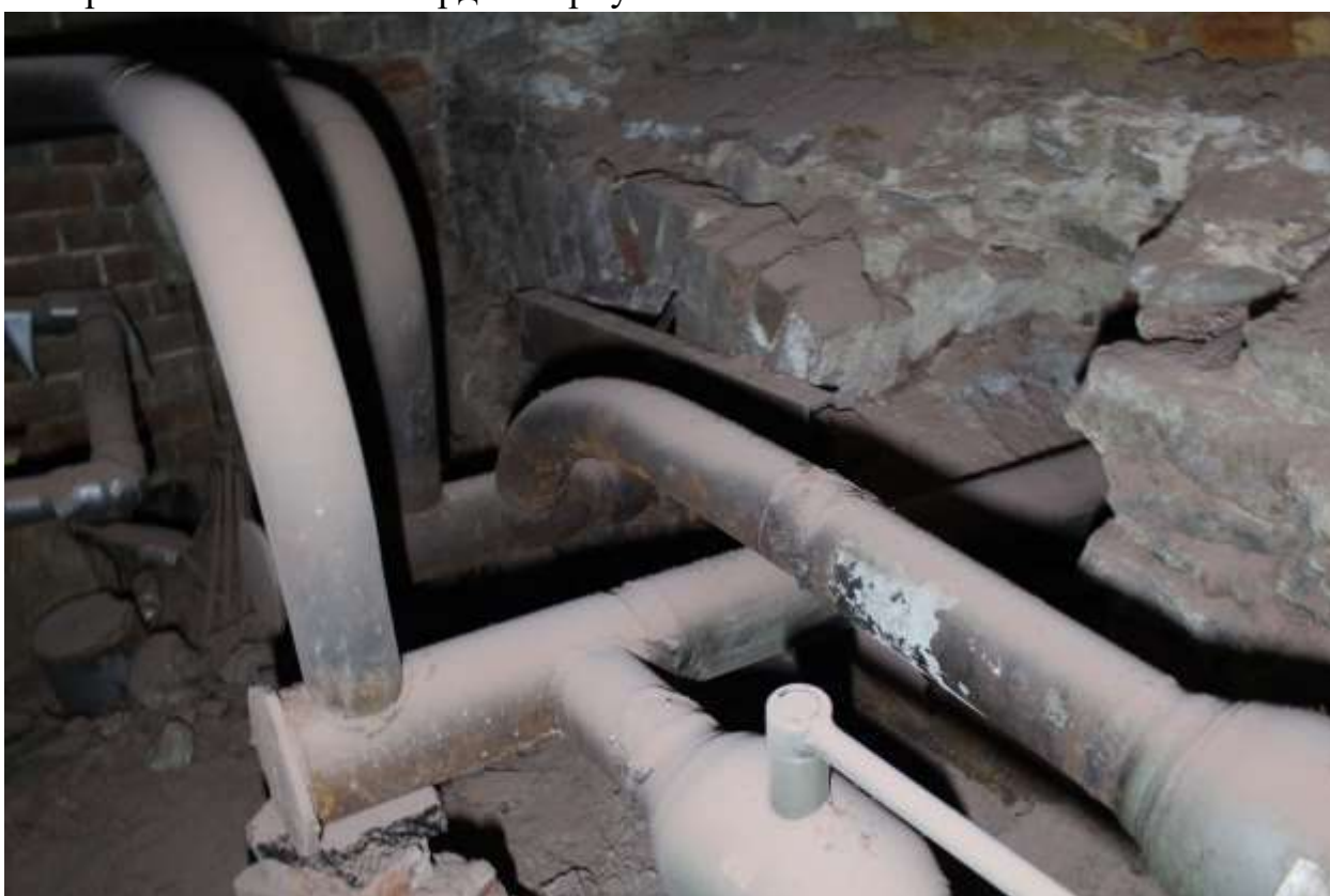
70. Выявленный объект культурного наследия «Дом Г.А. Хаймовича (при фабрике жестяных изделий)». Вид на ввод теплосети в подвале четырехэтажного с мансардой корпуса.
