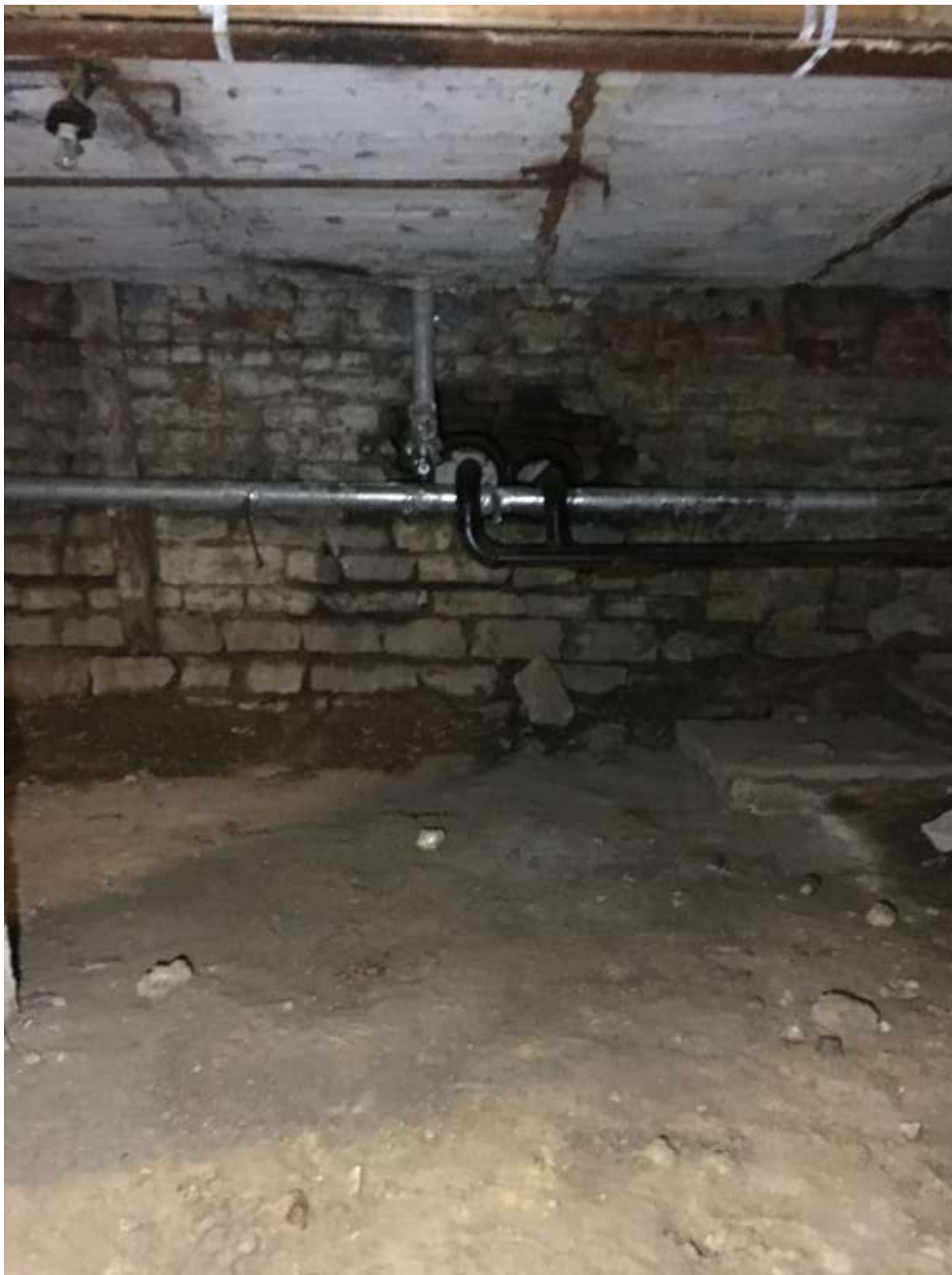
77. Выявленный объект культурного наследия «Богдельня для женщин». Вид на ввод теплосети в подвальном помещении.
