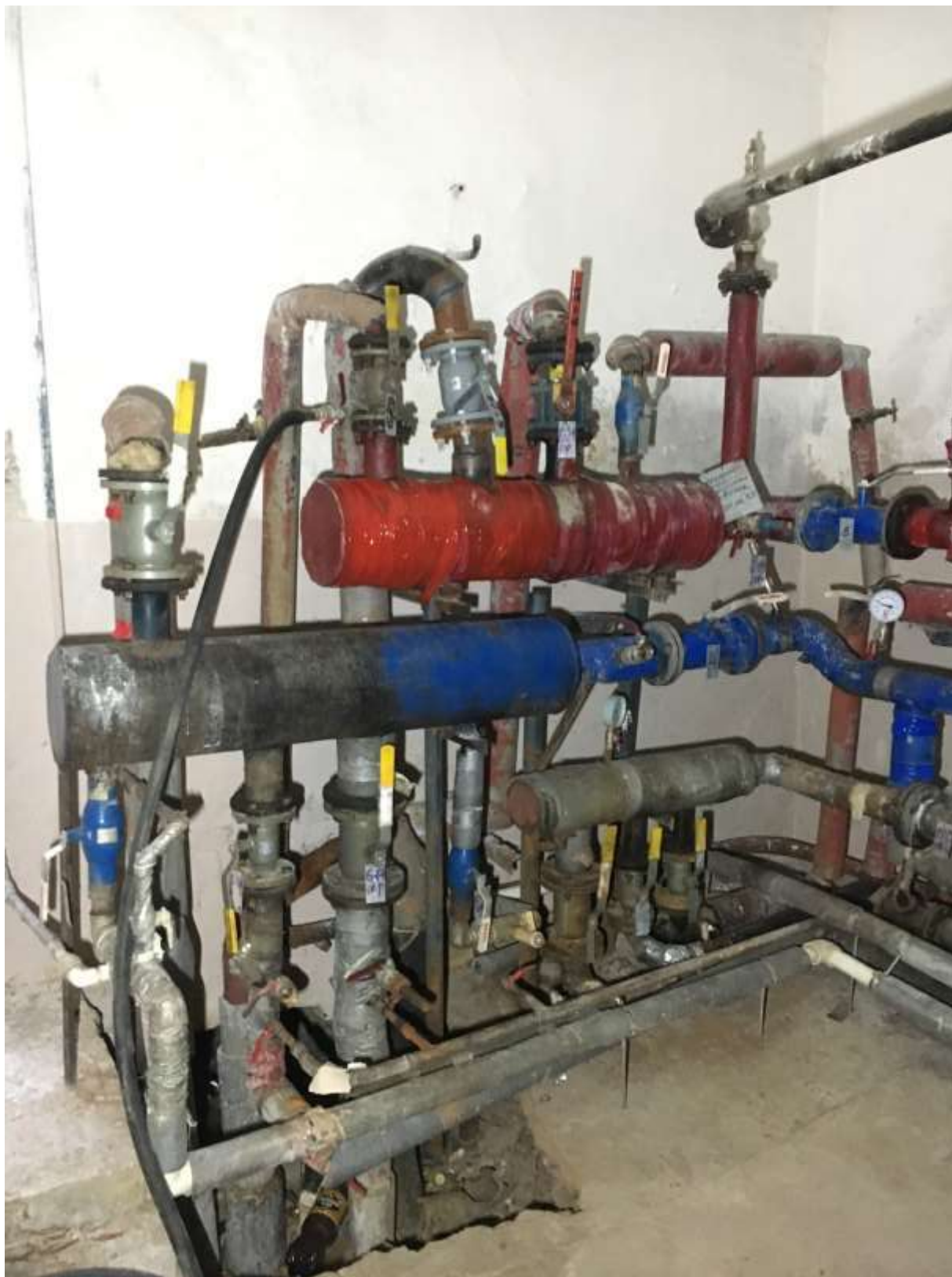
8. Выявленный объект культурного наследия «Дом В.И. Миллера». Помещение теплоцентра.
