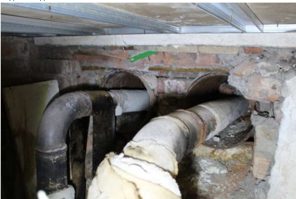
51. Выявленный объект культурного наследия «Городской дом 1-го Василеостровского начального народного училища». Подвальное помещение, вид на ввод теплосети.
