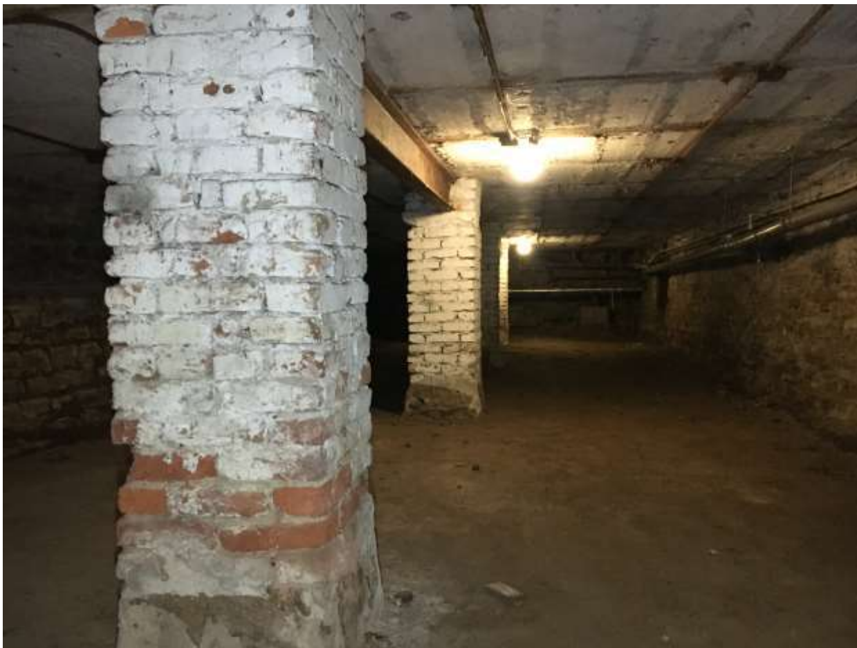
75. Выявленный объект культурного наследия «Богдельня для женщин». Вид на подвальное помещение.
