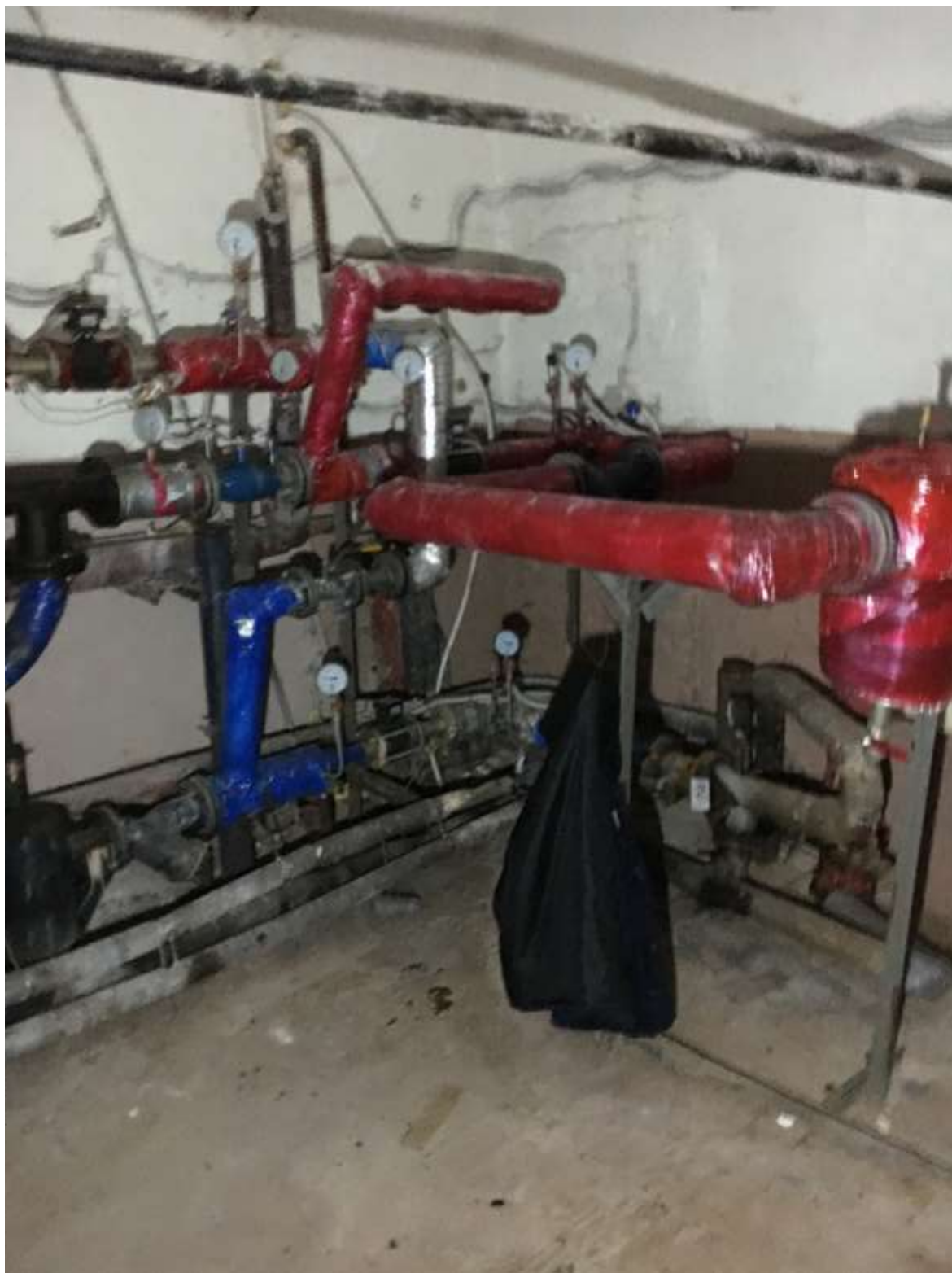
10. Выявленный объект культурного наследия «Дом В.И. Миллера». Помещение теплоцентра.
