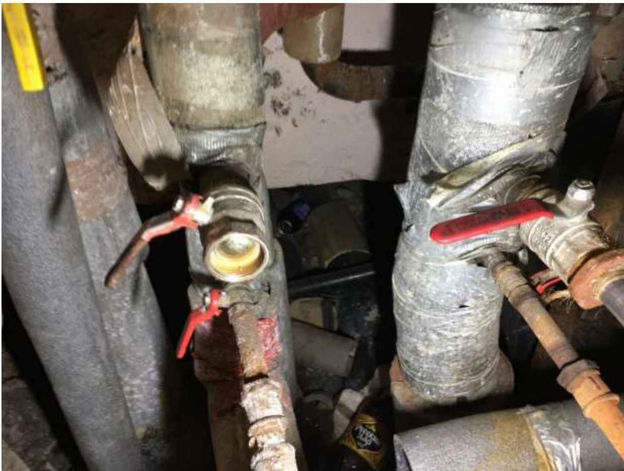
9. Помещение Выявленный объект культурного наследия «Дом В.И. Миллера». Помещение теплоцентра, вид на ввод теплосети.
