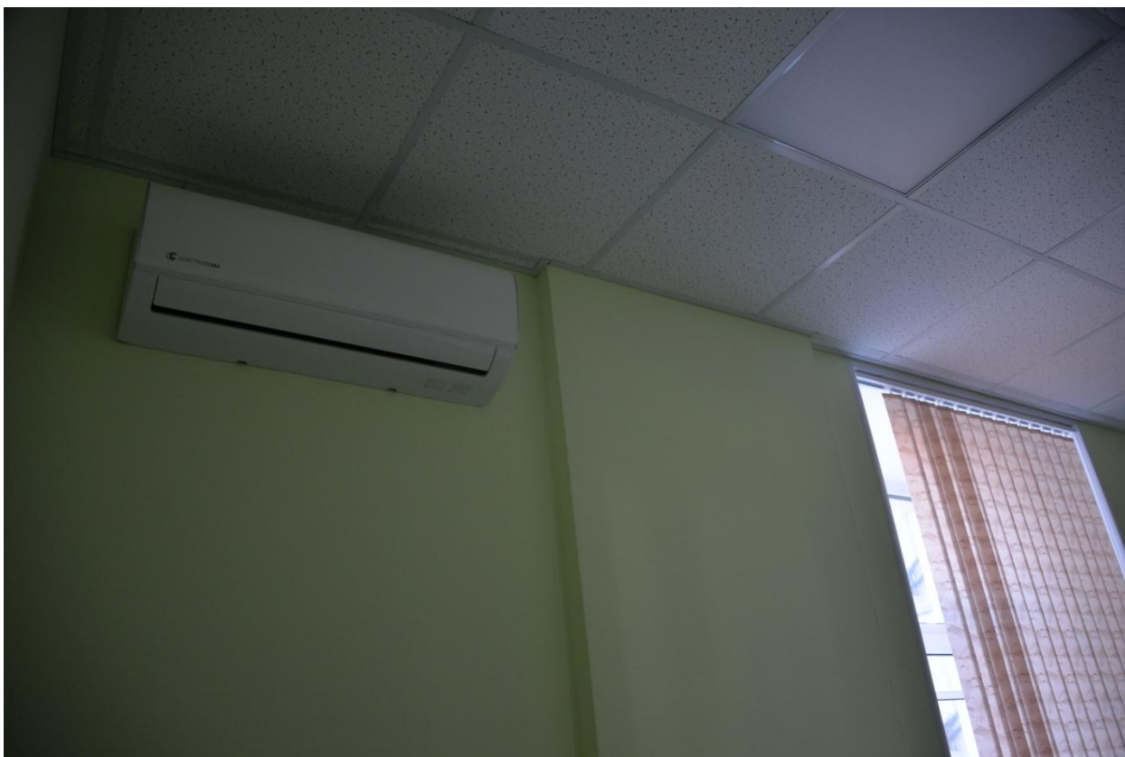
13. Кондиционер в помещении 2-Н (часть помещения №23) на втором этаже
