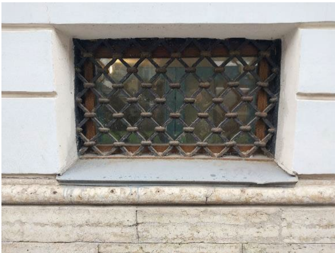
17. Юго-восточный лицевой фасад объекта культурного наследия федерального значения «Дом Демидова П.Н. (Гагариной В.Ф.)», расположенного по адресу: г. Санкт-Петербург, Большая Морская ул., д. 45, литера А. Фрагмент. 02.10.2024
