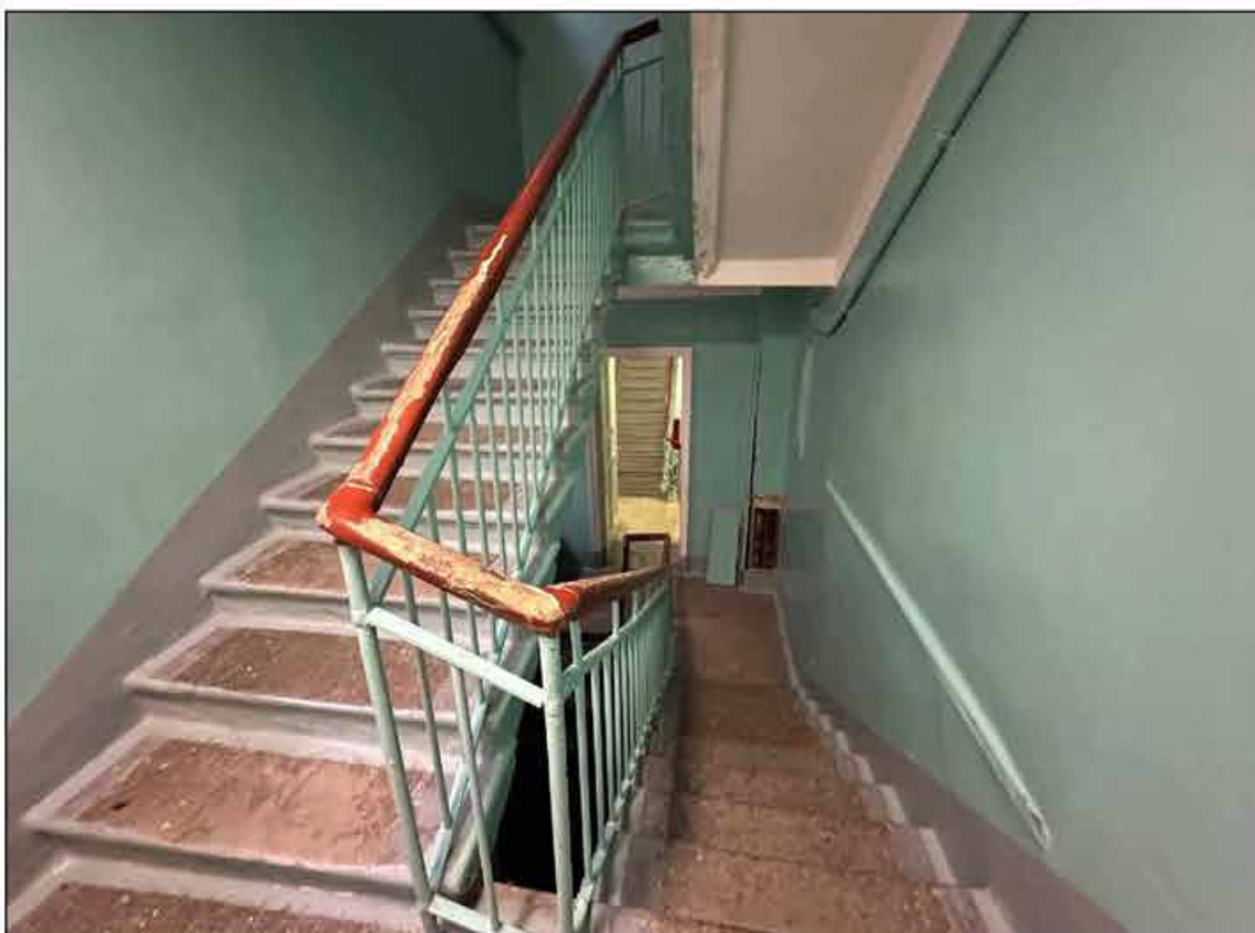
50. Объект культурного наследия федерального значения «Музей сельскохозяйственный». 2-й этаж, лестница 6-ЛК (помещение № 2). Вход в помещение № 128 (45-Н). 09.09.2024 г.
