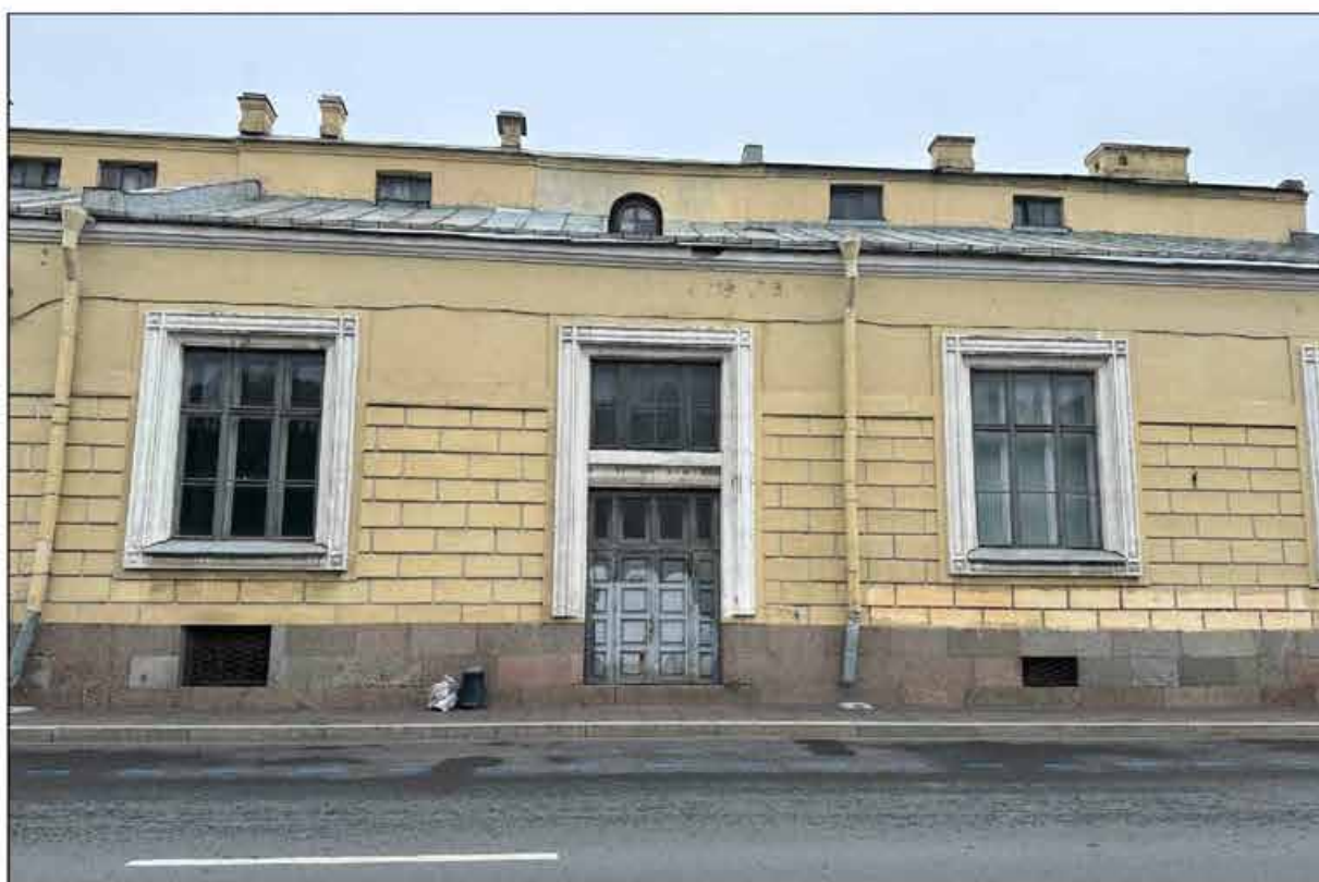
5. Объект культурного наследия федерального значения «Музей сельскохозяйственный». Лицевой фасад лицевого корпуса по набережной реки Фонтанки. Дверной проем с прямоугольной фрамугой. 09.09.2024 г.
