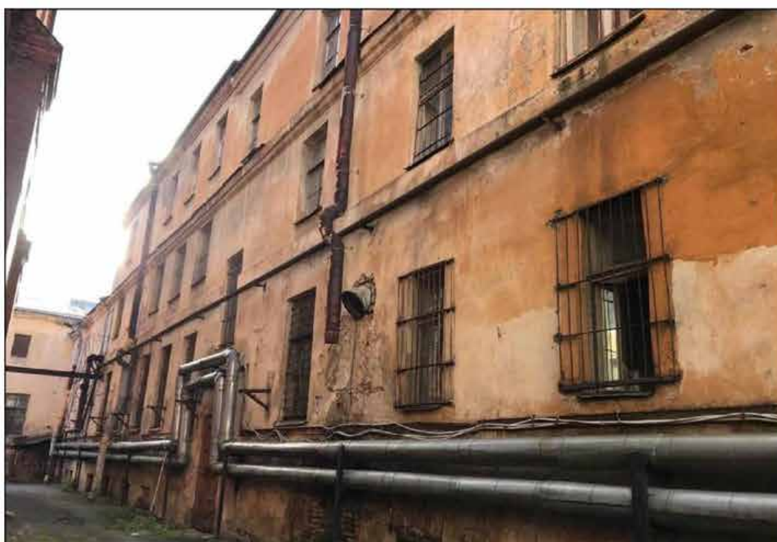
7. Объект культурного наследия федерального значения «Музей сельскохозяйственный». Южная часть дворового фасада лицевого корпуса по набережной реки Фонтанки. Дверной проем лестницы 6ЛК. Вид на юго-запад. 09.09.2024 г.
