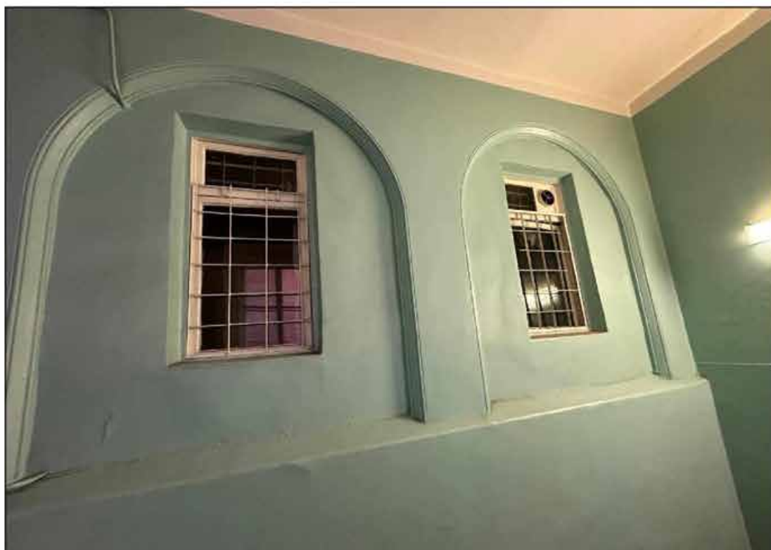
47. Объект культурного наследия федерального значения «Музей сельскохозяйственный». 2-й этаж, двухмаршевая лестница (помещение № 128 (45-Н)). Оконные проемы в помещении № 129 (45-Н). 09.09.2024 г.
