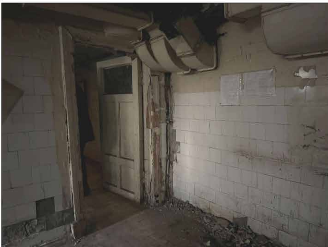
112. Объект культурного наследия федерального значения «Музей сельскохозяйственный». Подвал, помещение № 219 (45-Н). Вход в помещение № 220 (45-Н). 09.09.2024 г.
