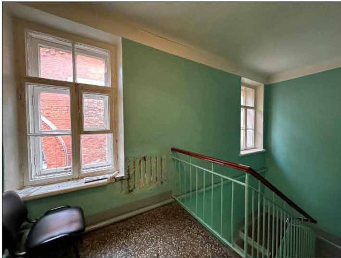
69. Объект культурного наследия федерального значения «Музей сельскохозяйственный». 3-й этаж, лестница 6-ЛК (помещение № 3). Оконные проемы. 09.09.2024 г.
