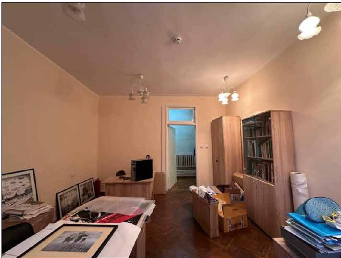
83. Объект культурного наследия федерального значения «Музей сельскохозяйственный». 3-й этаж, помещение № 7 (52-Н). Выход в коридор (помещение № 9 (52-Н)). 09.09.2024 г.
