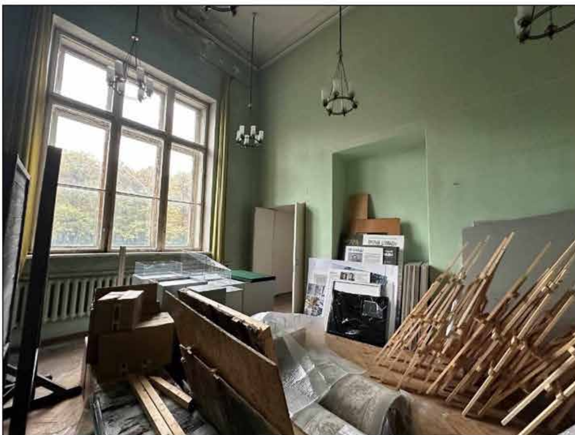
32. Объект культурного наследия федерального значения «Музей сельскохозяйственный». 1-й этаж, помещение № 53 (45-Н). Ниша. 09.09.2024 г.
