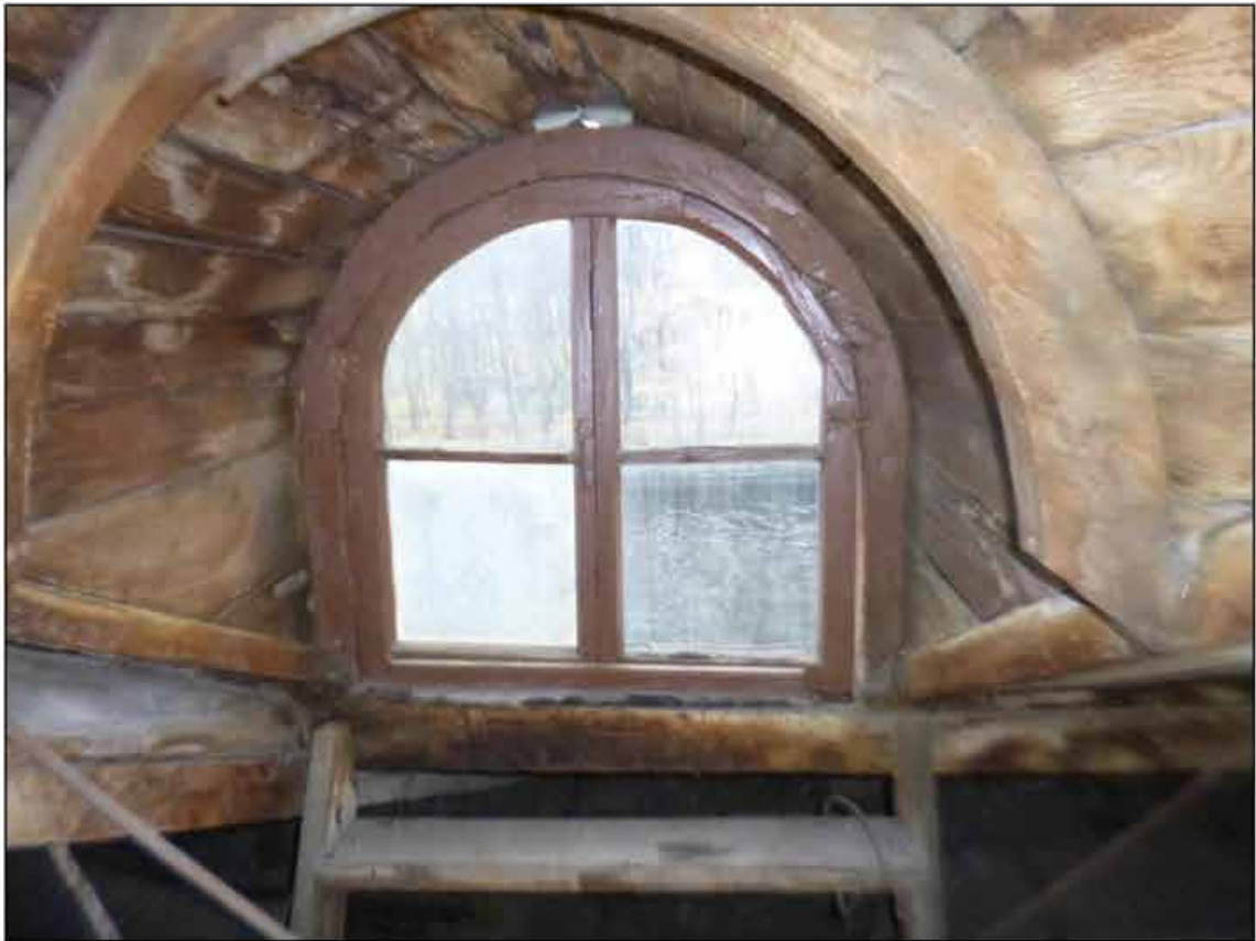
126. Объект культурного наследия федерального значения «Музей сельскохозяйственный». Чердак. Слуховое окно в осях 1-2/А-Б. 09.09.2024 г.
