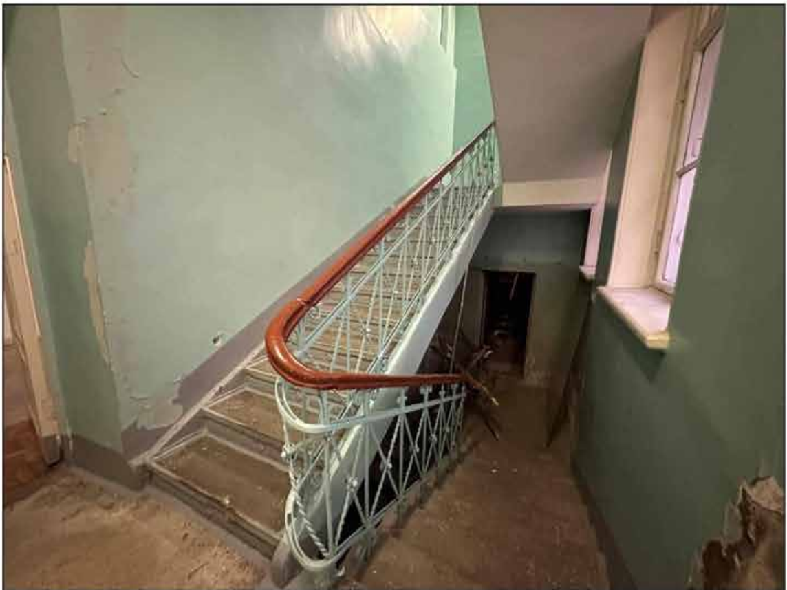
17. Объект культурного наследия федерального значения «Музей сельскохозяйственный». 1-й этаж, двухмаршевая лестница (помещение № 51(45-Н)). Лестничный марш в подвал. 09.09.2024г.
