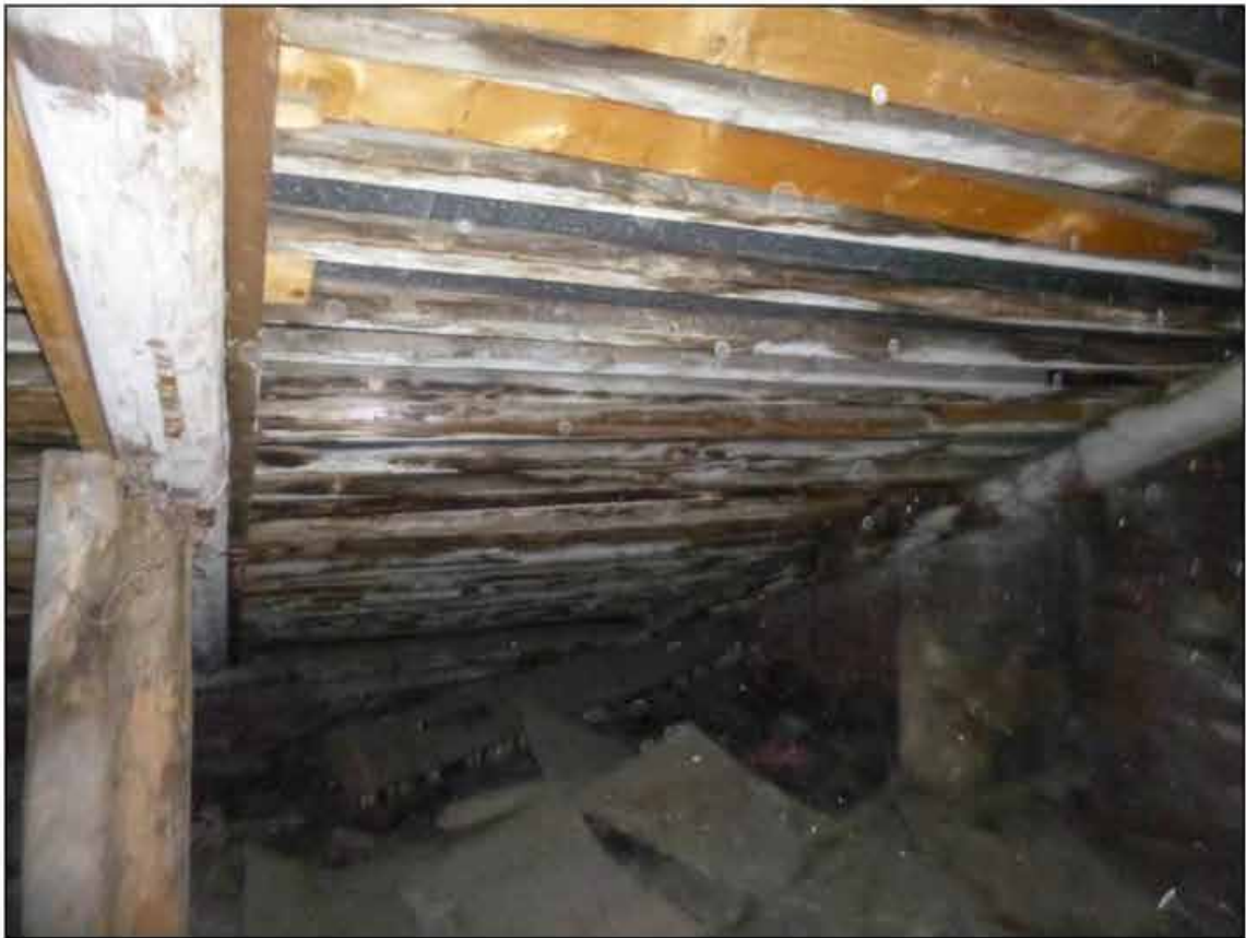
135. Объект культурного наследия федерального значения «Музей сельскохозяйственный». Чердак в осях 3-4/В. 09.09.2024 г.
