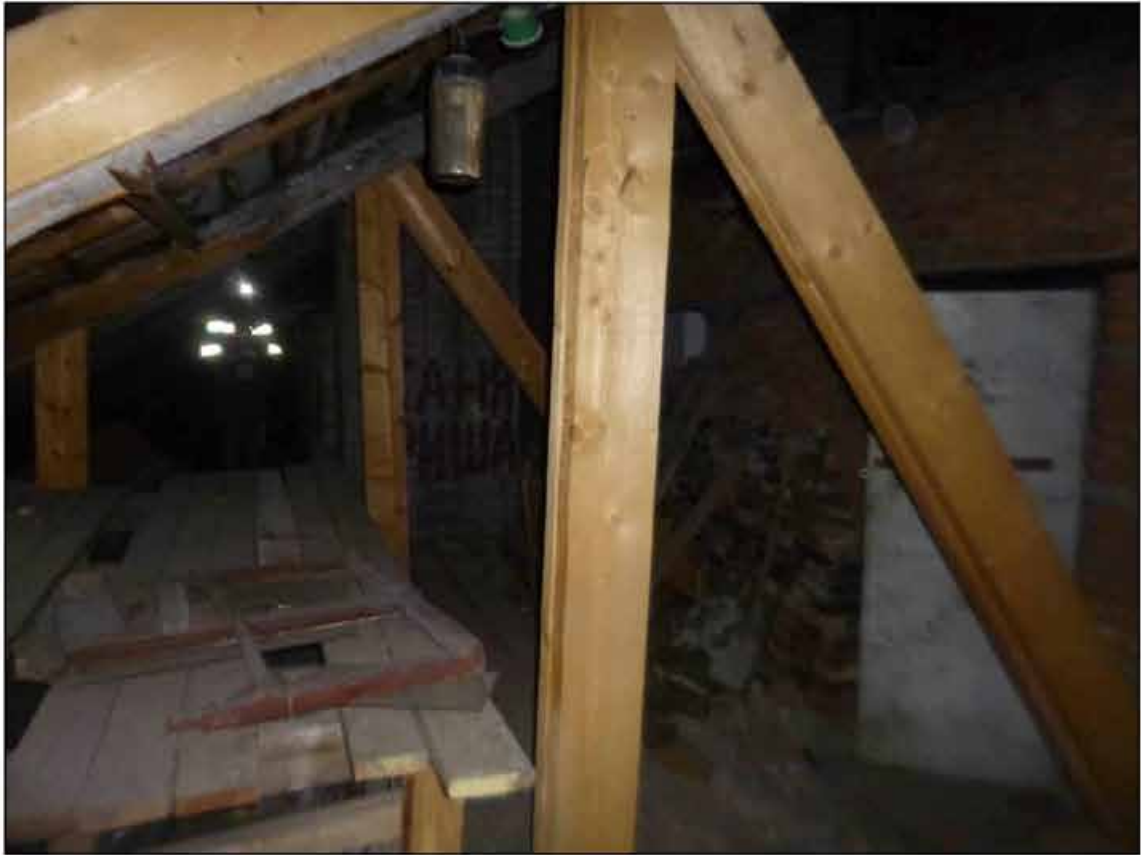
124. Объект культурного наследия федерального значения «Музей сельскохозяйственный». Чердак. Усиление стропильной системы в осях 3-4/А-Б. 09.09.2024 г.
