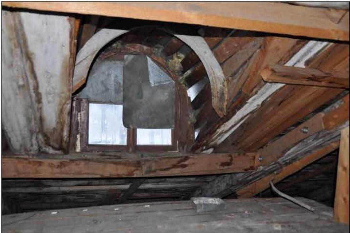
125. Объект культурного наследия федерального значения «Музей сельскохозяйственный». Чердак. Слуховое окно в осях 3-4/А-Б. 09.09.2024 г.
