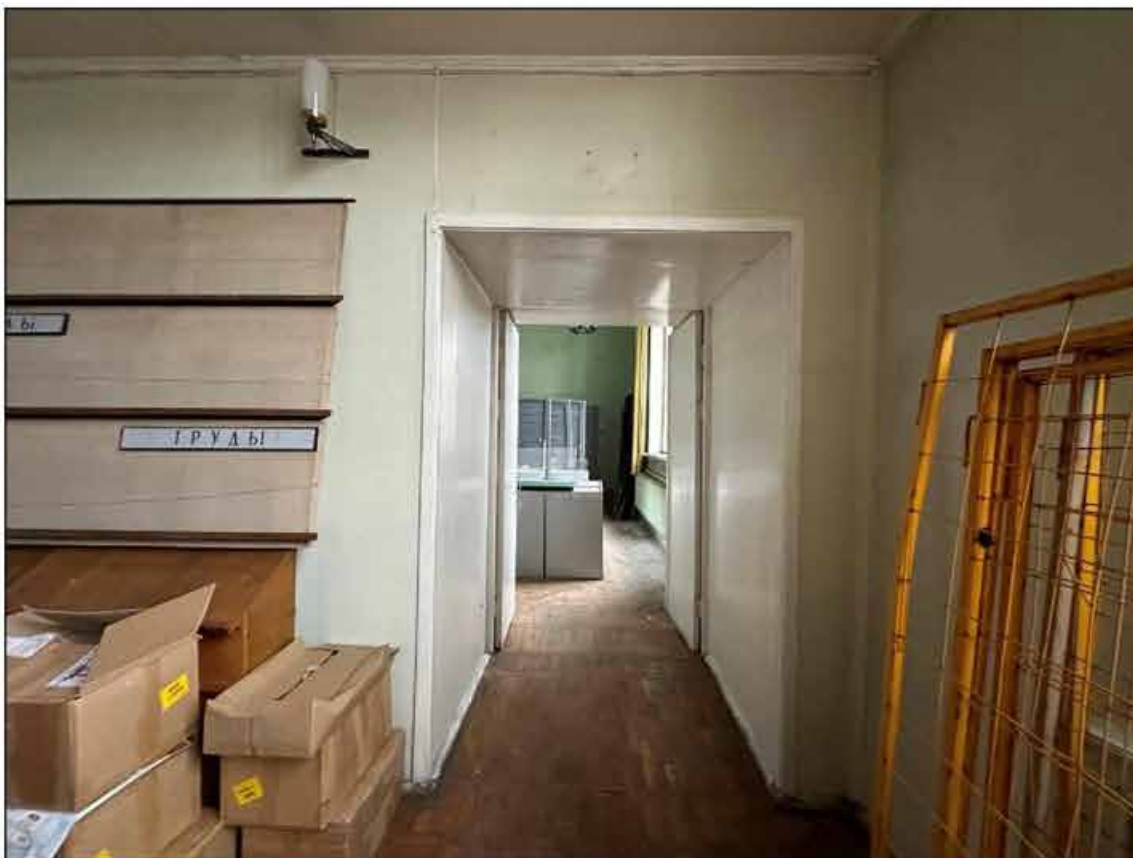
29. Объект культурного наследия федерального значения «Музей сельскохозяйственный». 1-й этаж, помещение № 54 (45-Н). Вход в помещение № 53. 09.09.2024 г.
