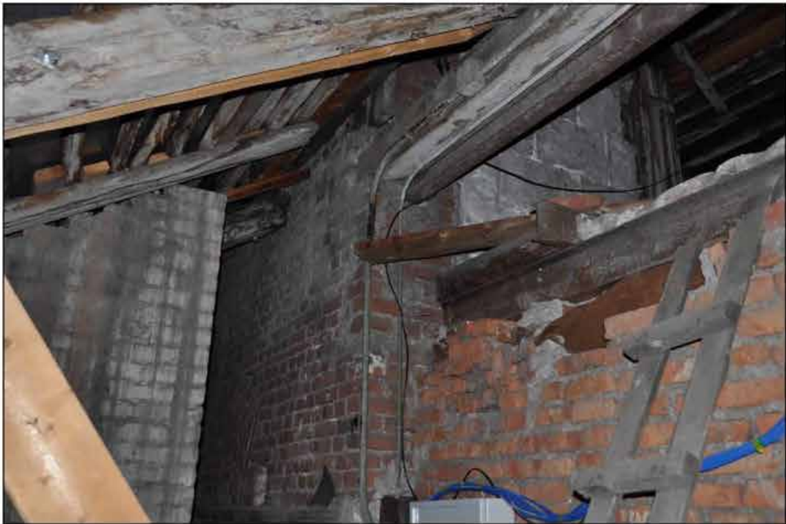
123. Объект культурного наследия федерального значения «Музей сельскохозяйственный». Чердак. Капитальная стена в осях 3-4/Б. 09.09.2024 г.
