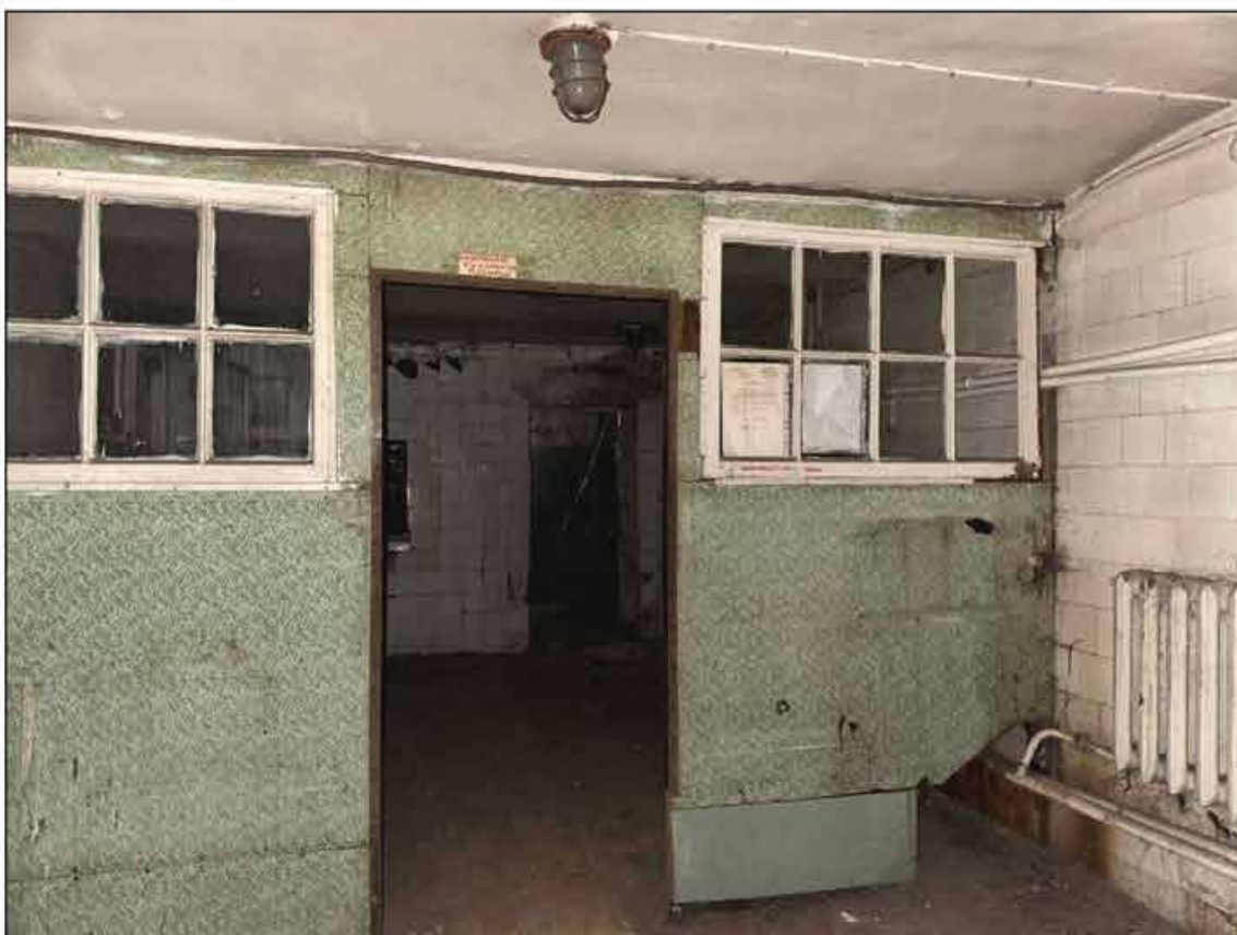
110. Объект культурного наследия федерального значения «Музей сельскохозяйственный». Подвал, помещения №№ 216 и 218 (45-Н). 09.09.2024 г.
