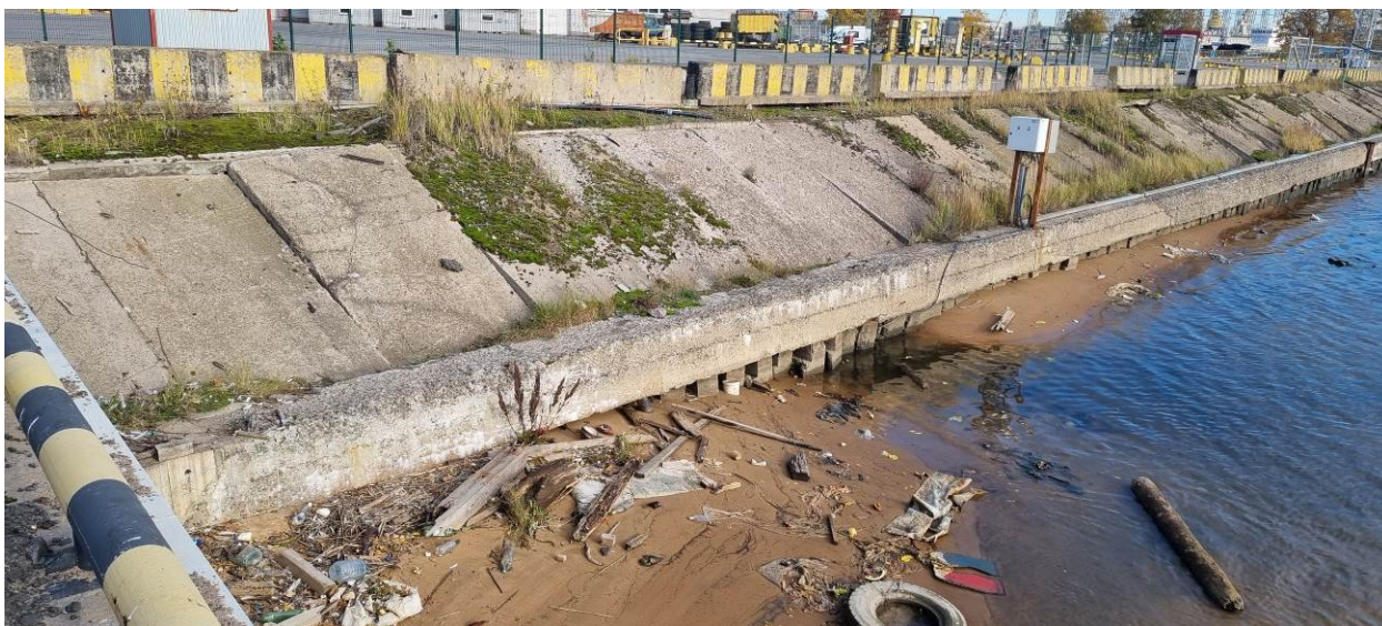
Рис. 80. Угольная гавань-2024. Точка фотофиксации 35. Конструкции берегоукрепления восточного берега Малой Турухтанной гавани. Вид с СЗ
