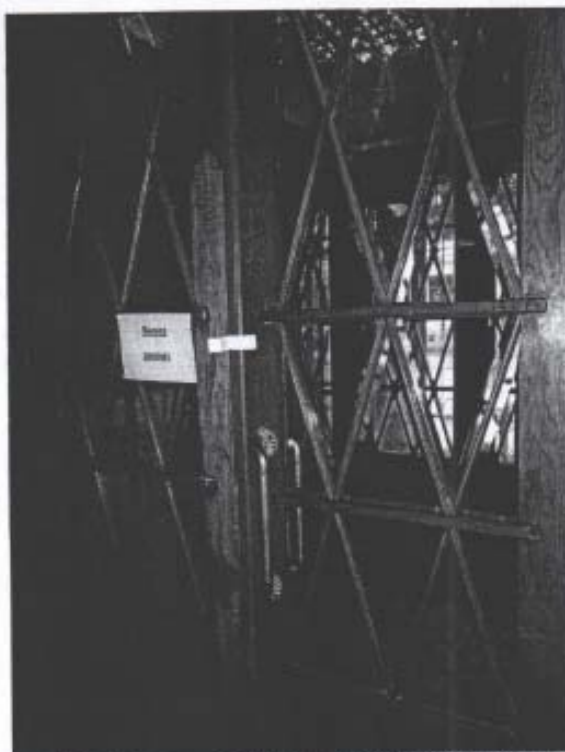
Входной тамбур пом. 9-Н. Съемка 17.07.2012. В.Ю. Белая
