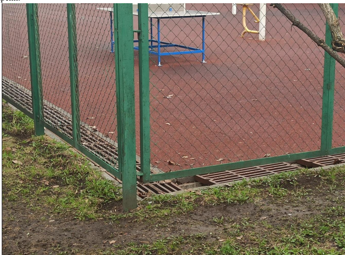
Фото 10. Вид на закрытый бетонный лоток с решеткой по периметру спортивных площадок, местами решетка утрачена.
