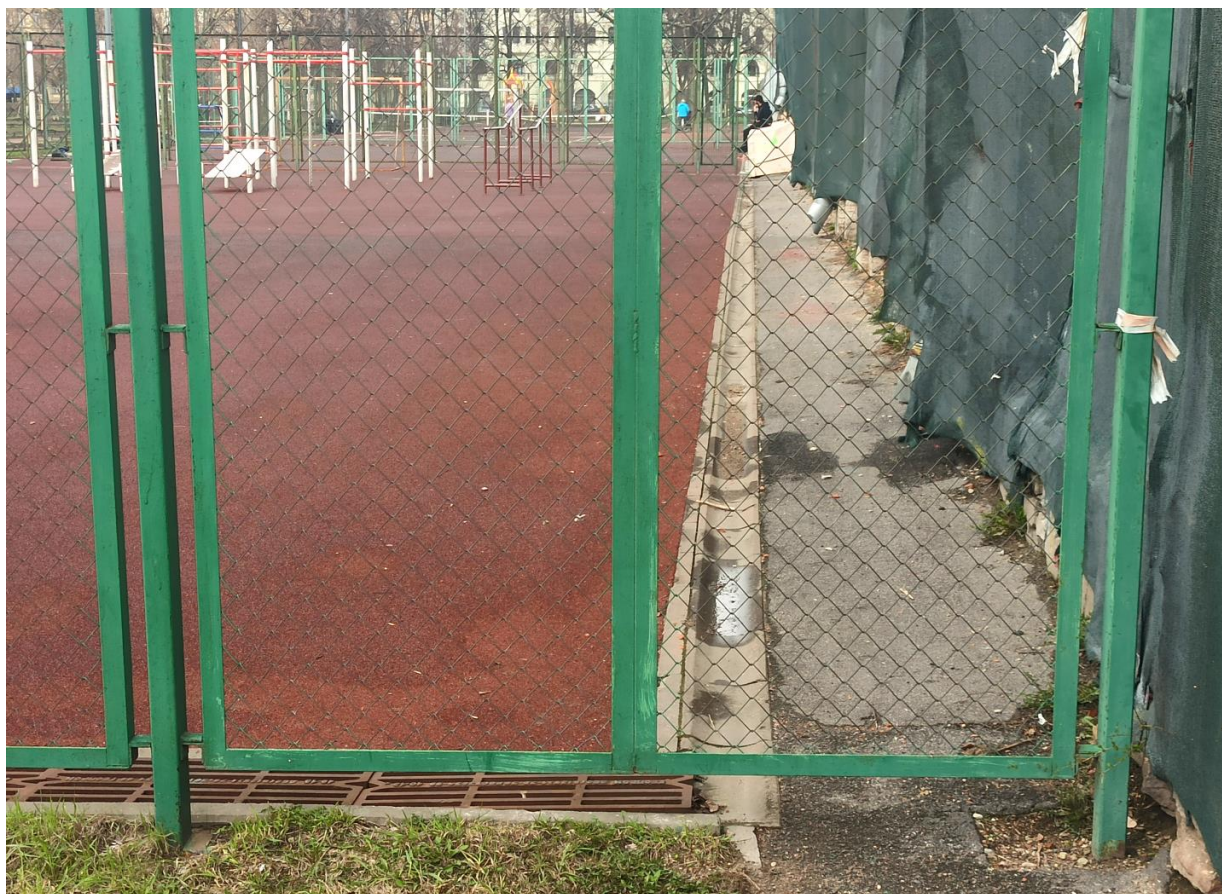
Фото 7. Вид на существующую систему поверхностного водоотвода от стен здания и со спортивной площадки в виде открытого бетонного лотка по краю отмостки и далее в закрытый бетонный лоток с решеткой.
