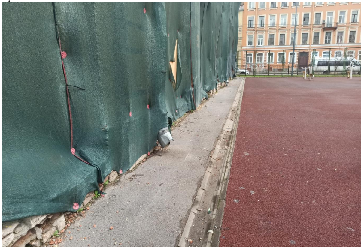
Фото 16. Вид на территорию сквера вдоль здания Мытного двора, вдоль фасада устроена асфальтобетонная отмостка, на которую по существующим ливневодам осуществляется водослив в крыши и далее в бетонный лоток, по лотку вода уходит в систему ливневой канализации на территории сквера.
