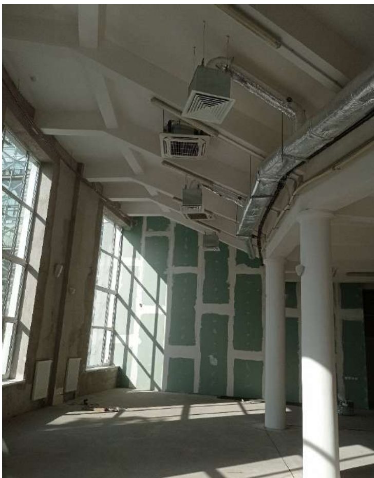
30. ОКНРЗ «Дворец пушнины». Фрагмент помещения под аукционным залом. Элементы конструктивной системы здания – колонны и пилоны. Вид на запад. Дата съемки 18.09.2024.
