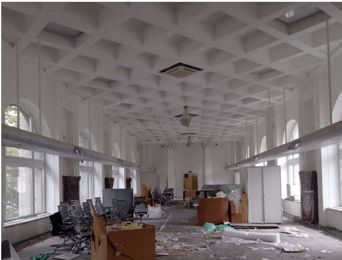
39. ОКНРЗ «Дворец пушнины». Оформление потолка – глубокие кессоны. Ниши в межоконных простенках в профилированных наличниках с деревянными радиаторными решетками сложного рисунка (ромбовидная сетка). Вид на север. Дата съемки 18.09.2024.
