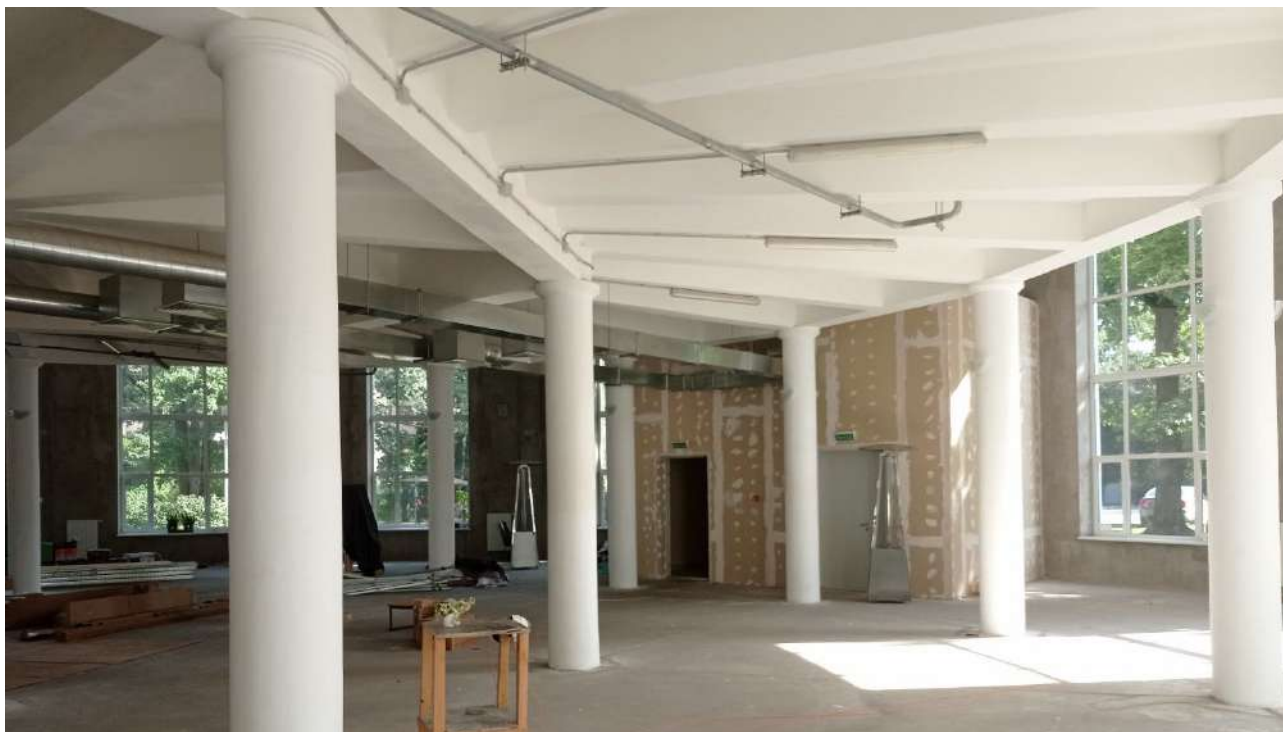
21. ОКНРЗ «Дворец пушнины». Фрагмент помещения под аукционным залом. Элементы конструктивной системы здания – колонны и пилоны. Вид на северо-восток. Дата съемки 18.09.2024.
