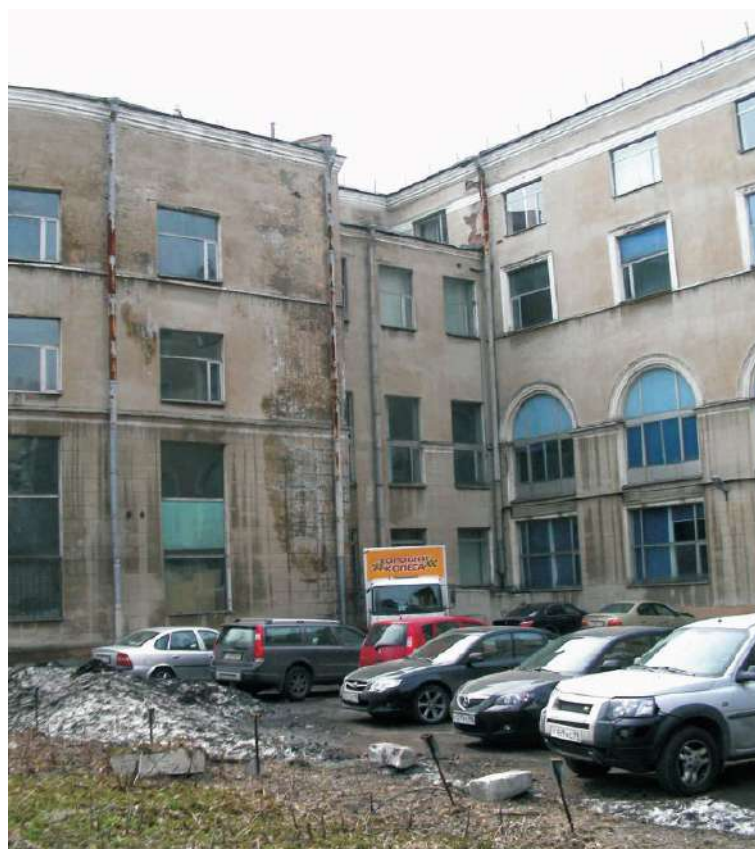
100. Дворовый фасад. Вид на примыкание аукционного зала к объему холлов. Фрагмент северного крыла. 2010г. ООО «БРК».
