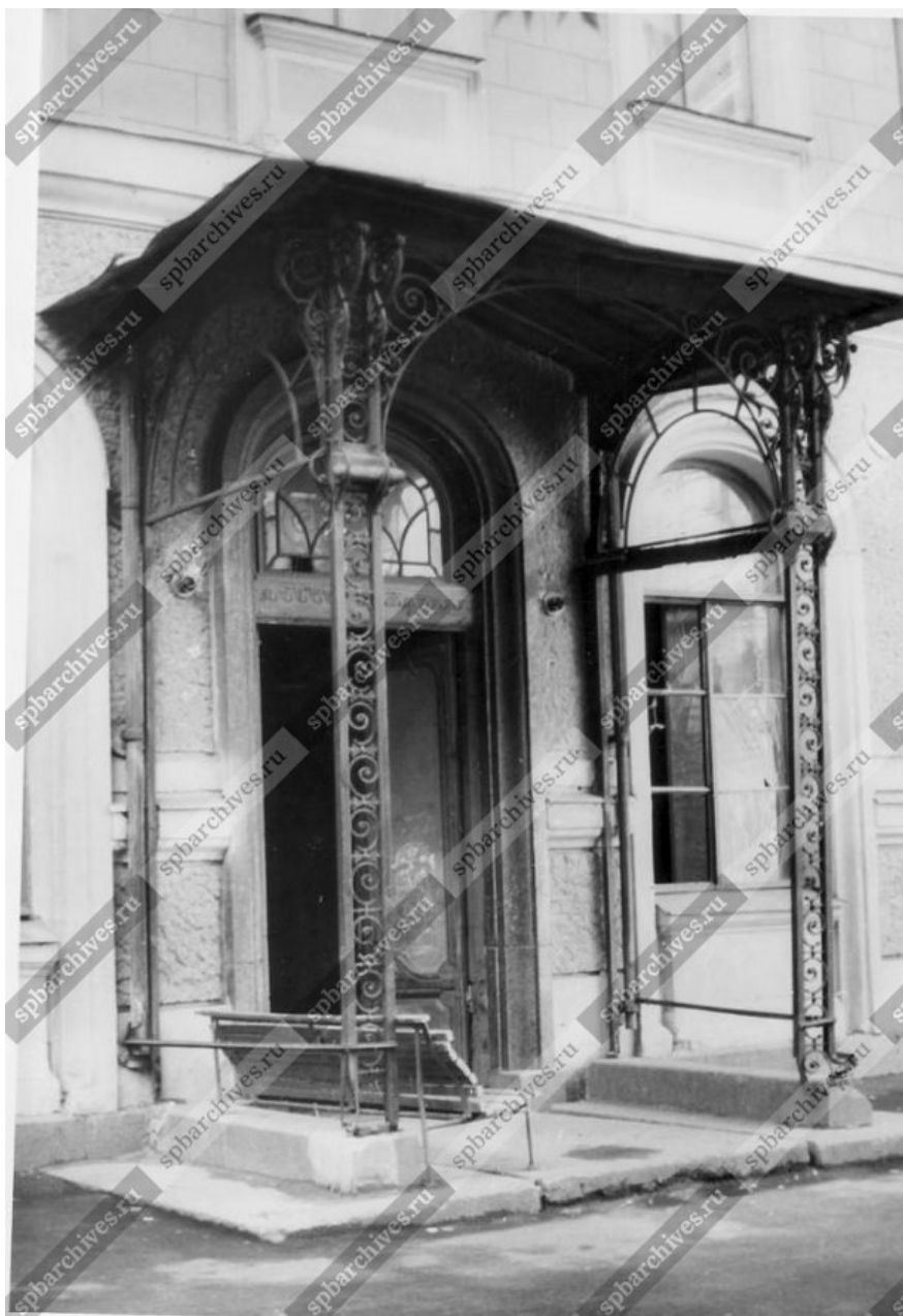
Илл. 46. Вид навеса парадного входа со стороны двора-курдонера жилого дома № 27-29 на Моховой улице (бывший жилой дом страхового общества «Россия»). 1991 г. ЦГАКФФД СПб. Ар 230703.
