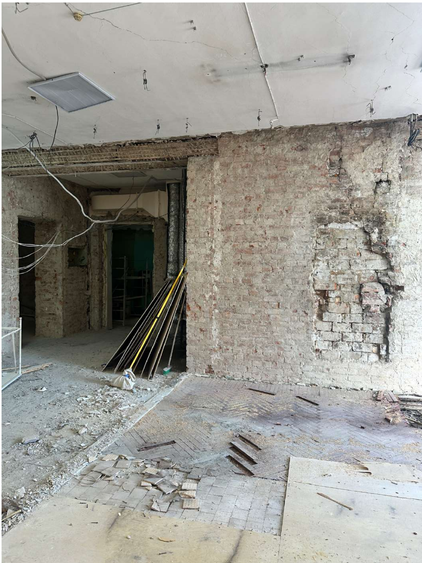
Фото 10. Общий вид 1-го этажа в зоне проектирования. Пом. № 22 по плану ПИБ. Дата фотофиксации - 28.09.2024г.
