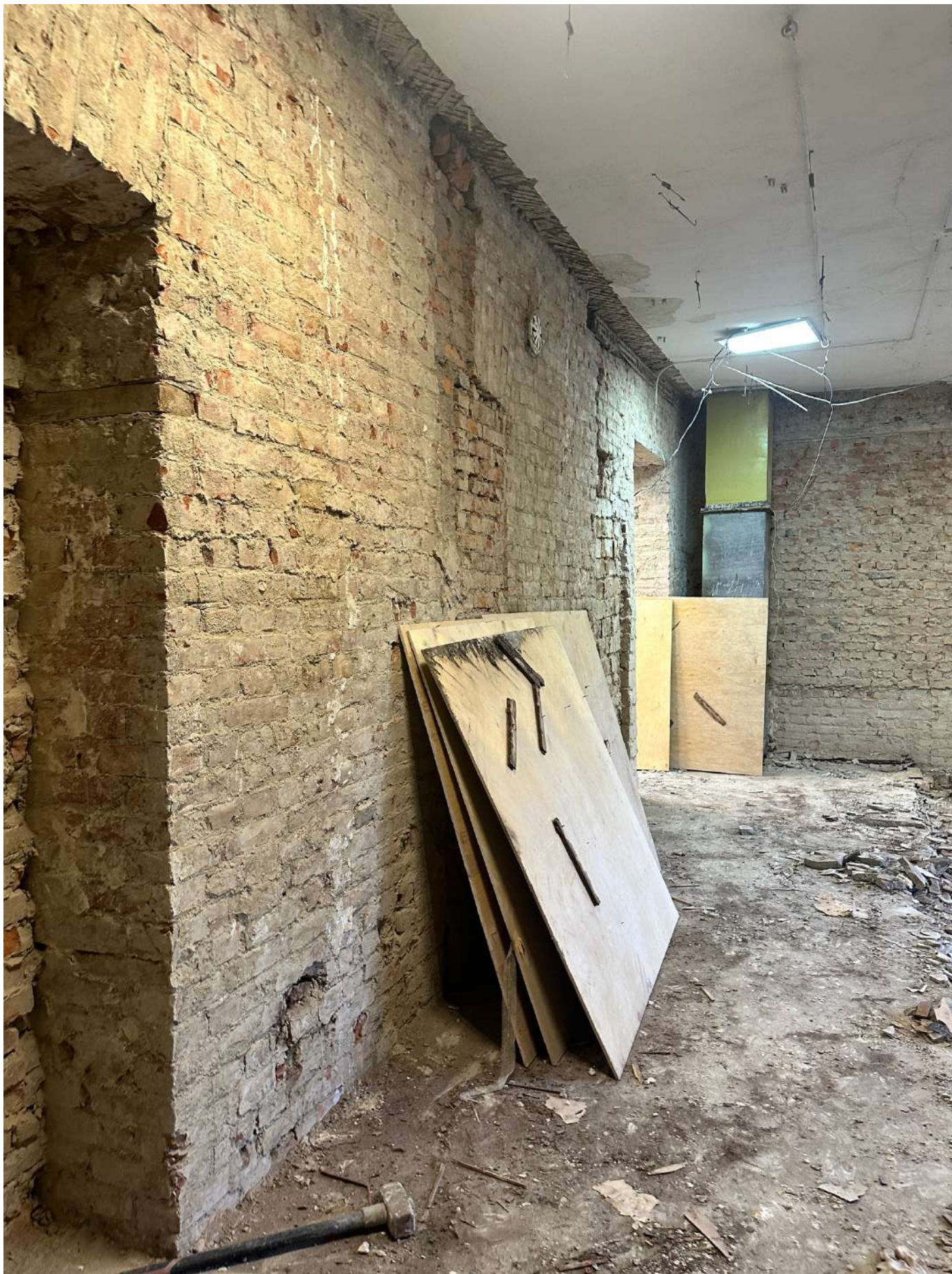
Фото 6. Общий вид 1-го этажа в зоне проектирования. Пом. № 23 по плану ПИБ. Дата фотофиксации - 28.09.2024г.
