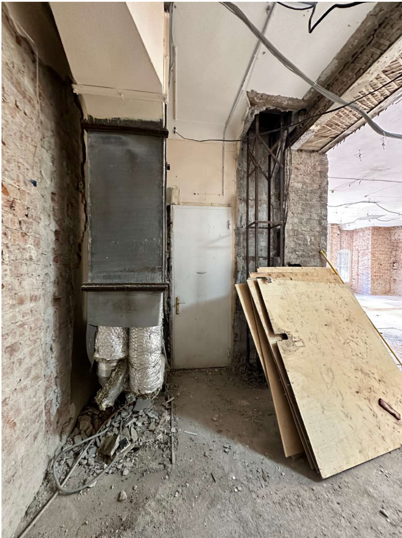
Фото 9. Общий вид 1-го этажа в зоне проектирования. Пом. № 20 по плану ПИБ. Дата фотофиксации - 28.09.2024г.
