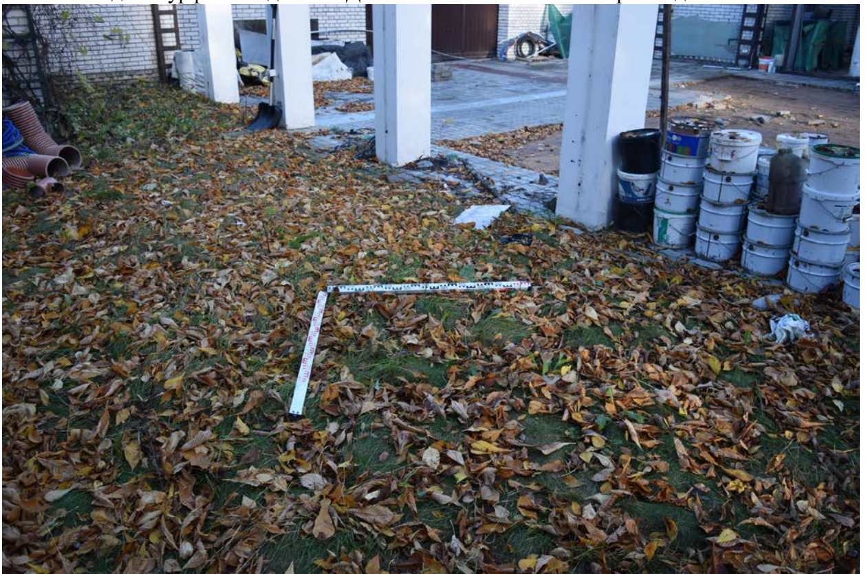
Илл. 37. Санкт-Петербург, Поклонногорская улица, земельный участок 48а. Разметка шурфа 1. Вид с юга. Для масштаба использована рейка длиной 2 м.
