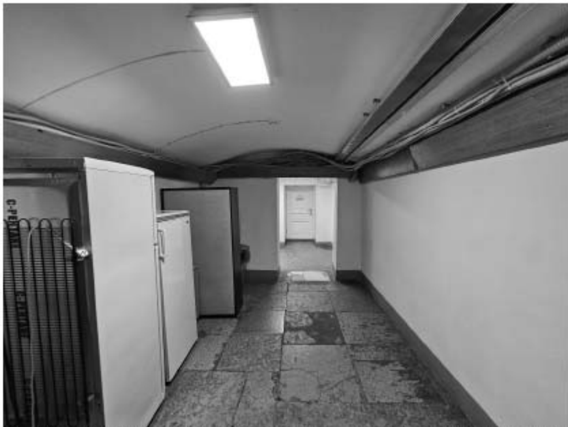
79. Объект культурного наследия федерального значения «Дворец», в составе объекта культурного наследия федерального значения «Дворец Маринский», по адресу: г. Санкт-Петербург, Исаакиевская пл., д. 6, лит. А. Общий вид пом. 15-Н (56) в уровне антресоли.
