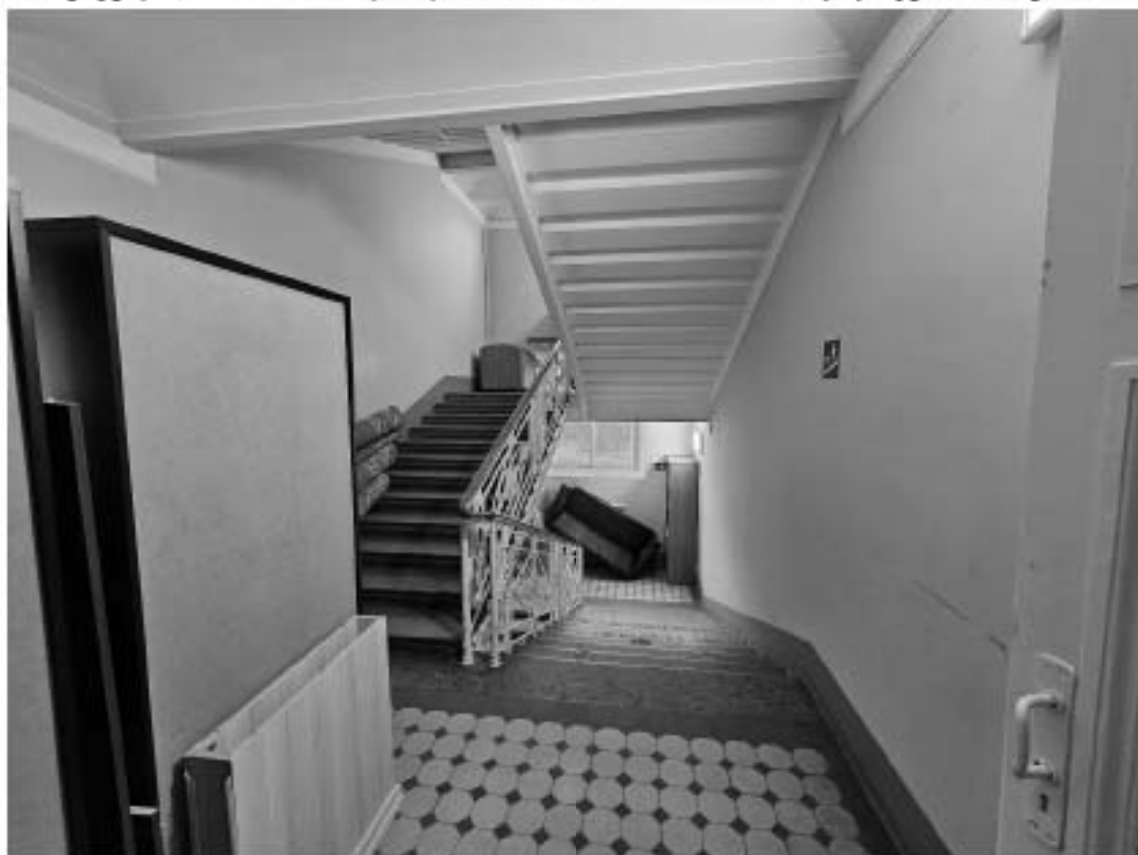
86. Объект культурного наследия федерального значения «Дворец», в составе объекта культурного наследия федерального значения «Дворец Маринский», по адресу: г. Санкт-Петербург, Исаакиевская пл., д. 6, лит. А. Общий вид лестницы Л-8 в уровне антресоли.
