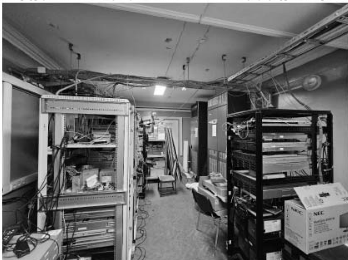
88. Объект культурного наследия федерального значения «Дворец», в составе объекта культурного наследия федерального значения «Дворец Маринский», по адресу: г. Санкт-Петербург, Исаакиевская пл., д. 6, лит. А. Общий вид пом. 15-Н (35) в уровне антресоли.
