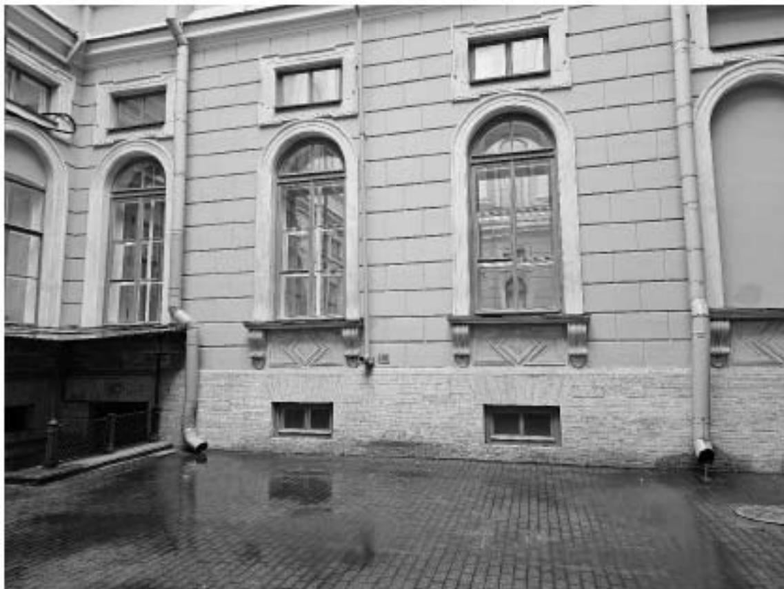
14. Объект культурного наследия федерального значения «Дворец», в составе объекта культурного наследия федерального значения «Дворец Маринский», по адресу: г. Санкт-Петербург, Исаакиевская пл., д. 6, лит. А. Фрагмент восточного дворового фасада северного двора.
