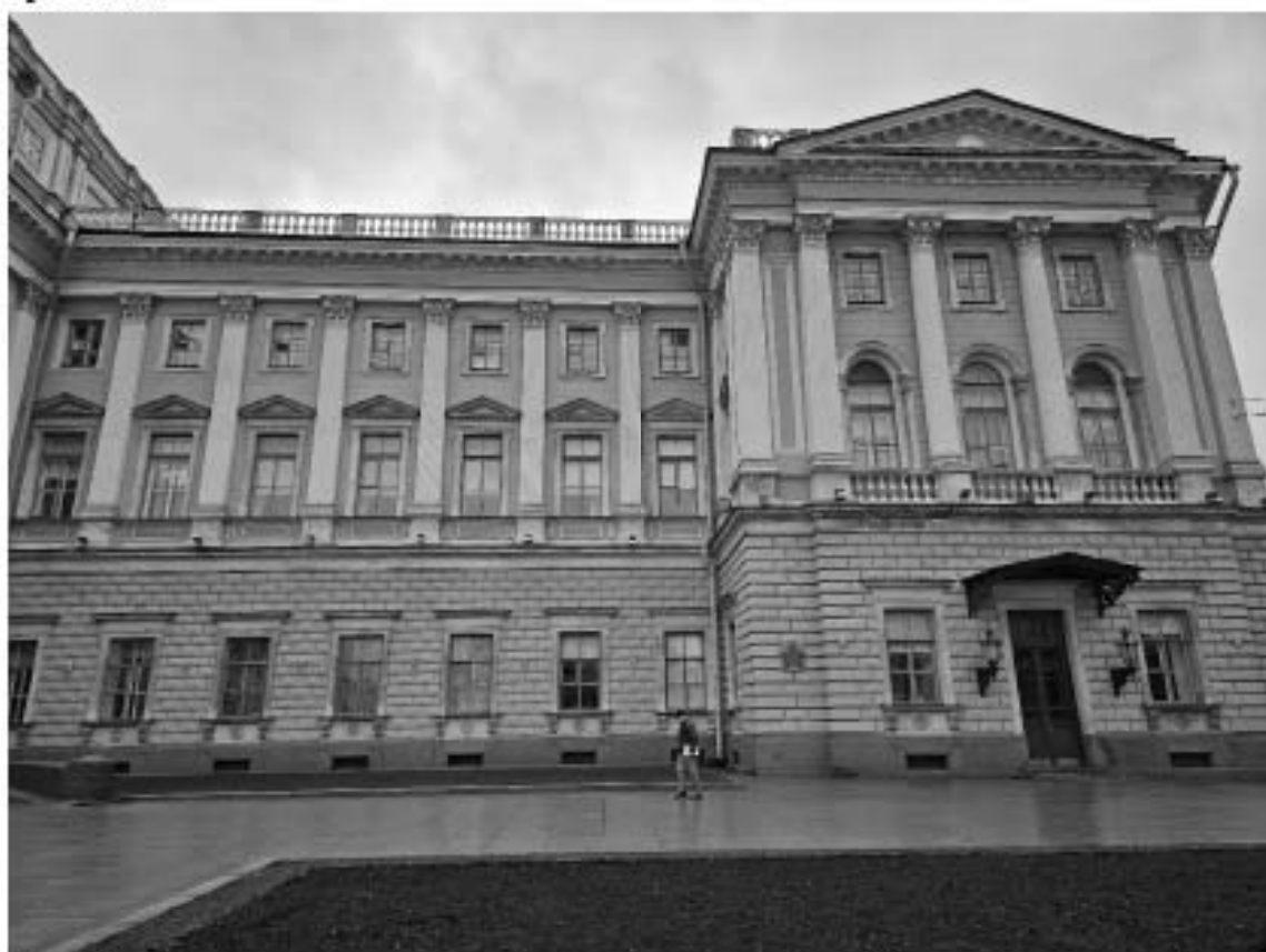
6. Объект культурного наследия федерального значения «Дворец», в составе объекта культурного наследия федерального значения «Дворец Маринский», по адресу: г. Санкт-Петербург, Исаакиевская пл., д. 6, лит. А. Западная часть северного лицевого фасада.
