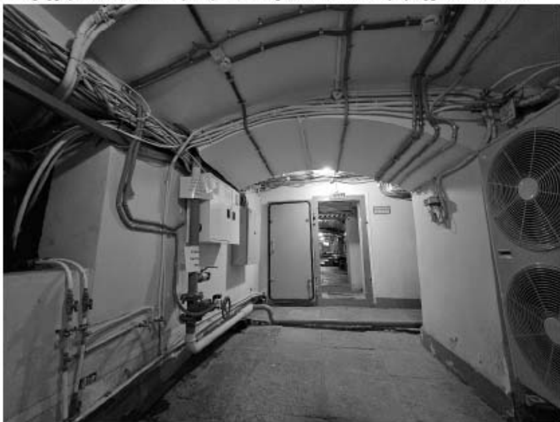
31. Объект культурного наследия федерального значения «Дворец», в составе объекта культурного наследия федерального значения «Дворец Маринский», по адресу: г. Санкт-Петербург, Исаакиевская пл., д. 6, лит. А. Общий вид пом. 8-Н (59) в уровне подвала.
