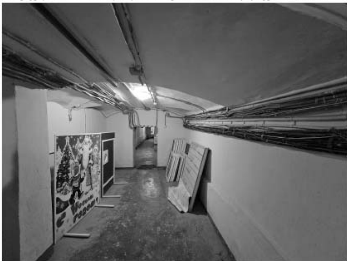
33. Объект культурного наследия федерального значения «Дворец», в составе объекта культурного наследия федерального значения «Дворец Маринский», по адресу: г. Санкт-Петербург, Исаакиевская пл., д. 6, лит. А. Общий вид пом. 8-Н (50) в уровне подвала.
