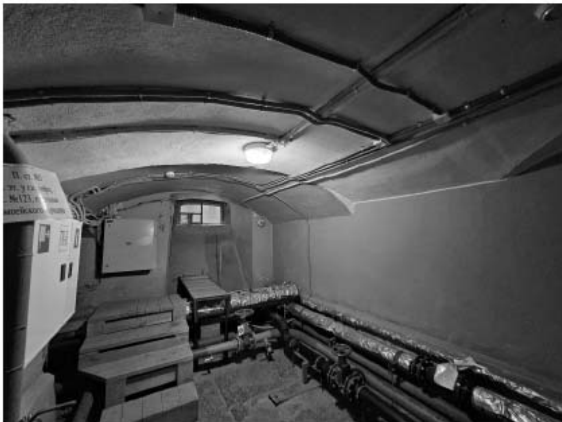
28. Объект культурного наследия федерального значения «Дворец», в составе объекта культурного наследия федерального значения «Дворец Маринский», по адресу: г. Санкт-Петербург, Исаакиевская пл., д. 6, лит. А. Фрагмент пом. 19-Н (44) в уровне подвала.
