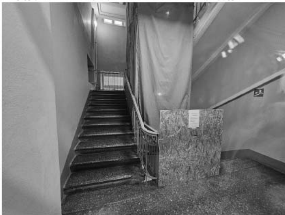
140. Объект культурного наследия федерального значения «Дворец», в составе объекта культурного наследия федерального значения «Дворец Маринский», по адресу: г. Санкт-Петербург, Исаакиевская пл., д. 6, лит. А. Общий вид лестницы Л-6 в уровне 3-го этажа.
