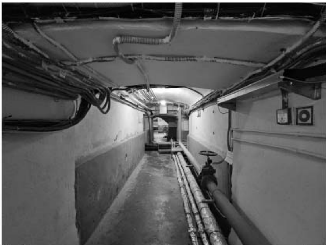
34. Объект культурного наследия федерального значения «Дворец», в составе объекта культурного наследия федерального значения «Дворец Марининский», по адресу: г. Санкт-Петербург, Исаакиевская пл., д. 6, лит. А. Общий вид пом. 8-Н (51) в уровне подвала.
