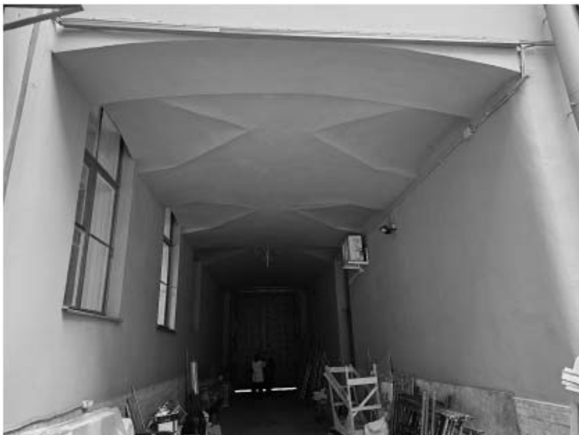
17. Объект культурного наследия федерального значения «Дворец», в составе объекта культурного наследия федерального значения «Дворец Маринский», по адресу: г. Санкт-Петербург, Исаакьевская пл., д. 6, лит. А. Общий вид воротного проезда между южным двором и переулком Антоненко.
