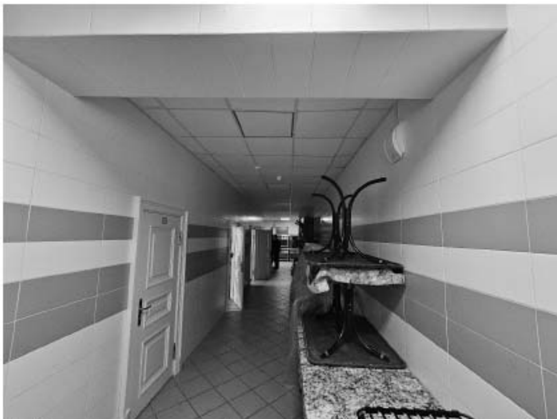
55. Объект культурного наследия федерального значения «Дворец», в составе объекта культурного наследия федерального значения «Дворец Маринский», по адресу: г. Санкт-Петербург, Исаакиевская пл., д. 6, лит. А. Общий вид пом. 15-Н (8, 11, 16) в уровне 1-го этажа.
