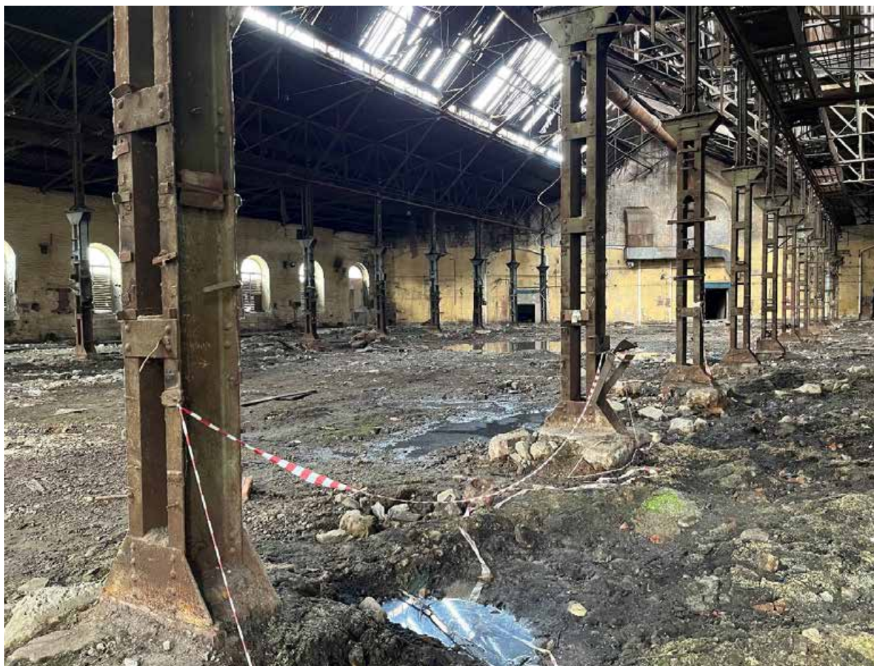
16. Объект культурного наследия федерального значения «Сборно-слесарская мастерская Петербургского товарищества вагоностроительного завода синдиката вагоностроительных заводов “Продвагон”» по адресу: Санкт-Петербург, Московский проспект, д. 115, лит. В. Интерьер мастерской. Вид центрального светового фонаря. Дата съемки: 04.12.2024
