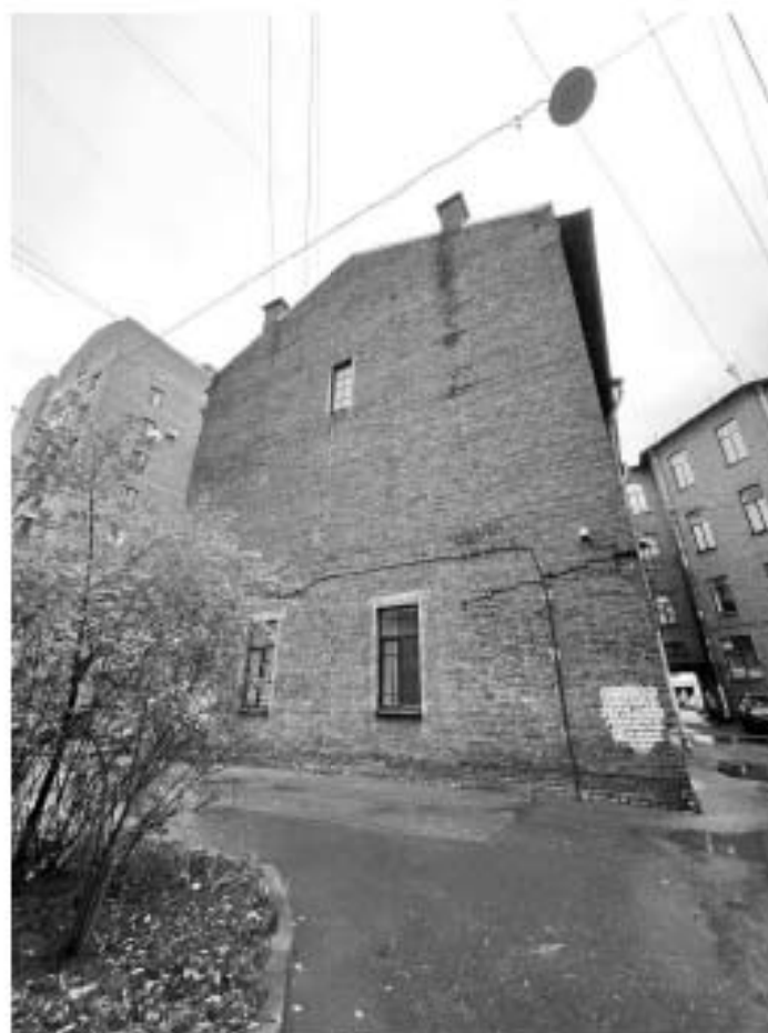
Фото 6. Фрагмент дворового фасада объекта культурного наследия регионального значения «Школа и приют лютеранской церкви св. Екатерины»
