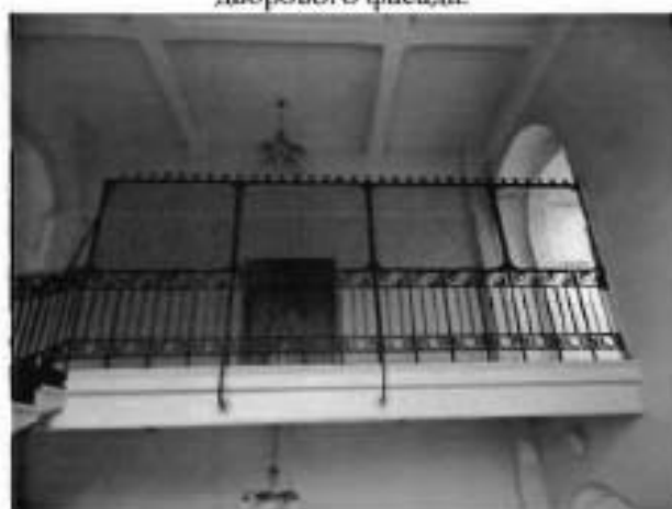
16. Сиротский дом со школой. Внутренняя планировочная структура. Металлическое ограждение лестничной площадки.
