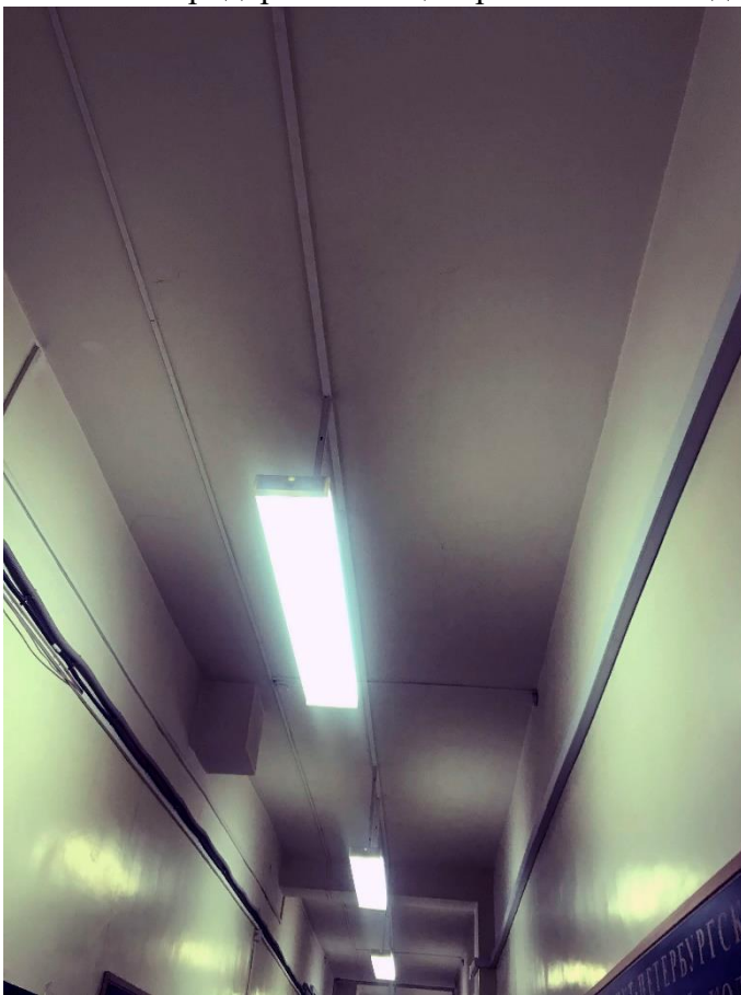
Фото 15. Коридор 2 этажа центральной части здания. Потолок без подшивки.
