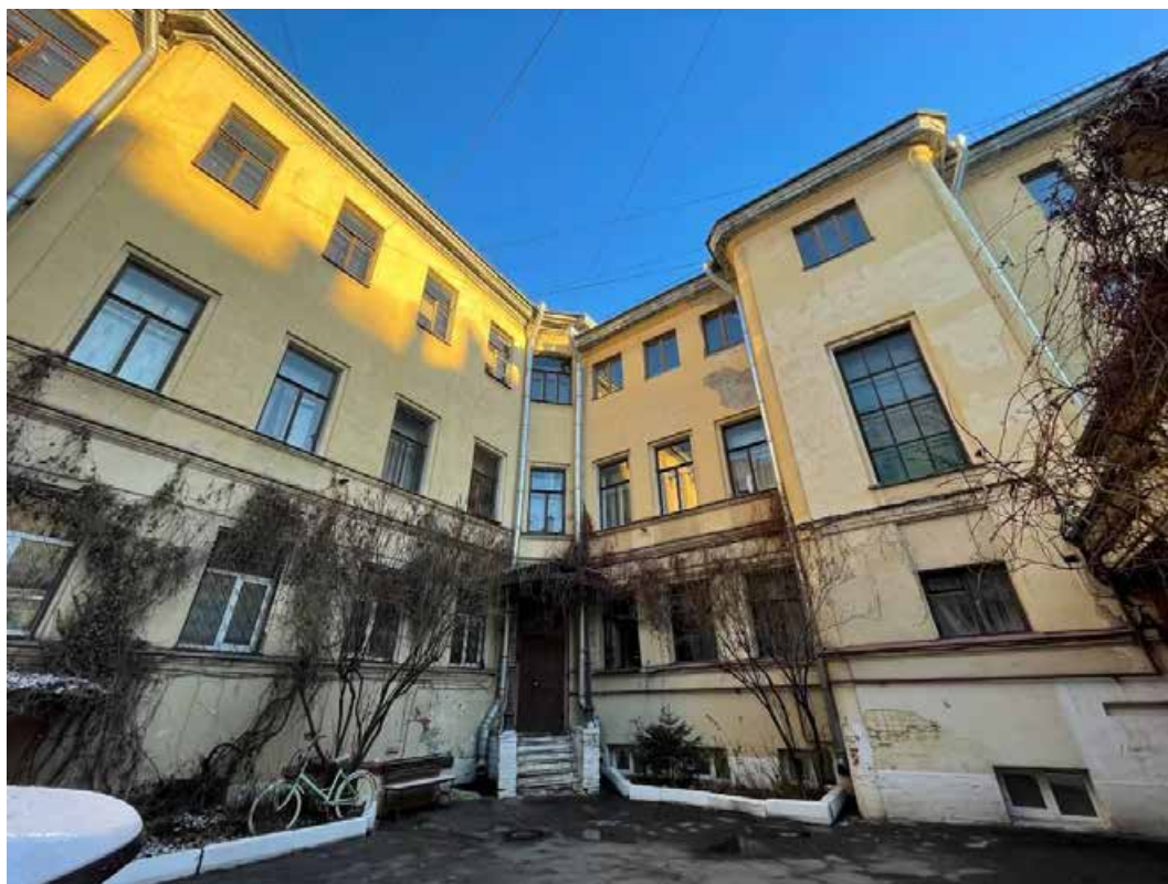
Фото 5. Фрагмент дворового фасада объекта культурного наследия регионального значения «Дворец вел. кн. Кирилла Владимировича»
