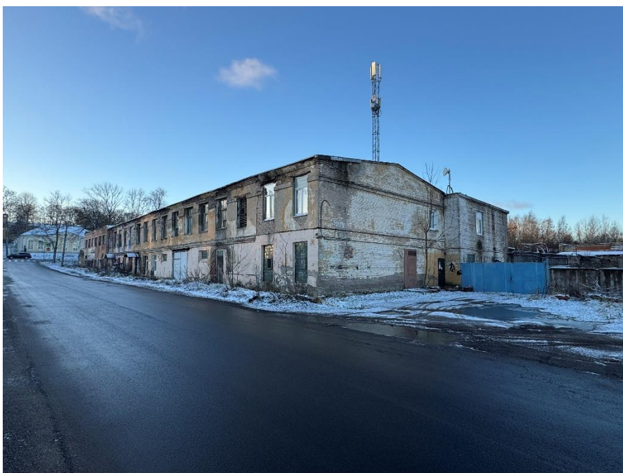
Фото №10. Угол производственного здания литера Б по улице Первомайская в месте технологического присоединения к магистральному газопроводу
