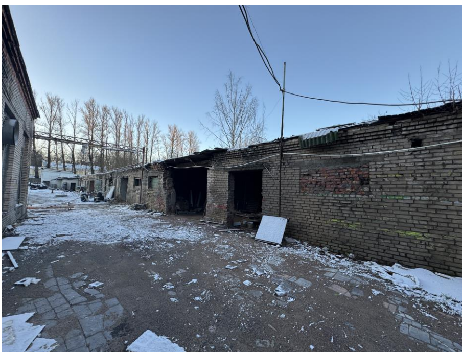
Фото №19. Вид на территорию исследуемого участка и здание склада литера И в сторону Дворцового проспекта
