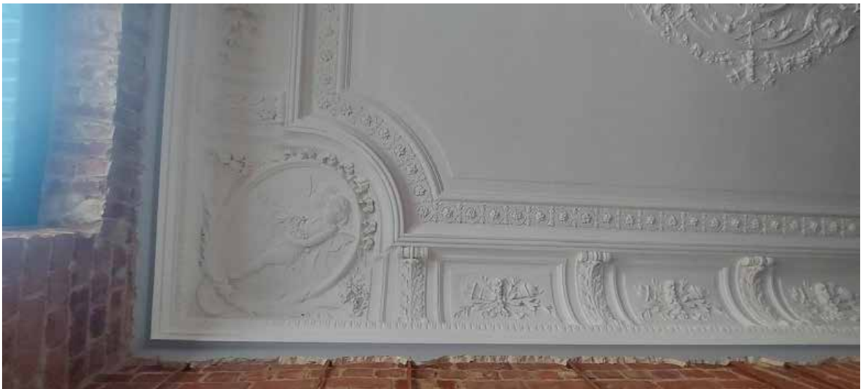
Фото 19. Выявленный объект культурного наследия «Дом М.А.Панова», Санкт-Петербург, Суворовский пр., 1/8, лит.А., квартира 3. Помещение 14 (по плану ПИБ). Падуга, фрагмент.
