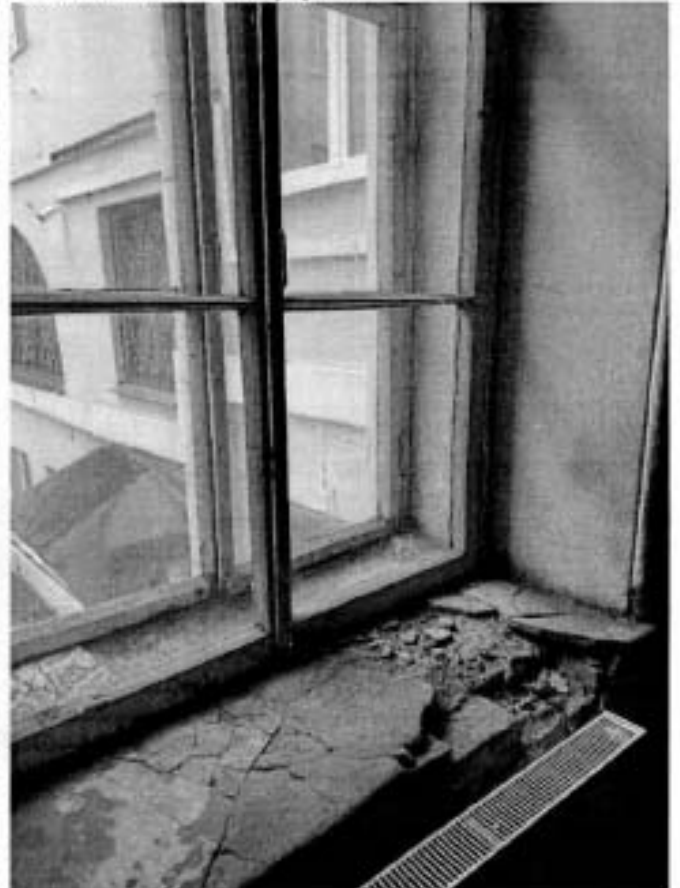
20. 1ЛК, мраморный подоконник между 1-м и 2-м этажами. Частичная утрата.
