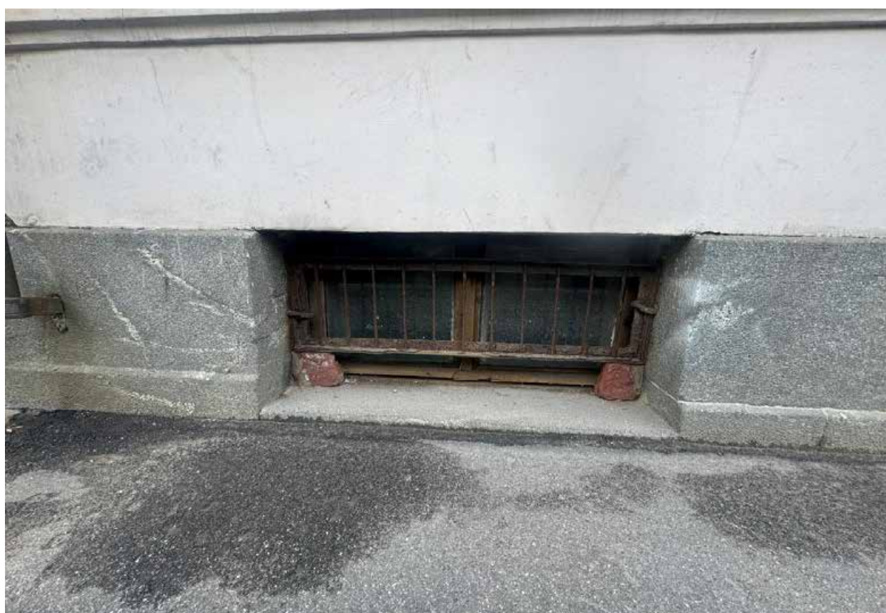
15. Объект культурного наследия «Дворец Великого Князя Кирилла Владимировича». Лицевой фасад. Фрагмент. Оконный проем цокольного этажа.
