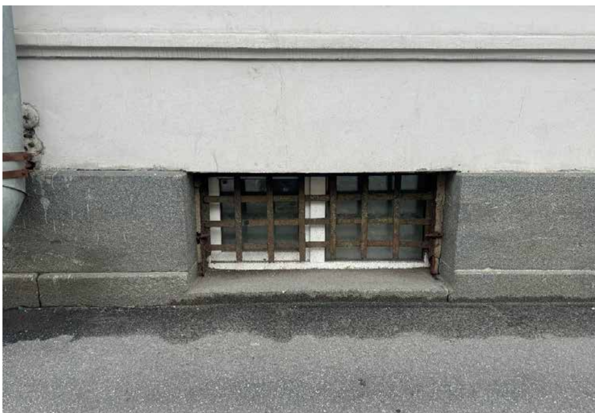
13. Объект культурного наследия «Дворец Великого Князя Кирилла Владимировича». Лицевой фасад. Фрагмент. Оконный проем цокольного этажа.
