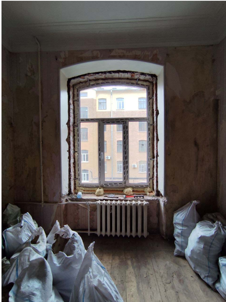
Фото 27. Квартира №32, помещение №5, оконный проем.
