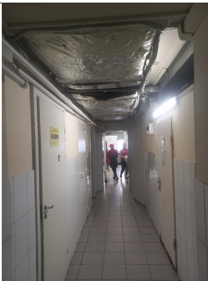
Фото №14. Объект культурного наследия регионального значения «Дом М.Х. Усовой», расположенный по адресу г. Санкт-Петербург, линия 13-я В.О., дом 2/19, литера А. Коридор.
