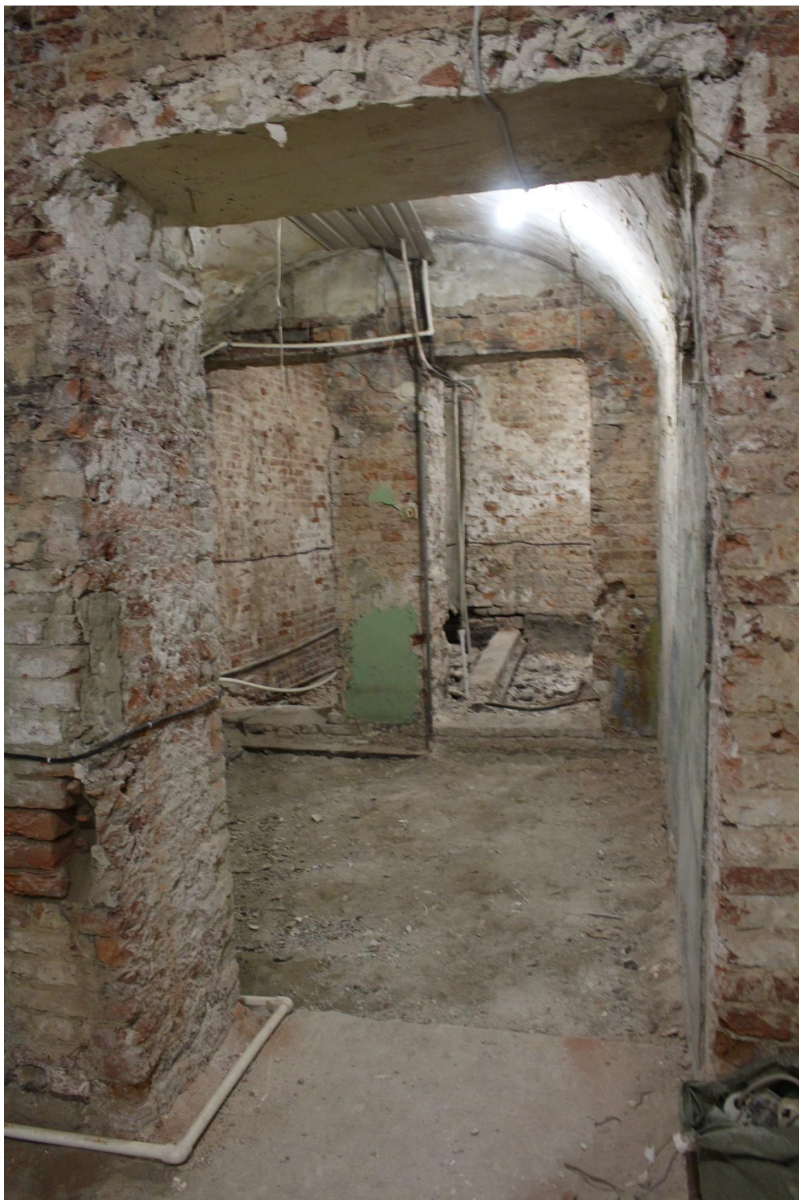
Фото 19. Интерьер помещения 3-Н объекта культурного наследия регионального значения «Дом О.Н. Варгуниной (В.В. Скаржинского)», дверной проем из ч.п. 2 в ч.п. 3.
