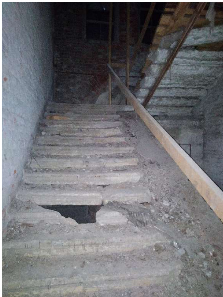
10. ОКНРЗ «Сельдяной ряд Никольского рынка», расположенный по адресу: Санкт-Петербург, Щепяной переулок, дом 4–6, литера А. Историческая межэтажная лестница 4ЛК (двухмаршевая, на металлических косоурах, со ступенями из известняка). Дата съемки: 19.11.2024г.
