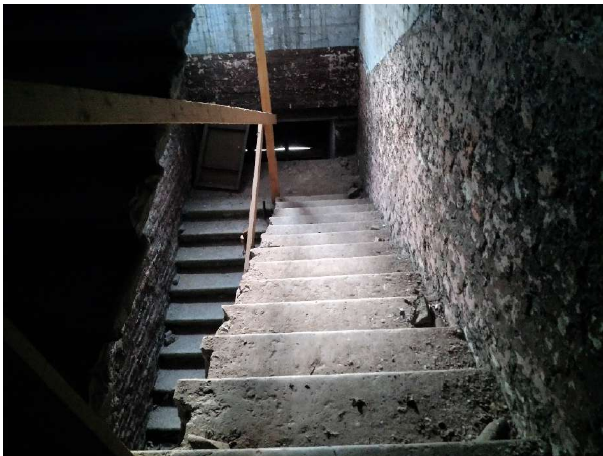
6. ОКНРЗ «Сельдяной ряд Никольского рынка», расположенный по адресу: Санкт-Петербург, Щепяной переулок, дом 4–6, литера А. Историческая межэтажная лестница 2ЛК (двухмаршевая, на металлических косоурах, со ступенями из известняка). Дата съемки: 19.11.2024г.
