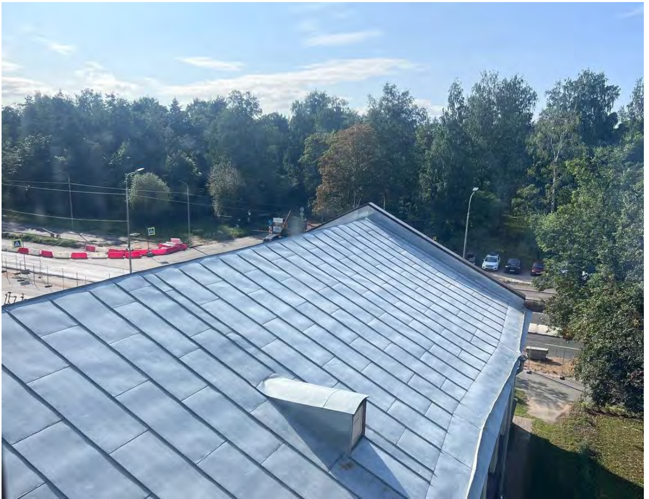
Фото 04. Выявленный ОКН «Гидротехнический институт им. Б.Е. Веденеева (лицевой корпус с примыкающими дворовыми флигелями)», расположенного по адресу: Санкт-Петербург, Гжатская д. 21, лит. А. Кровля. Фрагмент. Съёмка 16.08.2024 г.
