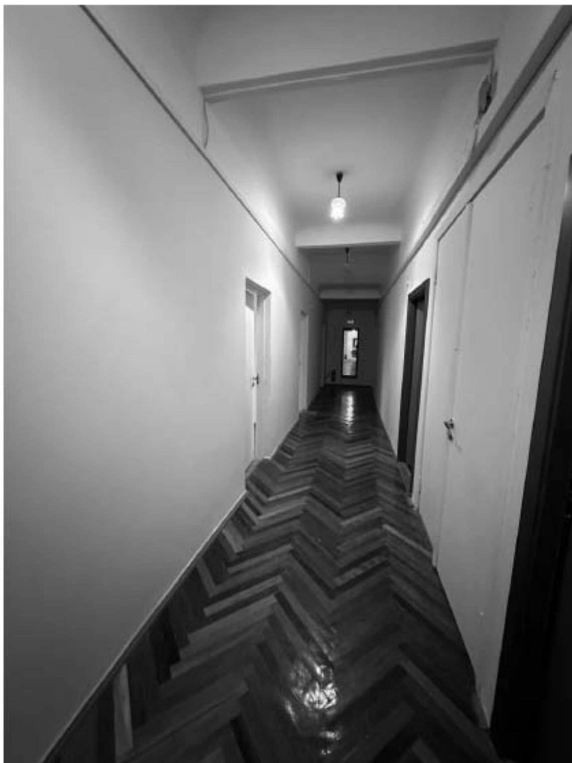
102. “Особняк” входящий в состав ОКН «Особняк Кочубея В.П.». Санкт-Петербург, г. Пушкин, ул. Радищева, дом 4, лит. А. 3-й этаж. Фрагмент интерьера. Фото:28.11.2024.
