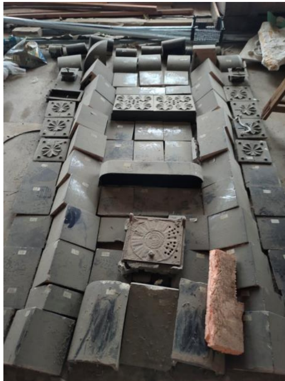
29. ОКН регионального значения «Особняк Кудрявцева с участком», Санкт-Петербург, Выборгское шоссе, д 32. Первый этаж. Печь № 3.
