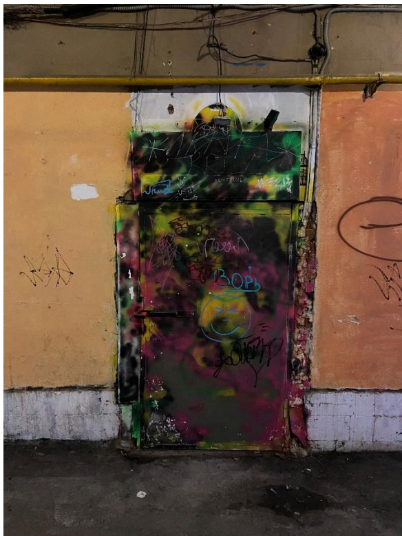
Фото 1. Вид на входную дверь в пом. 1-Н.
