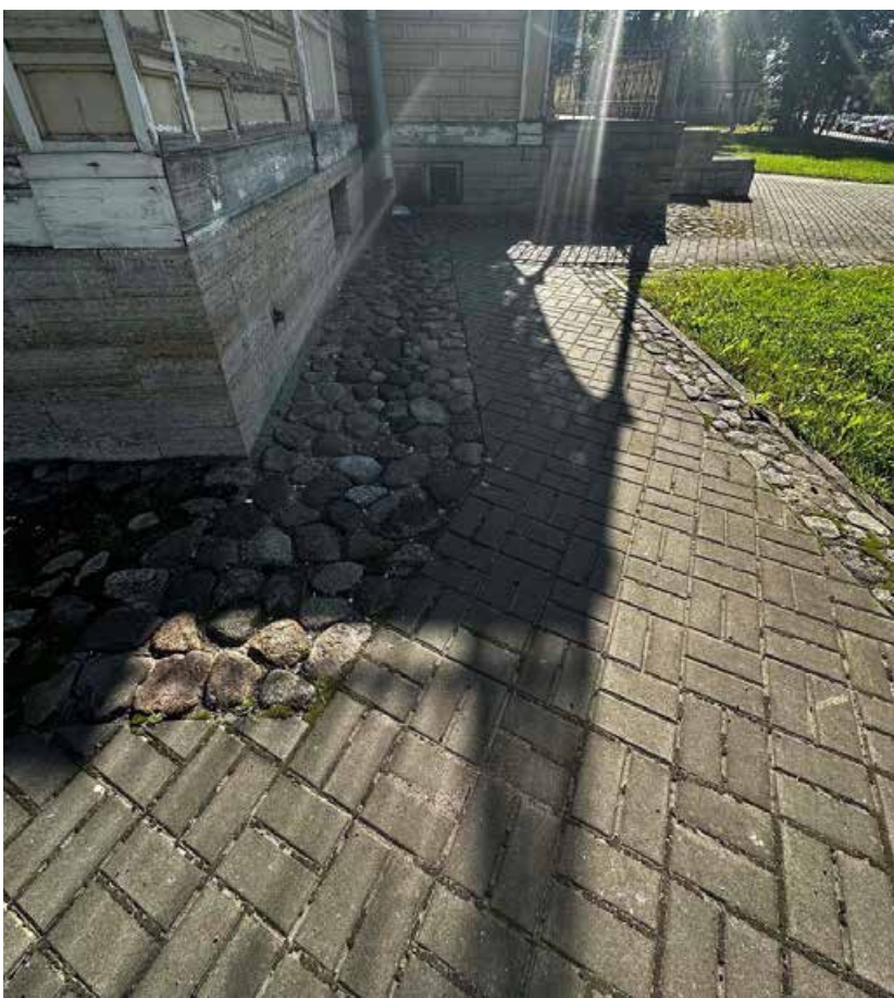
Фото 26. Территория объекта культурного наследия «Дом А. Гейрота с беседкой, садом и оградой». Брусчатая отмостка и газон перед левой частью лицевого юго-западного фасада здания. Фото с северо-запада. Дата съемки: 01.08.2024 г. Автор съемки: Быков А.М.
