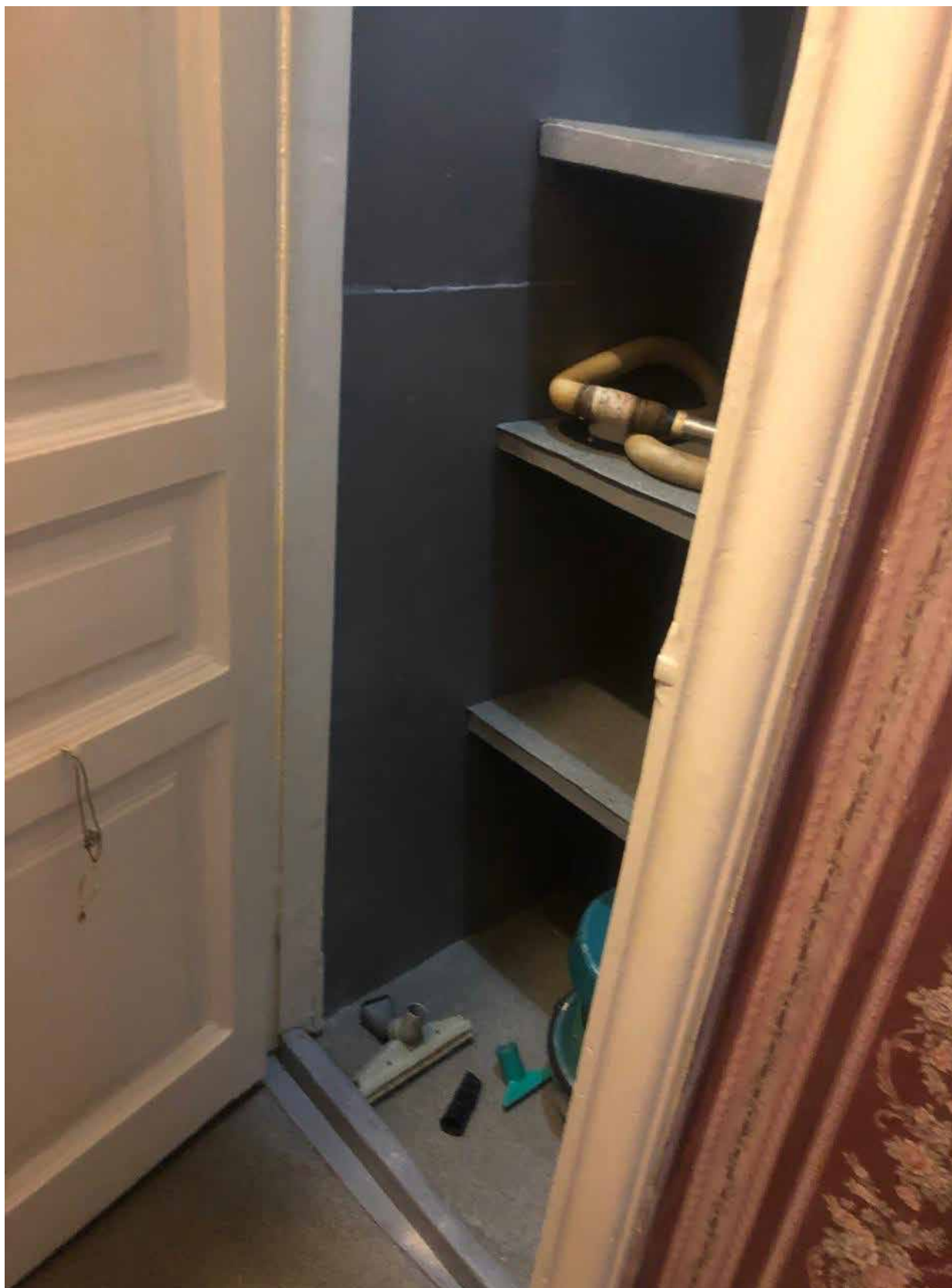
10. Вид на шкаф (помещение 7/0.6);
