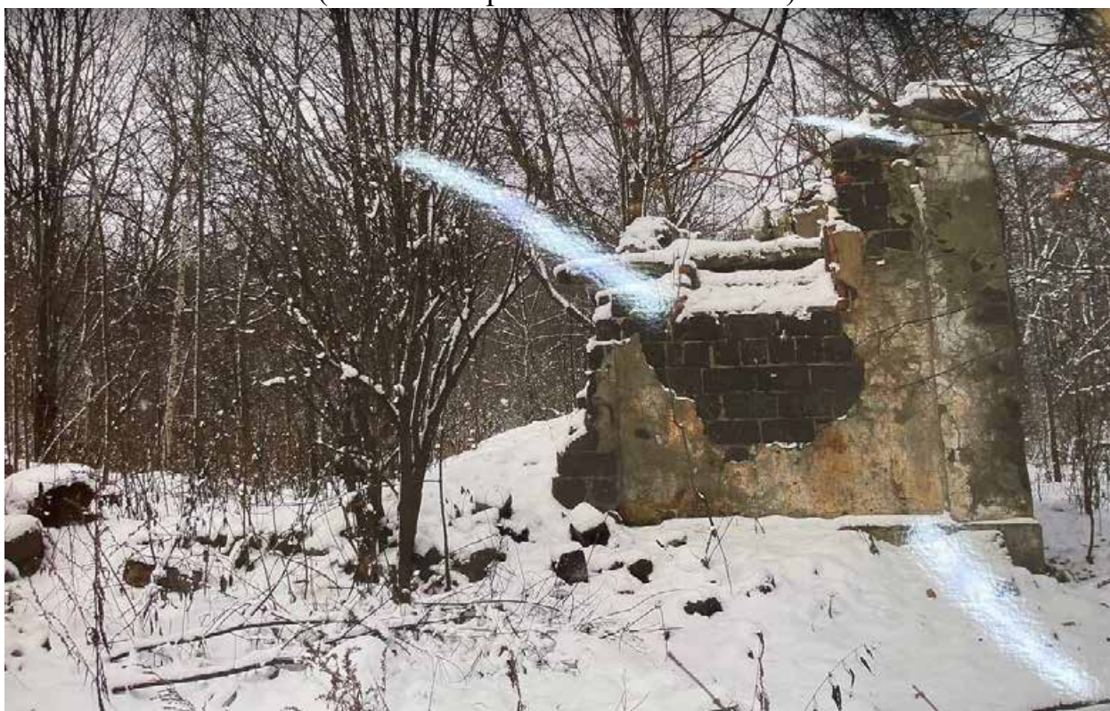
Илл. 25. Руины восточной части северной пристройки к зданию (источник: архив КГИОП 203Г-25).
