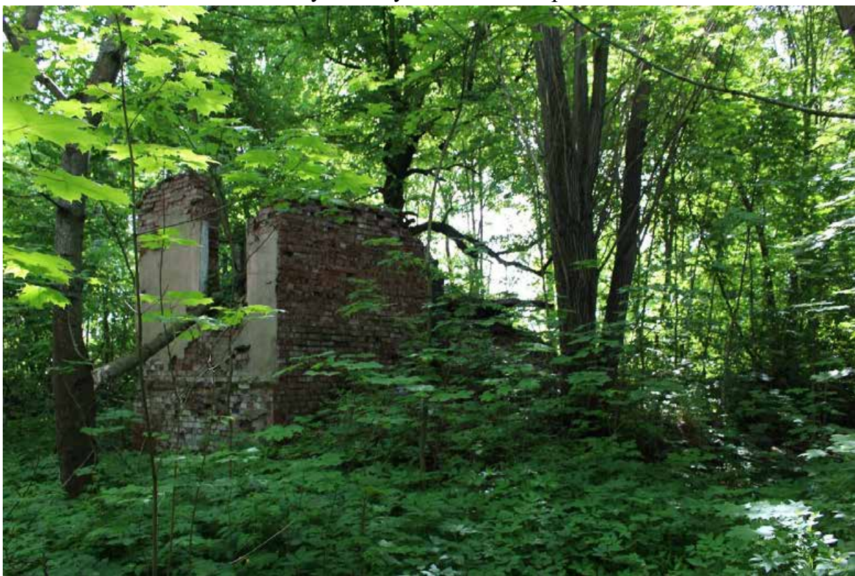
Фото 10. Вид на руины восточной части поздней (1964 г.) северной пристройки к основному объему здания с северо-запада.
