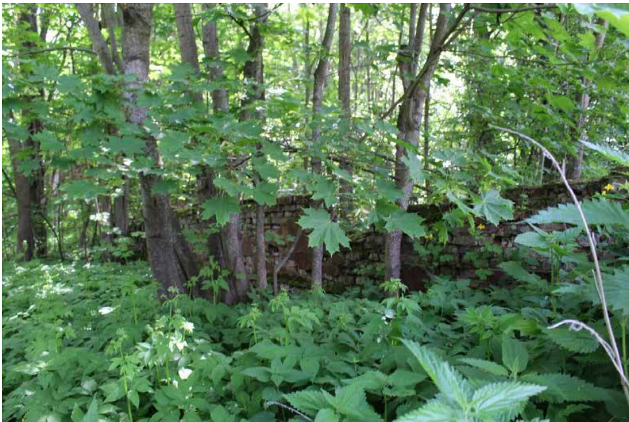
Фото 15. Вид на руины поздней (1964 г.) северной пристройки к основному объему здания.
