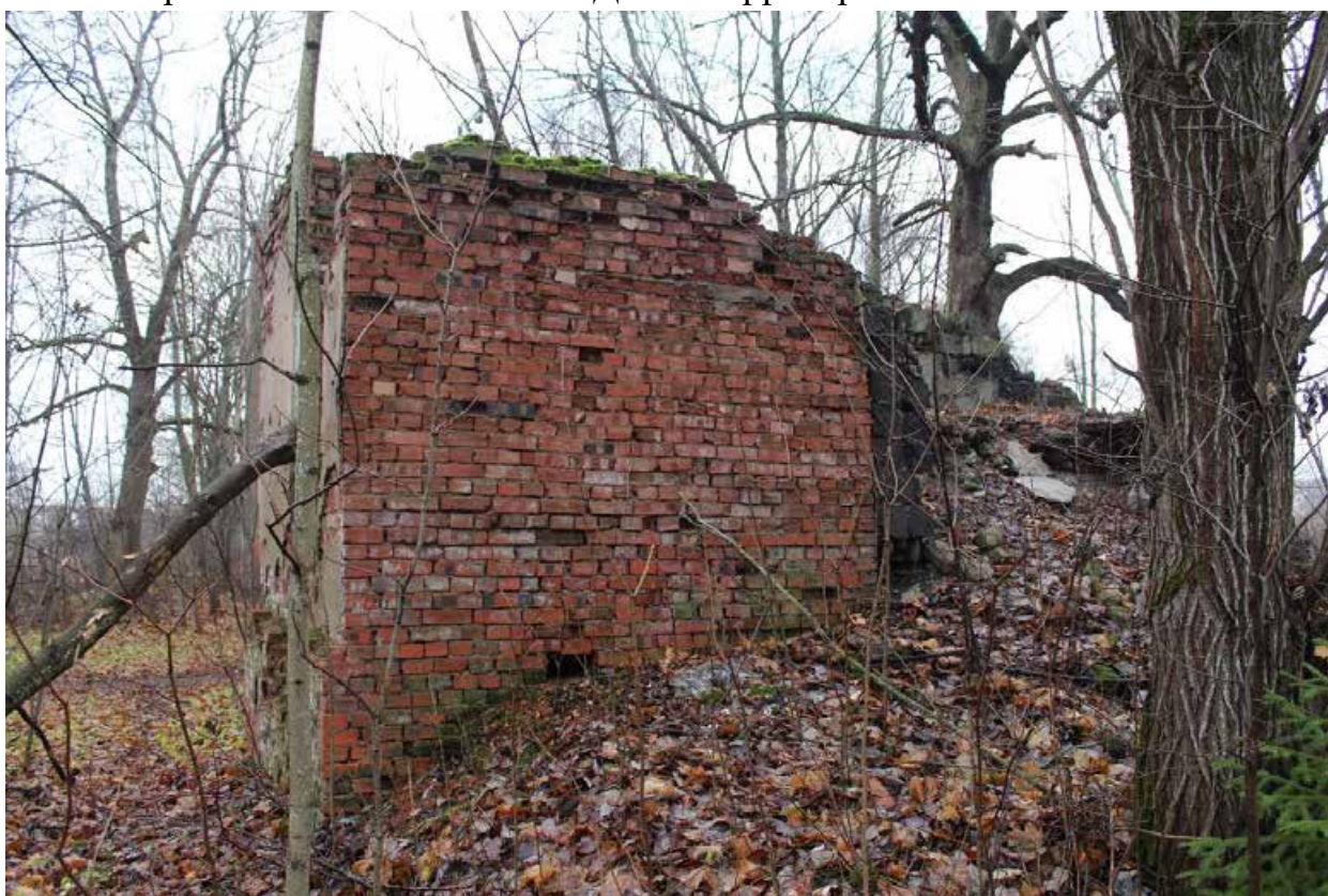
Фото 38. Вид на руины поздней (1964 г.) пристройки, не являющейся объектом культурного наследия.
