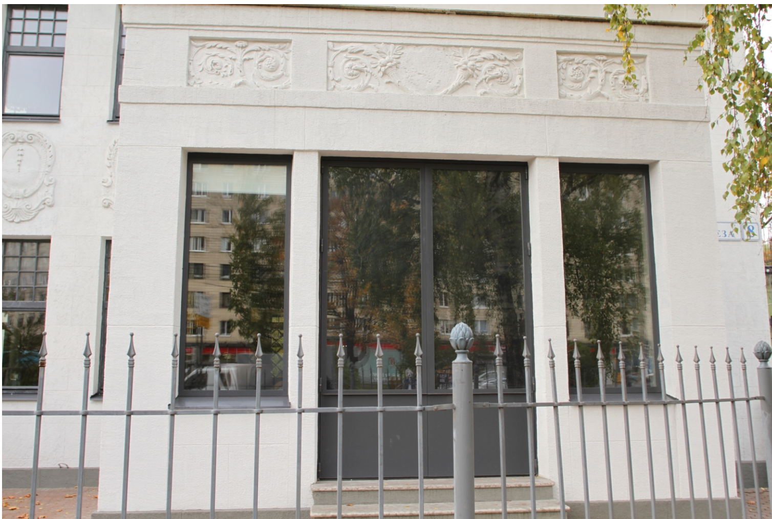
31. “Особняк Д.А. Котлова”. Санкт-Петербург, пр. Тореза, дом 8, лит.А. Юго-западный фасад. Фрагмент. Фото: 04.11.2024.
