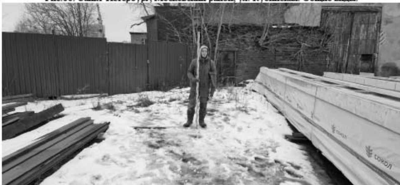
Рис.67. Санкт-Петербург, Московский район, ул. Черниговская. Шурф №1. Фотофиксация до начала работ. Вид с юга.
