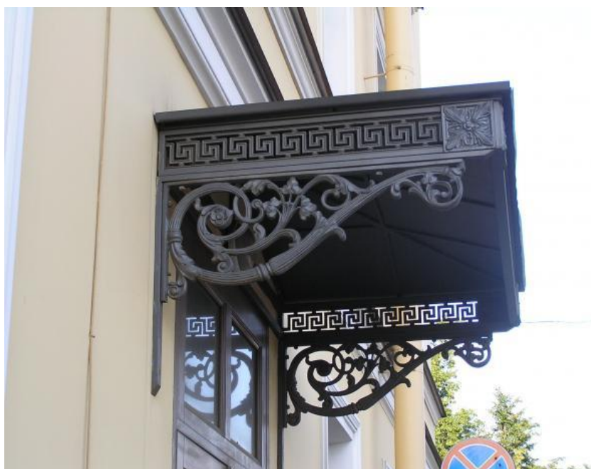
67. Бывший Николаевский дом призрения престарелых и увечных граждан Санкт-Петербургского купеческого общества. Крыльцо со стороны Расстанной улицы. Козырек. Фотография. Март 2013. www.citywalls.ru .
