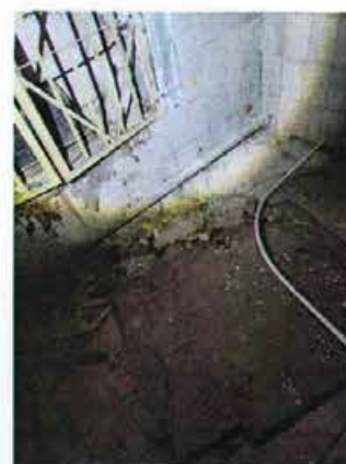
Фото 57. Внутренняя система канализации Части 1 (на цокольном этаже в ч.п. 15 помещения 3-Н).
