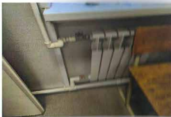
Фото 68. Радиаторы отопления в Части 3 здания (в ч.п. 8 пом. 24-Н).
