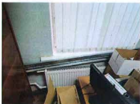
Фото 79. Радиаторы отопления в Части 4 здания (на 1-ом этаже в ч.п. 14 помещения 17-Н).
