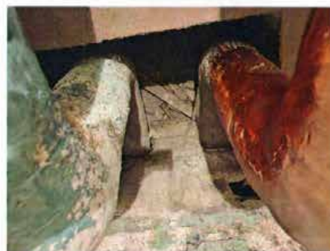
Фото 51. Ввод системы отопления в здание в ч.п.4 помещения 11-Н на цокольном этаже (Часть 1).
