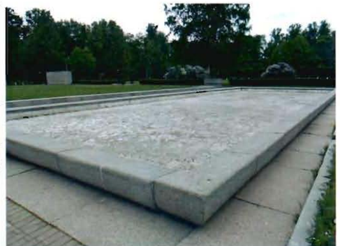
13. Декоративный бассейн, расположенный в центральной части территории.
