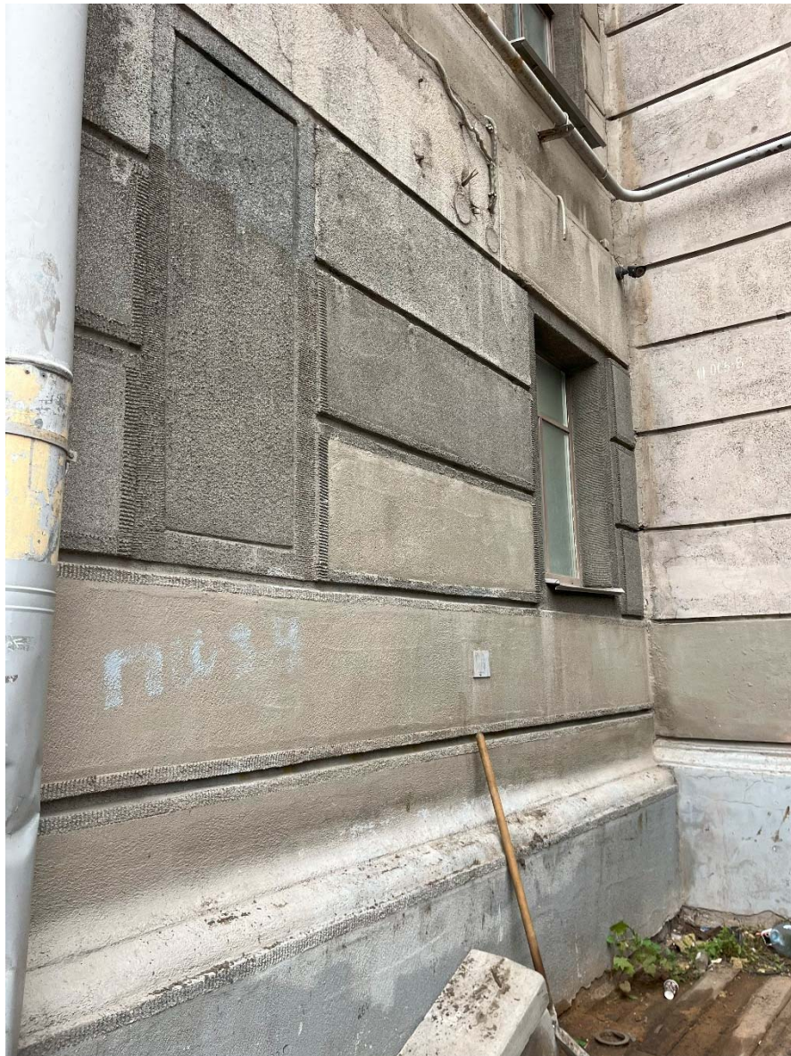
Фото №7. Фрагмент лицевого фасада, окна в границах помещения 7-Н.
