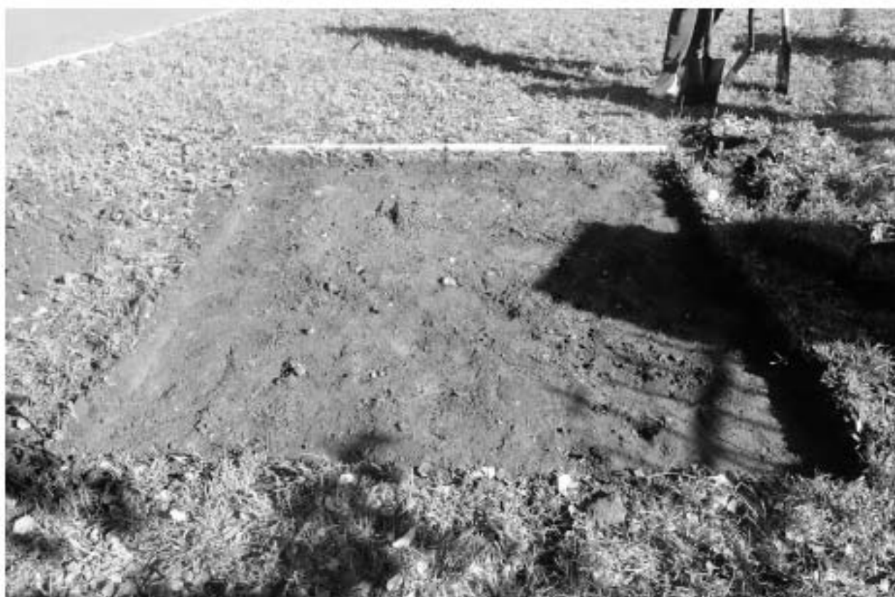
Илл. 24. г. Санкт-Петербург. МО Василеостровский район. Реконструкция наружного освещения парков, садов и скверов с внедрением энергосберегающего и энергетически эффективного оборудования объекта: Благовещенский сад, Шурф №1. Зачистка после снятия дерна. Вид с юга.
