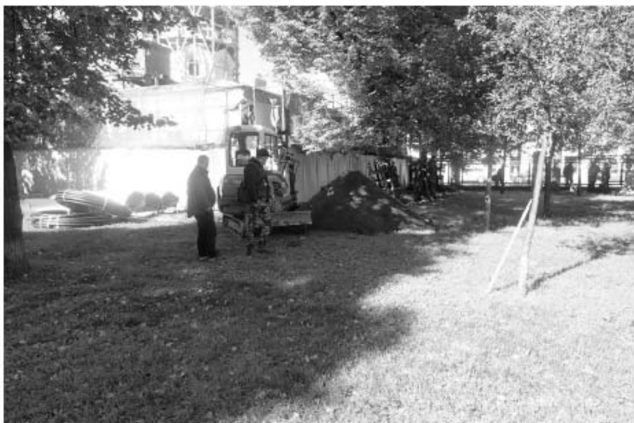
Илл. 17. г. Санкт-Петербург. МО Василеостровский район. Реконструкция наружного освещения парков, садов и скверов с внедрением энергосберегающего и энергетически эффективного оборудования объекта: Благовещенский сад. Нарушение целостности культурных напластований (котлованы ННБ) при прокладке водопровода. Вид с юго-востока.
