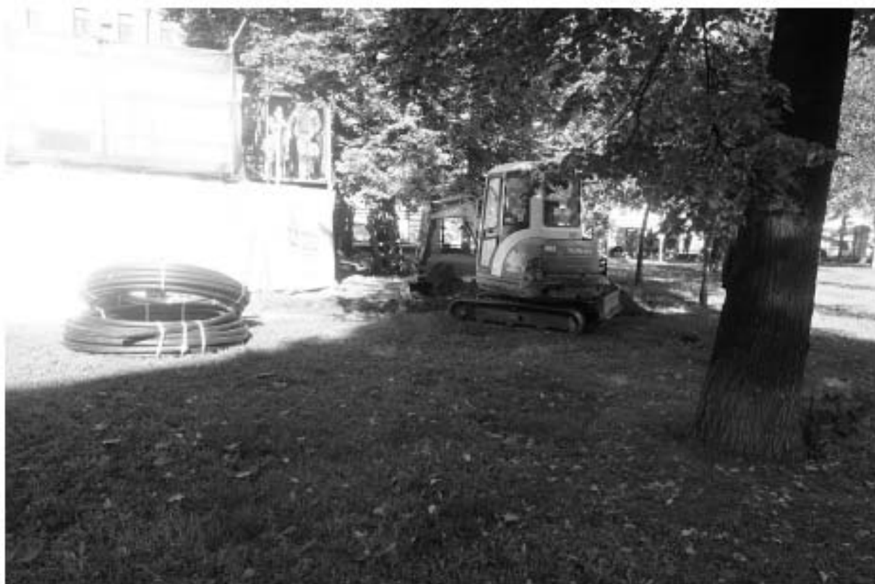
Илл. 18. г. Санкт-Петербург. МО Василеостровский район. Реконструкция наружного освещения парков, садов и скверов с внедрением энергосберегающего и энергетически эффективного оборудования объекта: Благовещенский сад. Нарушение целостности культурных напластований (котлованы ННБ) при прокладке водопровода. Вид с юго-запада.
