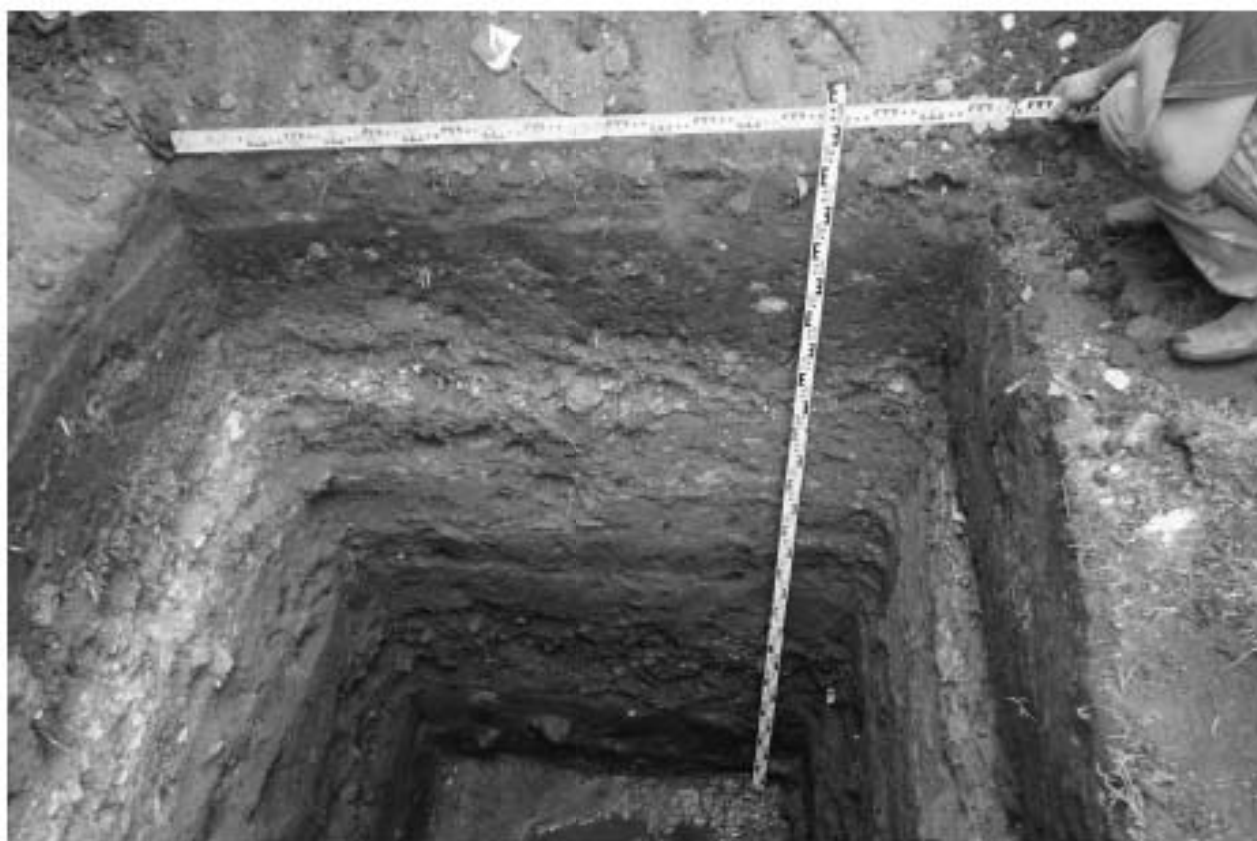
Илл. 84. г. Санкт-Петербург. МО Василеостровский район. Реконструкция наружного освещения парков, садов и скверов с внедрением энергосберегающего и энергетически эффективного оборудования объекта: Благовещенский сад, Шурф №3. Восточная стенка. Вид с запада.
