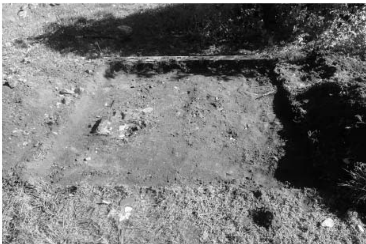
Илл. 69. г. Санкт-Петербург. МО Василеостровский район. Реконструкция наружного освещения парков, садов и скверов с внедрением энергосберегающего и энергетически эффективного оборудования объекта: Благовещенский сад, Шурф №3. Зачистка после снятия дерна. Вид с юга.
