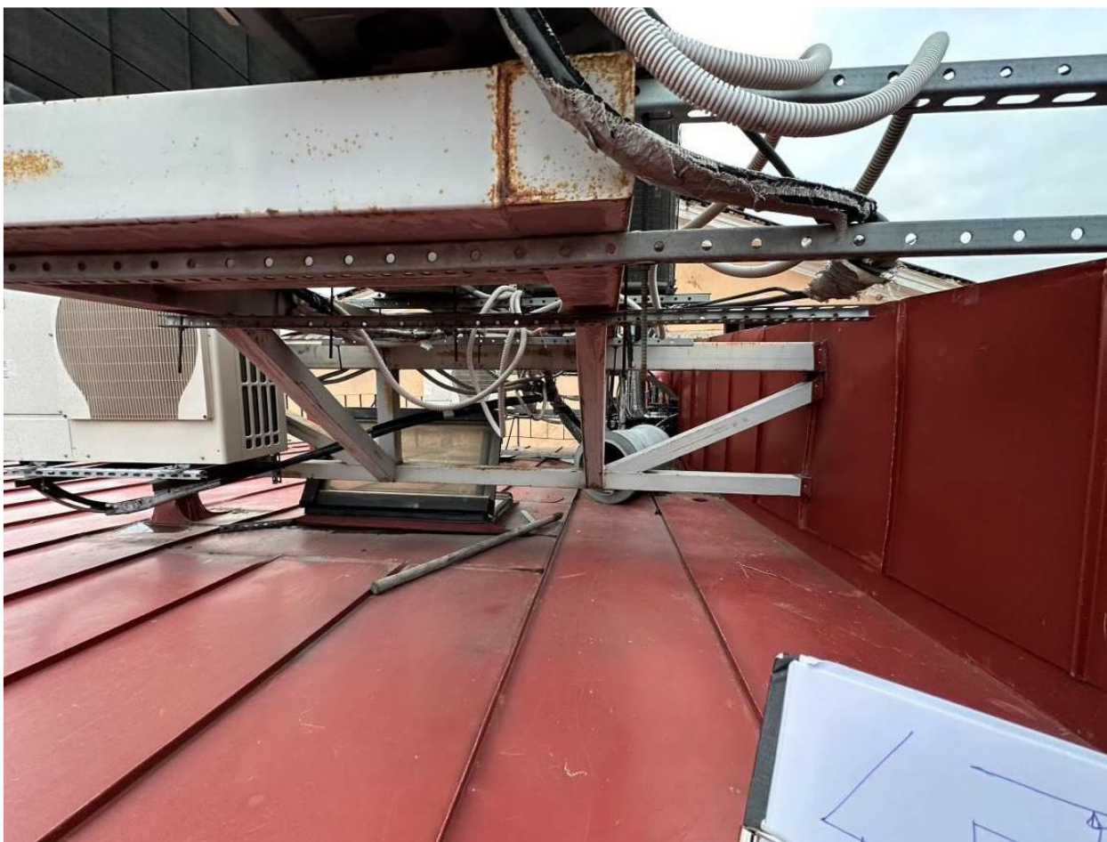
Фото 22. Металлическая рама под наружные блоки кондиционеров и оборудование.
