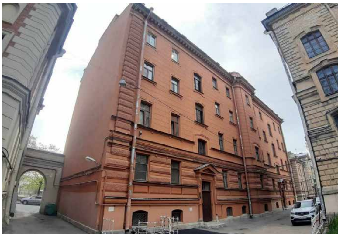
10. «Флигель жилой» (в составе «Дворец Великого князя Алексея Александровича») (Английский пр., д. 2, лит. А). Дворовый фасад. Фото мест установки оборудования и прокладки кабельных трасс. Штиглиц М.С. 12.05.2025.
