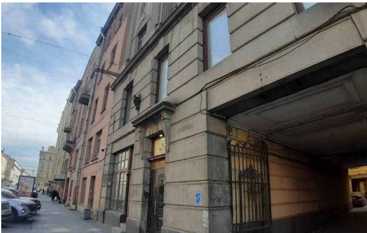
23. «Дом Второго Российского общества страхования от огня с флигелями» (Гороховая улица, д. 3, лит. А). Лицевой фасад. Фото мест установки оборудования и прокладки кабельных трасс. Штиглиц М.С. 12.05.2025.
