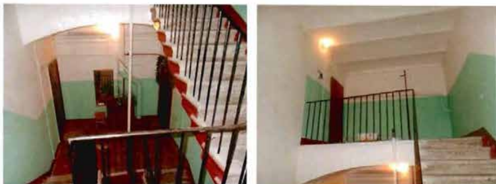
60, 61. Интерьеры и техническое состояние квартир (кв. 44)
