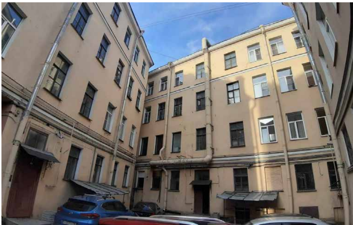
33. «Дом Серебряковых» (Измайловский пр., д. 1, лит. А). Дворовые фасады. Фото мест установки оборудования и прокладки кабельных трасс. Штиглиц М.С. 12.05.2025.
