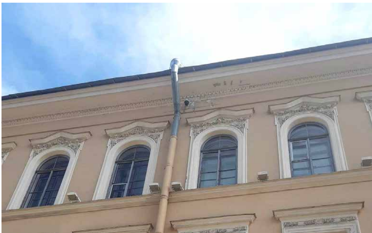
4. «Дом, где в 1866-1870 гг. находилась «Артель художников» и жил художник Крамской И.Н.» (Вознесенский пр., д. 2, лит. А). Лицевой фасад. Фото мест установки оборудования и прокладки кабельных трасс. Штиглиц М.С. 12.05.2025.
