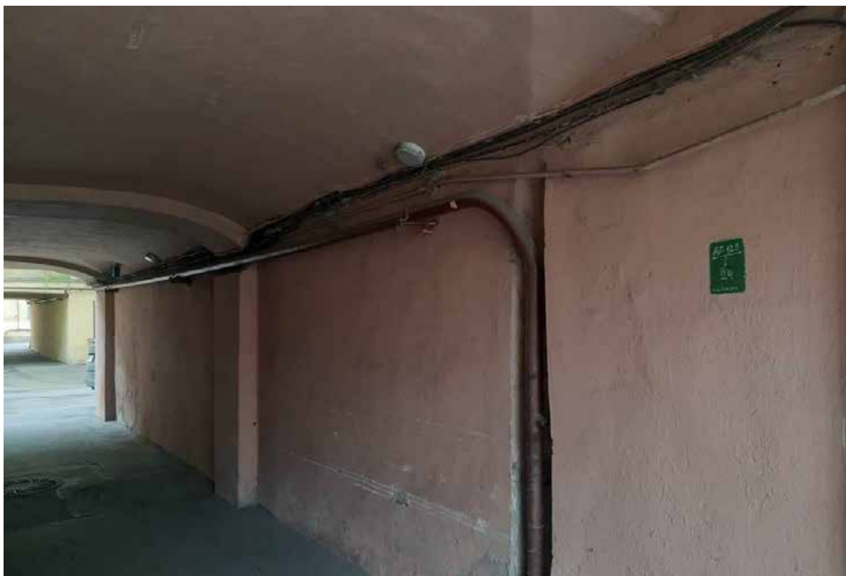
27. «Дом И. Иохима». (Казанская ул., д. 39, лит. А). Фото мест установки оборудования и прокладки кабельных трасс. Штиглиц М.С. 12.05.2025.
