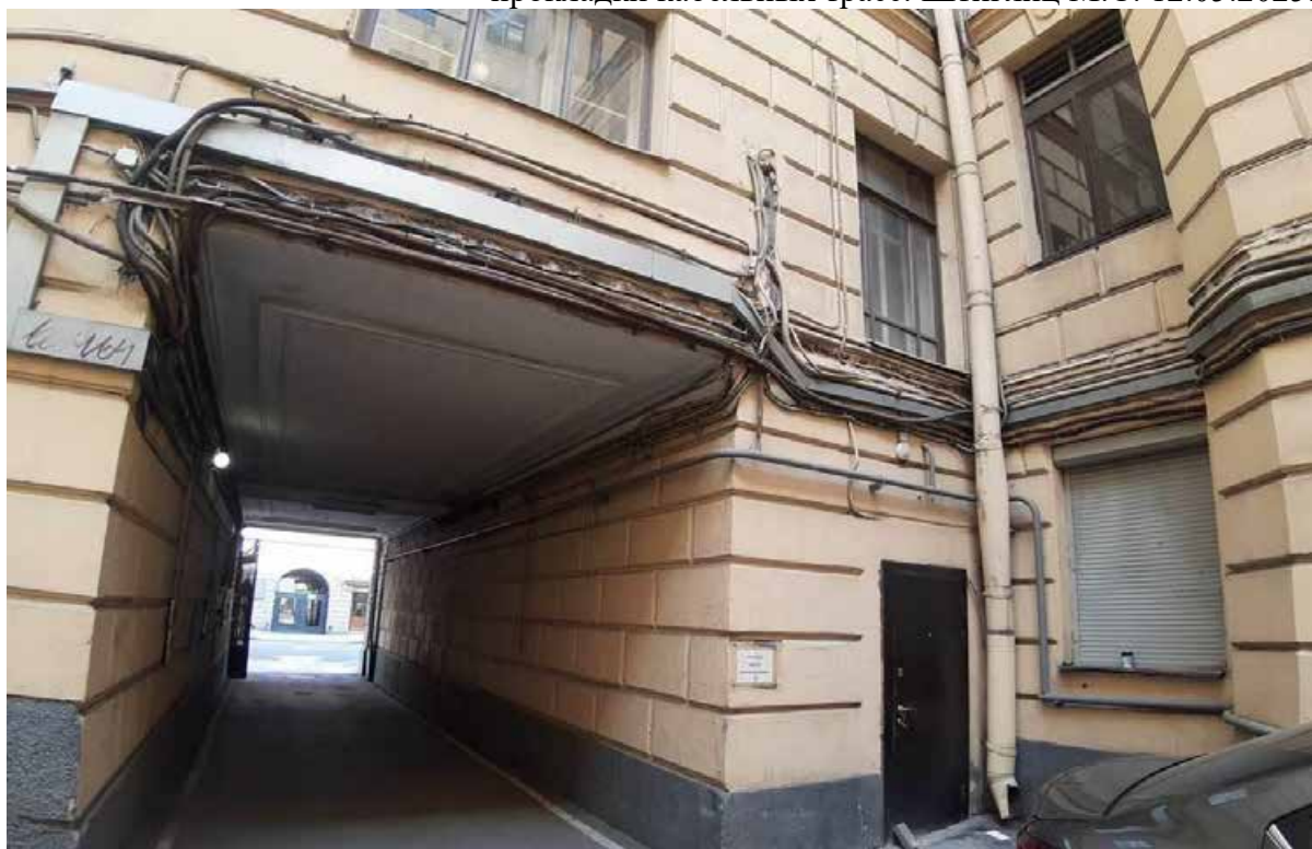
22. «Дом Второго Российского общества страхования от огня с флигелями» (Гороховая улица, д. 3, лит. А). Дворовые фасады. Фото мест установки оборудования и прокладки кабельных трасс. Штиглиц М.С. 12.05.2025.
