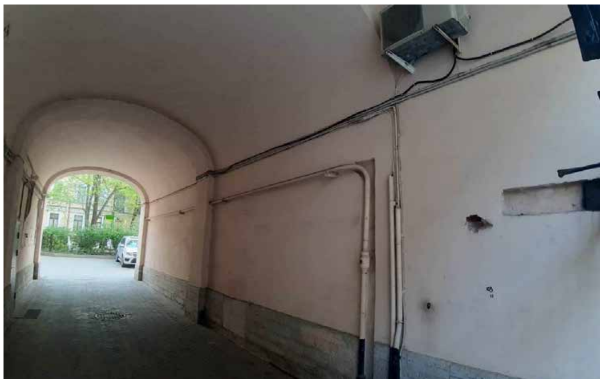
18. «Дом В.П. Орлова-Давыдова» (Галерная ул., д. 19, лит. А). Фото мест установки оборудования и прокладки кабельных трасс. Штиглиц М.С. 12.05.2025.
