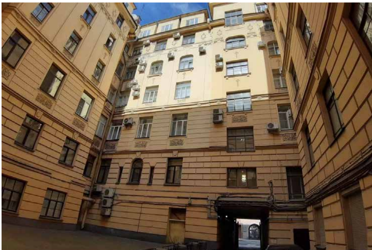
21. «Дом Второго Российского общества страхования от огня с флигелями» (Гороховая улица, д. 3, лит. А). Дворовые фасады. Фото мест установки оборудования и прокладки кабельных трасс. Штиглиц М.С. 12.05.2025.
