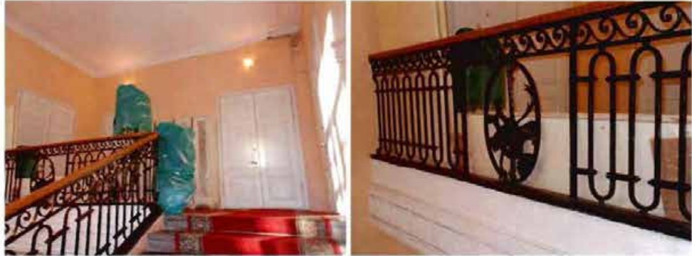
73, 74. Интерьеры и техническое состояние квартир (кв. 46, 47, 48)
