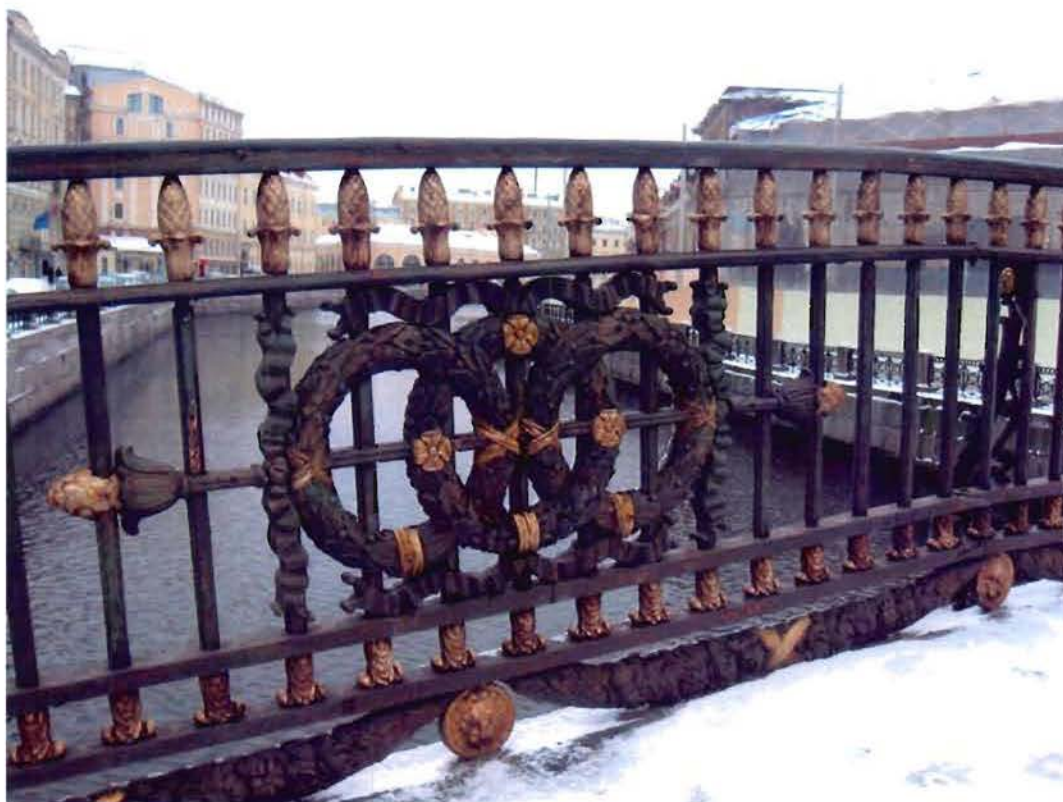
5. Решётка перильного ограждения (утрата красочного слоя и позолоты, коррозия)
