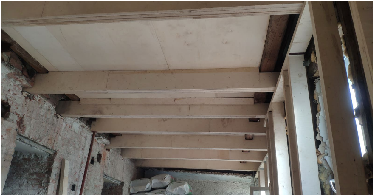
Фото № 15. Интерьер квартиры № 26. Помещения 2,3. Ценные элементы архитектурно-художественной отделки отсутствуют. Потолок разобран. Проводятся противоаварийные работы.
