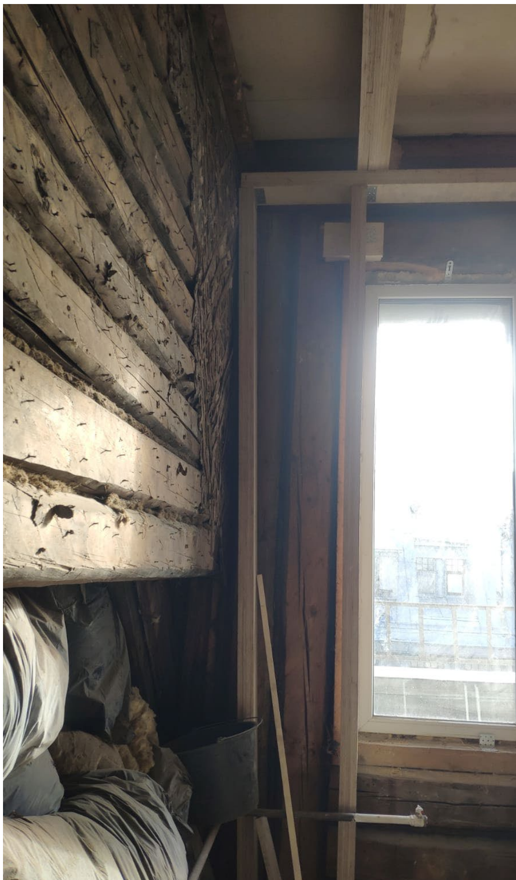
Фото № 13. Интерьер квартиры № 26. Помещение 4. Ценные элементы архитектурно-художественной отделки отсутствуют. Внутренняя обшивка стен разобрана. Проводятся противоаварийные работы.
