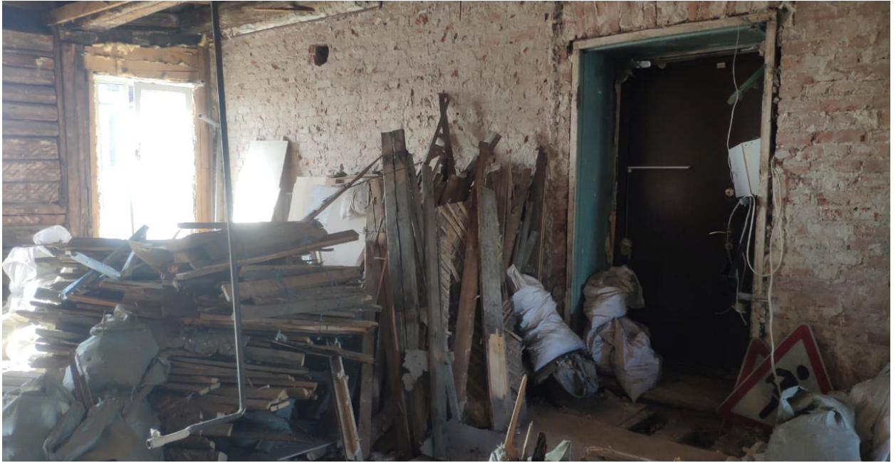
Фото № 5. Интерьер квартиры № 26. Помещения 1,6,7,8,9,10. Перегородки и ценные элементы архитектурно-художественной отделки отсутствуют. Проводятся противоаварийные работы.
