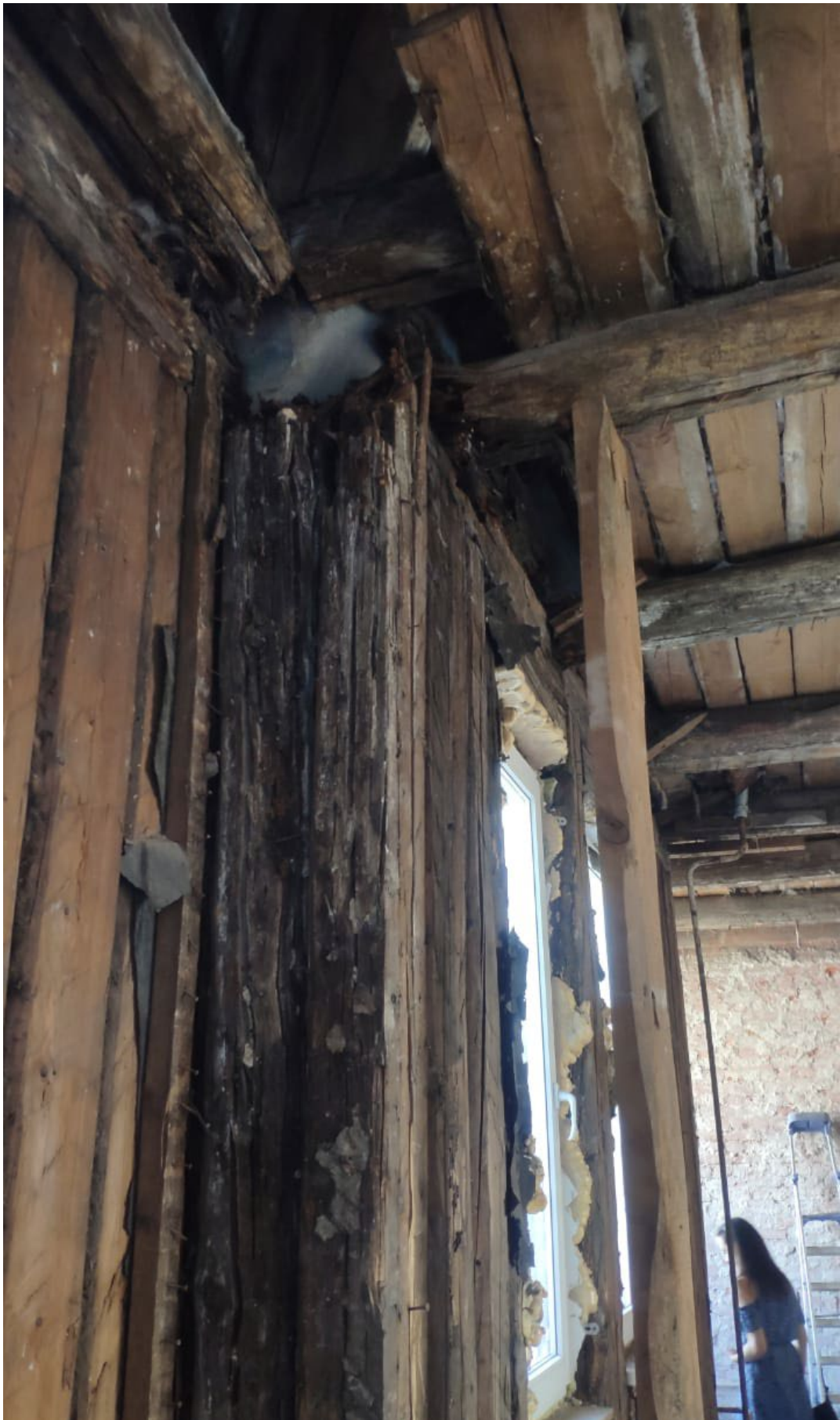
Фото № 4. Интерьер квартиры № 26. Присутствуют повреждения элементов стропильной конструкции. Элементы архитектурно-художественной отделки отсутствуют.
