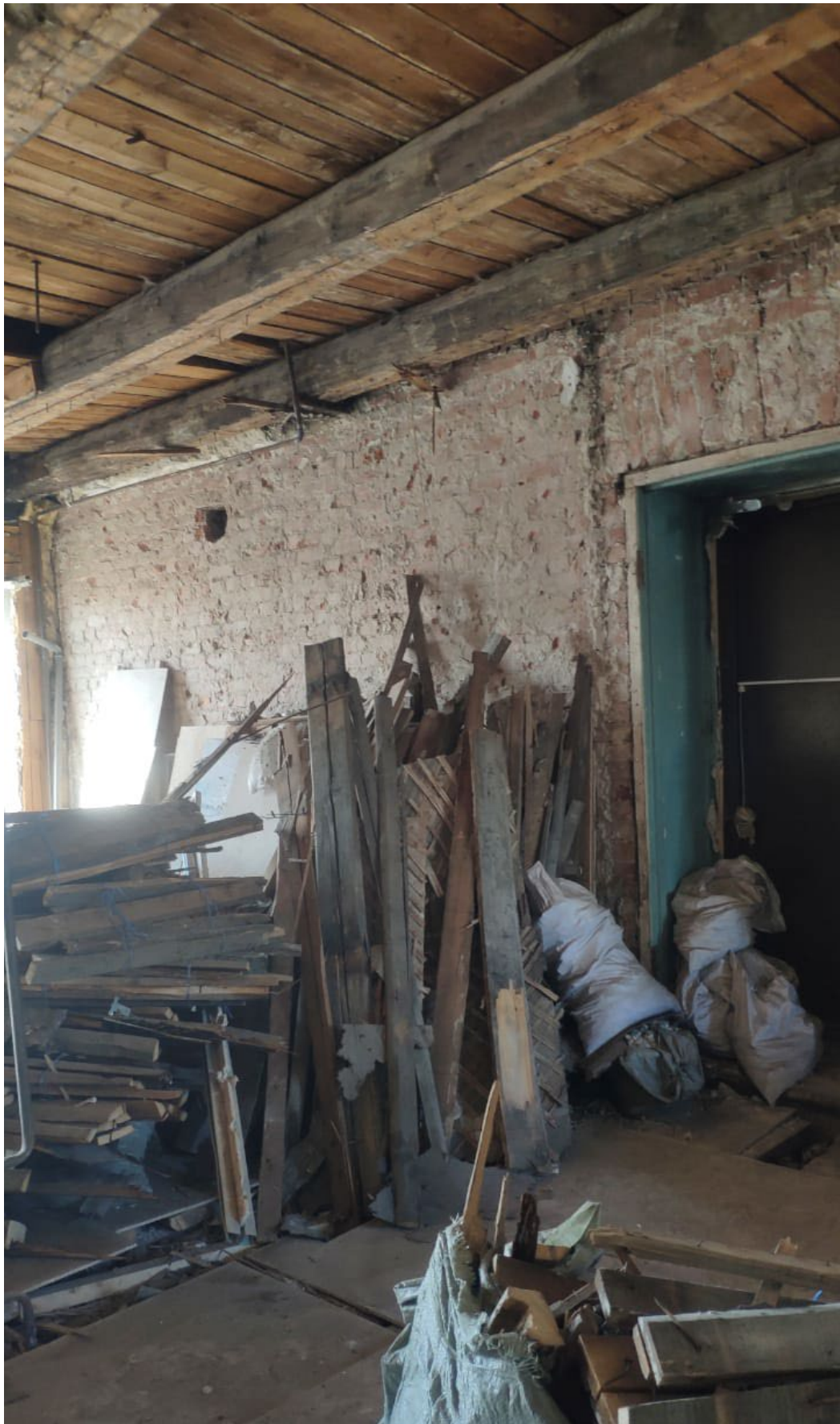
Фото № 3. Интерьер квартиры № 26. Помещения 1,6,7,8,9,10. Перегородки и ценные элементы архитектурно-художественной отделки отсутствуют. Проводятся противоаварийные работы.
