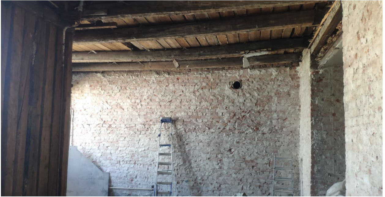
Фото № 9. Интерьер квартиры № 26. Помещение 4. Перегородки и ценные элементы архитектурно-художественной отделки отсутствуют. Проводятся противоаварийные работы.
