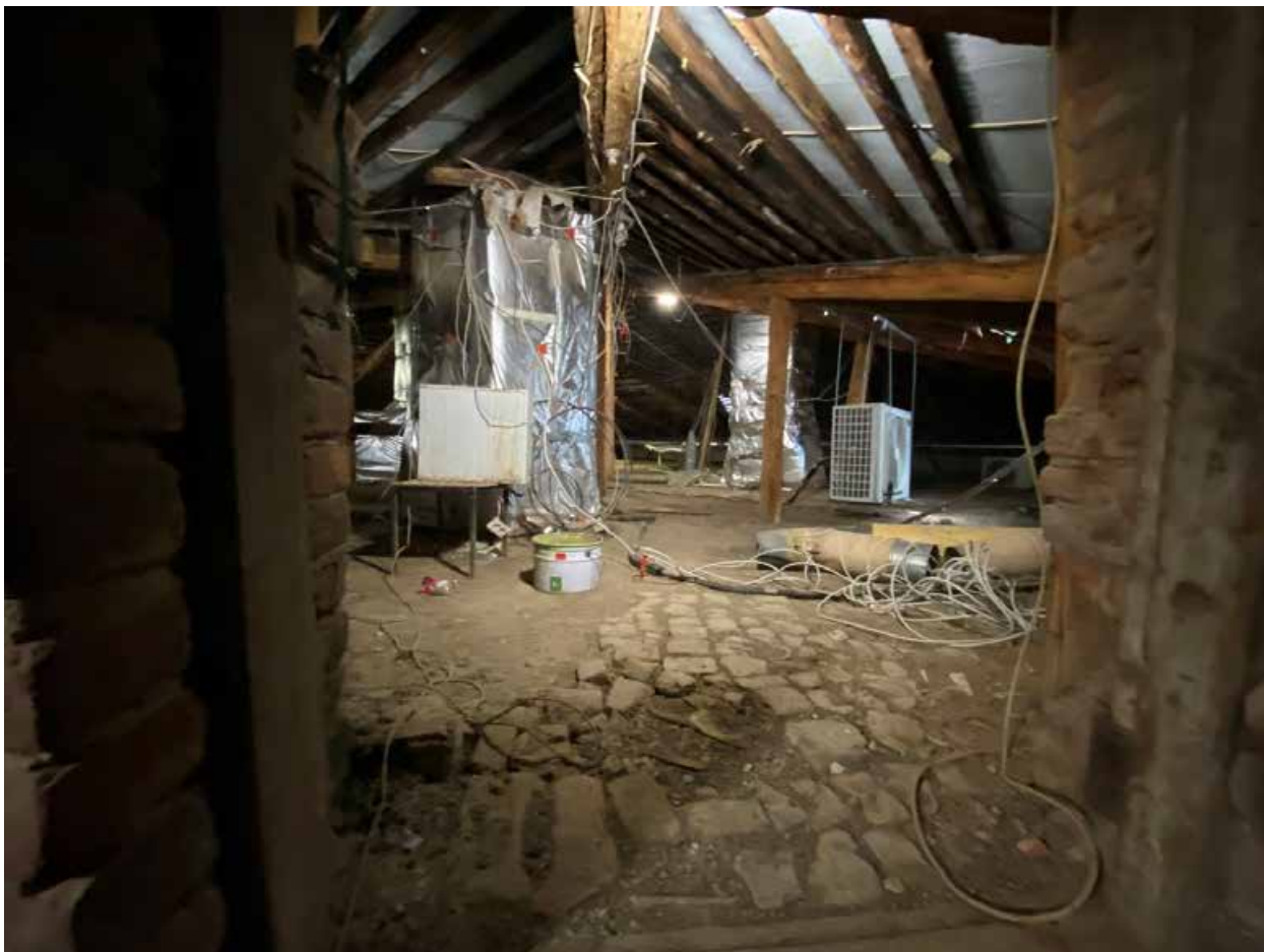
Фото 208. Чердак. Оборудование, размещенное на чердаке.
