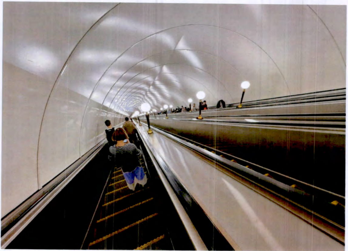
5. Эскалатор наклонного хода объекта культурного наследия.
