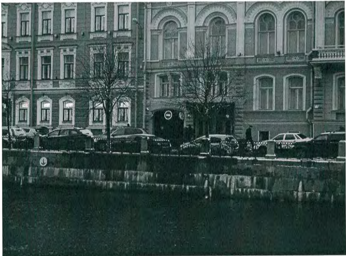
11. Загрязнение гранитной облицовки, выщелачивание шовного раствора (правобережный участок набережной между Красным и Синим мостами)
