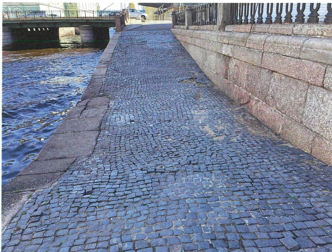
5. Состояние брусчатки на спуске.
