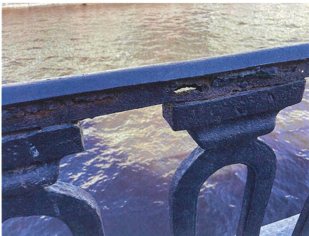
4. Сквозная коррозия ограждения.
