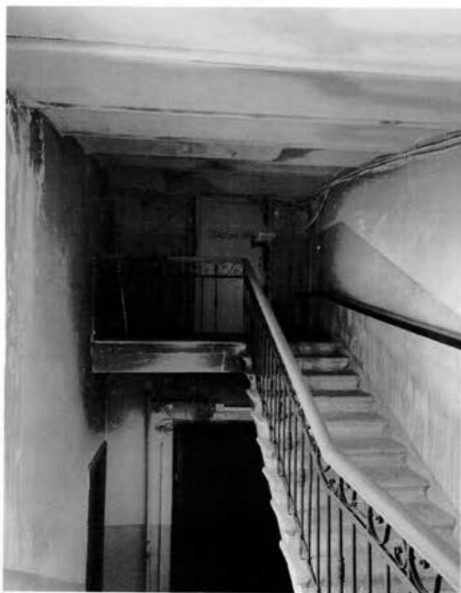
29. Интерьеры. Лестница 2ЛК. Дефекты (фото от 06.06.2024)
