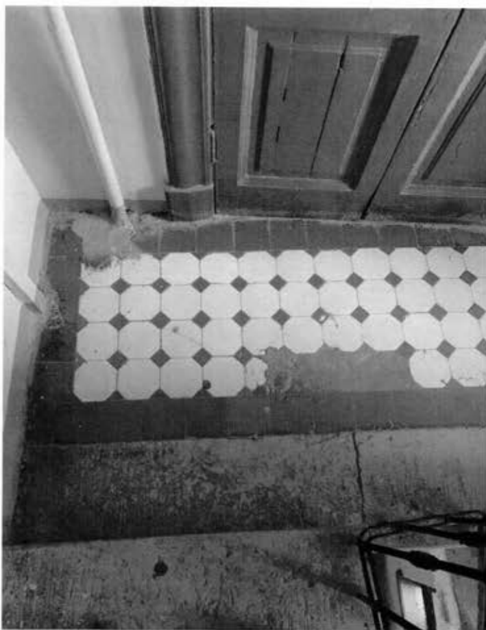
32. Интерьеры. Лестница 2ЛК. Дефекты (фото от 06.06.2024)
