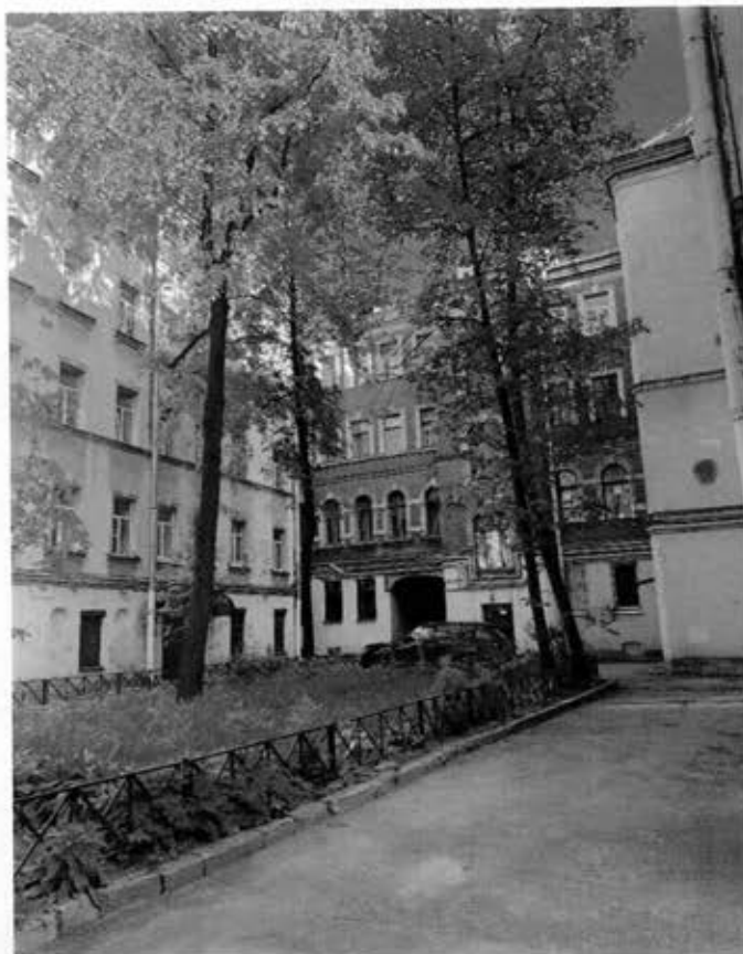
9. Фрагмент дворового фасада и территории объекта культурного наследия с северо-западной стороны. Дефекты (фото от 23.05.2024)
