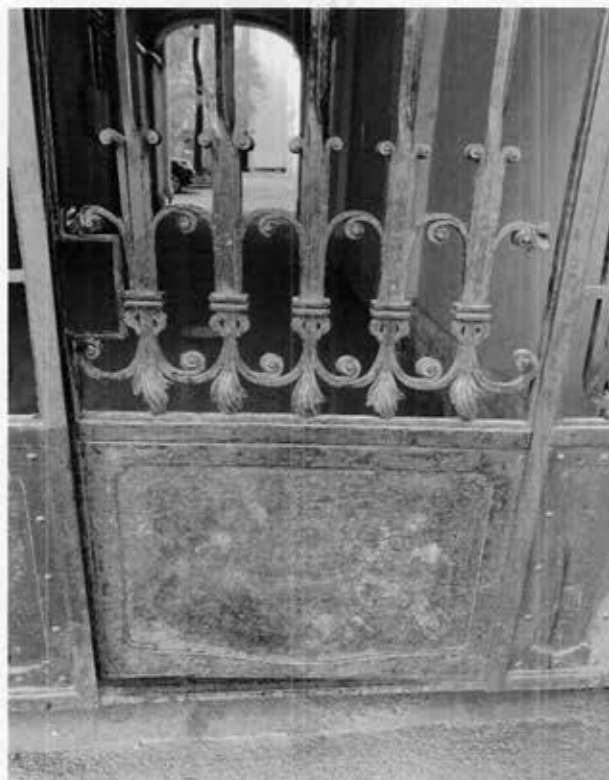
18. Фрагмент лицевого фасада объекта культурного наследия с южной стороны. Дефекты (фото от 23.05.2024)
