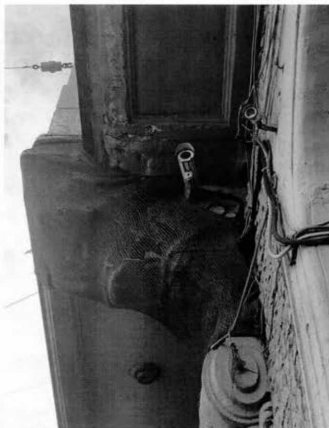
17. Фрагмент лицевого фасада объекта культурного наследия с южной стороны. Дополнительное оборудование. Дефекты (фото от 23.05.2024)
