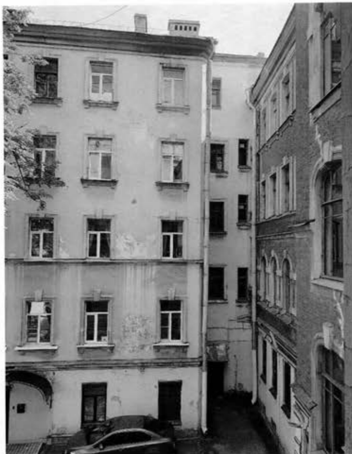
12. Фрагмент дворового фасада и территории объекта культурного наследия с восточной стороны. Дефекты (фото от 06.06.2024)
