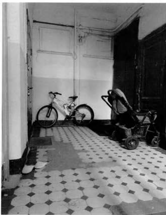
33. Интерьеры. Лестница 3ЛК. Дефекты (фото от 06.06.2024)
