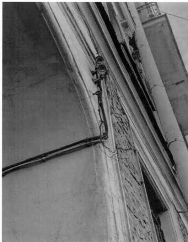
16. Фрагмент лицевого фасада объекта культурного наследия с южной стороны. Дополнительное оборудование. Дефекты (фото от 23.05.2024)
