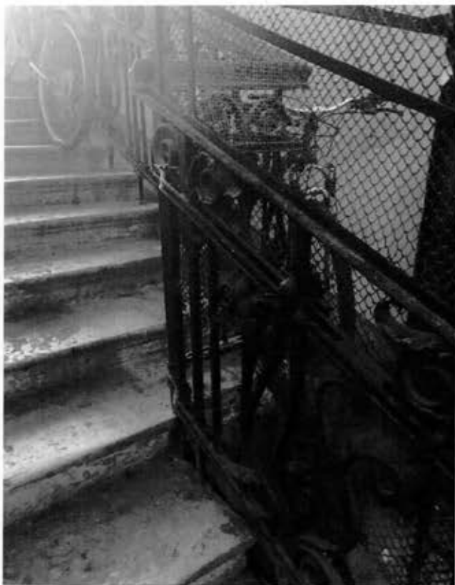
28. Интерьеры. Лестница 1ЛК. Дефекты (фото от 06.06.2024)
