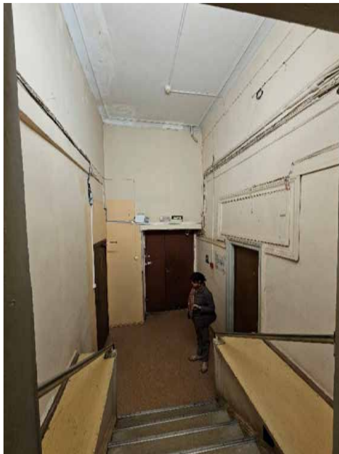
85. Объект культурного наследия федерального значения «Усадьба Демидовых» по адресу: г. Санкт-Петербург, пер. Гривцова, д. 1/64, лит. А, д. 5, лит. А. Главный дом. Общий вид пом. (21-Н) 63 в уровне 3-го этажа (З(Г)-16). Деревянная лестница ЛК-6.
