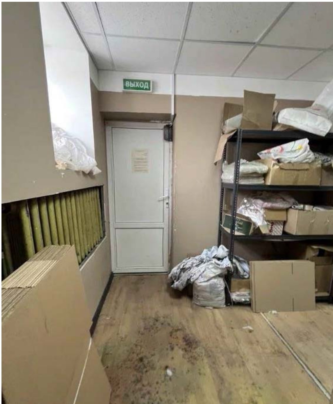
87. Объект культурного наследия федерального значения «Усадьба Демидовых» по адресу: г. Санкт-Петербург, пер. Гривцова, д. 1/64, лит. А, д. 5, лит. А. Восточный флигель. Общий вид пом. (1-Н) 4 в уровне цокольного этажа (0(В)-2). Фотография предоставлена заказчиком.
