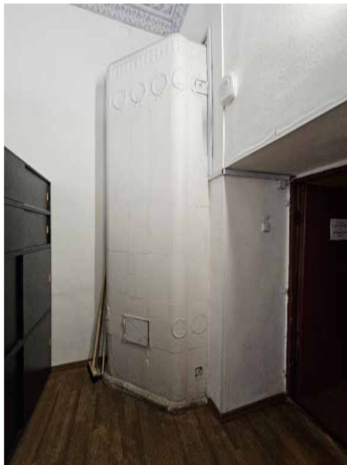
37. Объект культурного наследия федерального значения «Усадьба Демидовых» по адресу: г. Санкт-Петербург, пер. Гривцова, д. 1/64, лит. А, д. 5, лит. А. Главный дом. Угловая печь с закругленными гранями в пом. (21-Н) 55 в уровне 2-го этажа (2(Г)-20).
