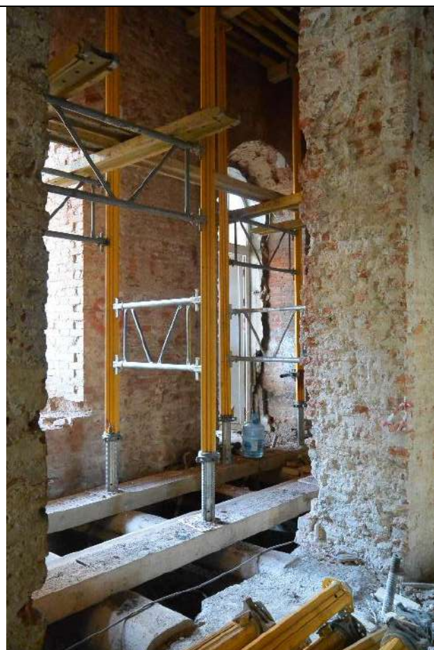
68. Фрагмент пом. 30-Н (3, 4, 5, 6) в уровне 1-го этажа. Западная часть лицевого корпуса по Миллионной улице.
