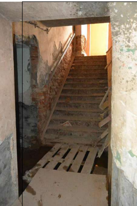
15. Общий вид первого марша в объеме лестницы Л-6 в уровне подвального этажа. Северная часть восточного лицевого корпуса.
