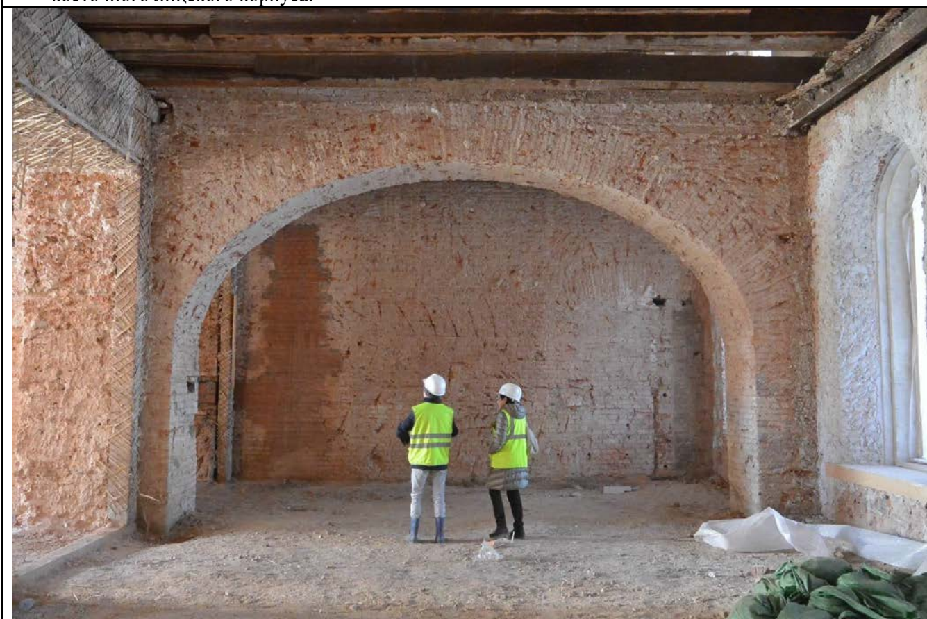
50. Общий вид пом. 37-Н (67, 68) в уровне 1-го этажа. Вестибюль в центральной части восточного лицевого корпуса.
