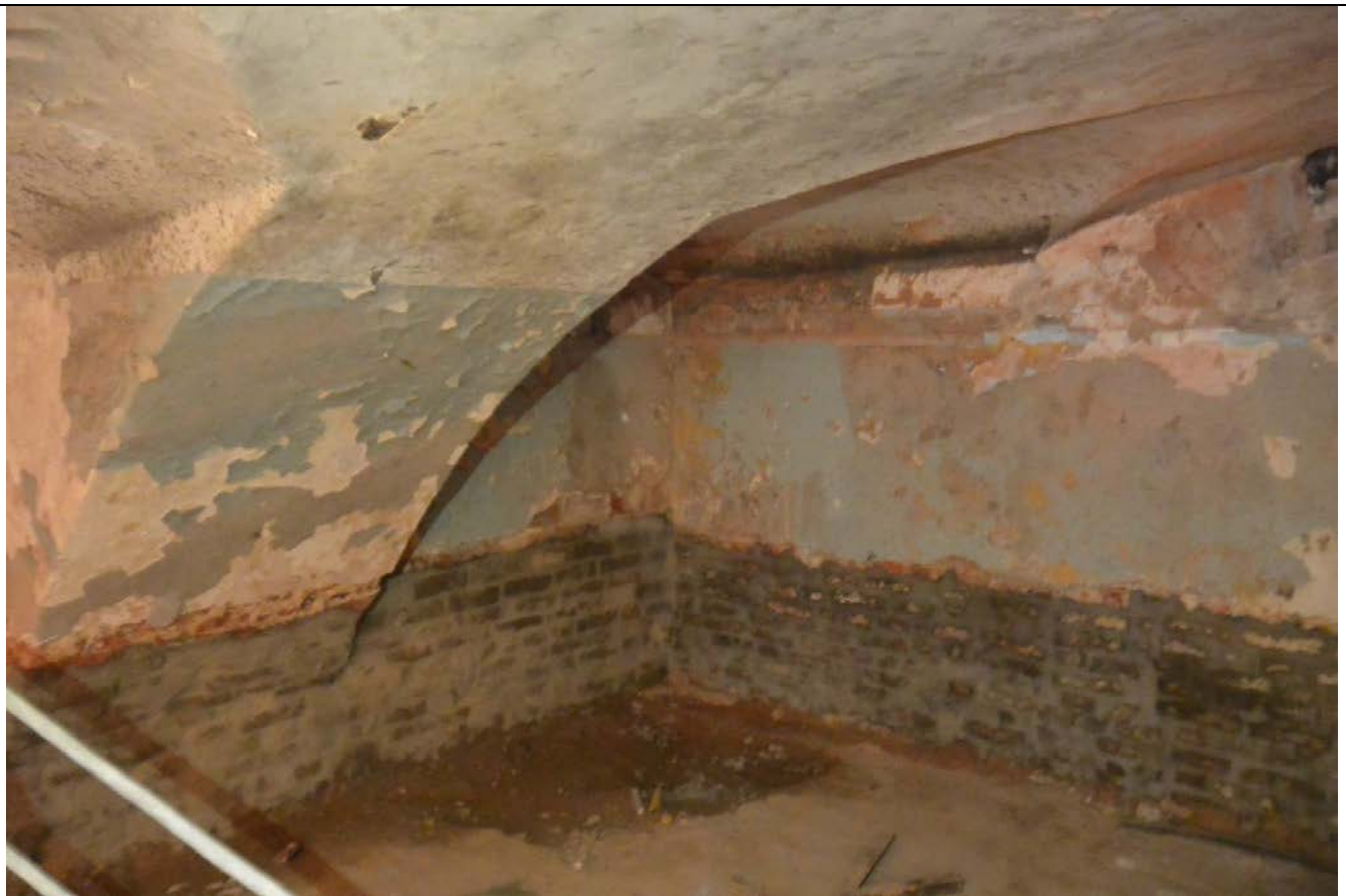
29. Фрагмент пом. 7-Н (29) в уровне подвального этажа. Центральная часть восточного лицевого корпуса.
