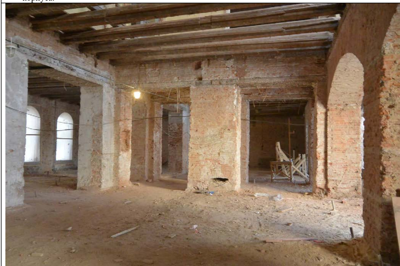
59. Общий вид пом. 33-Н (14) в уровне 1-го этажа. Северная часть восточного лицевого корпуса.
