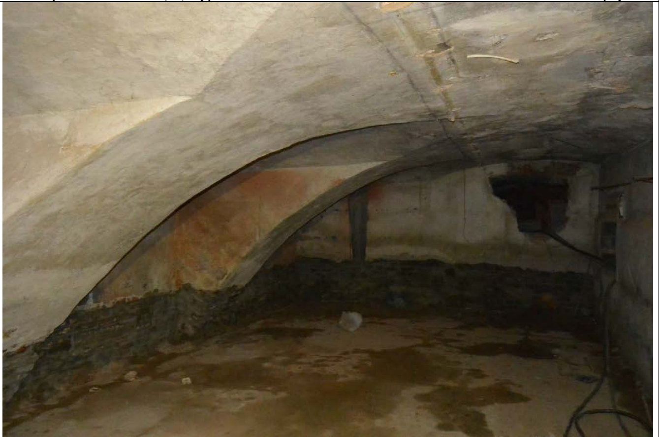
39. Фрагмент пом. 7-Н (52) в уровне подвального этажа. Южная часть восточного лицевого корпуса.
