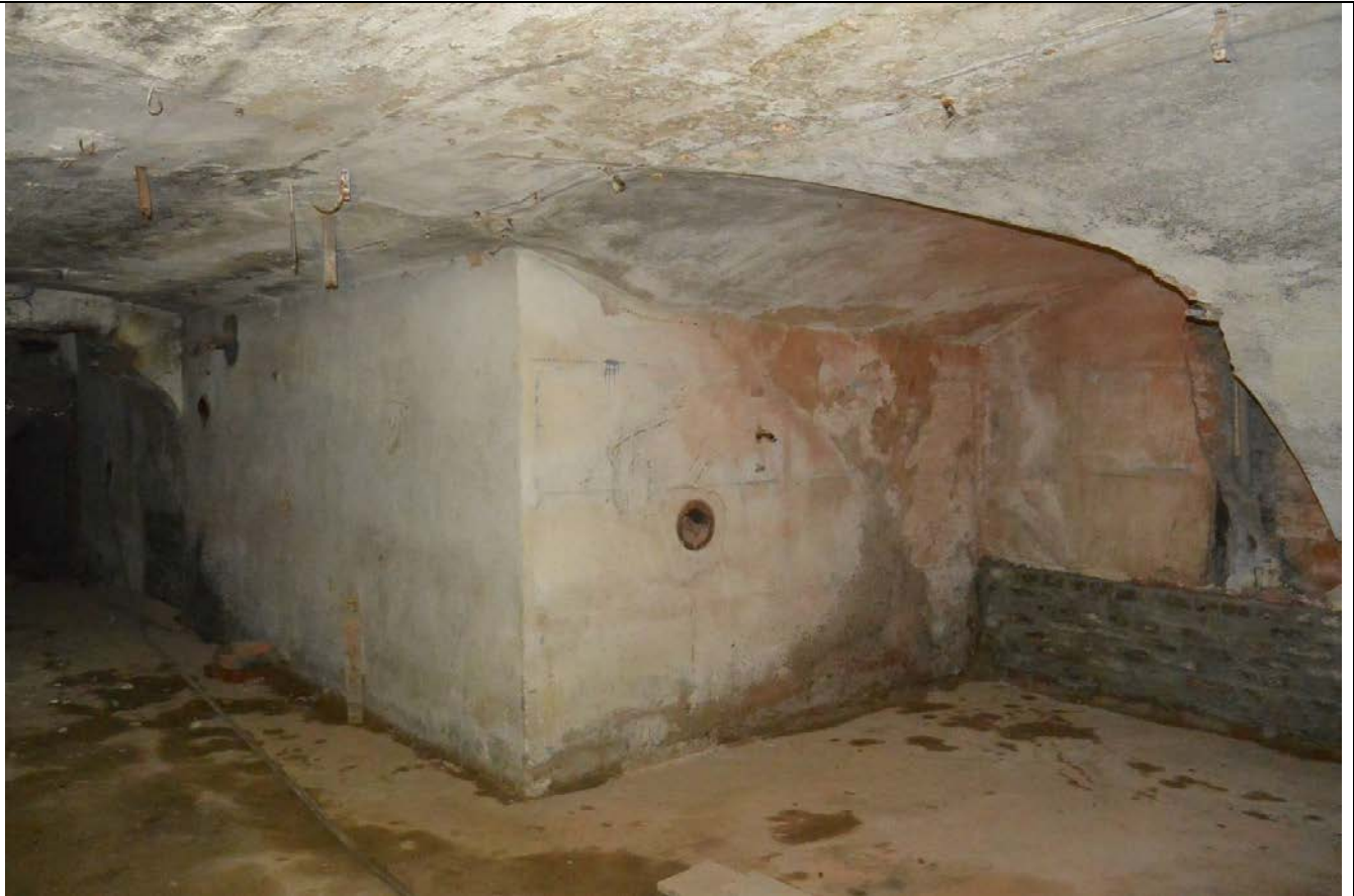
38. Фрагмент пом. 7-Н (52) в уровне подвального этажа. Южная часть восточного лицевого корпуса.
