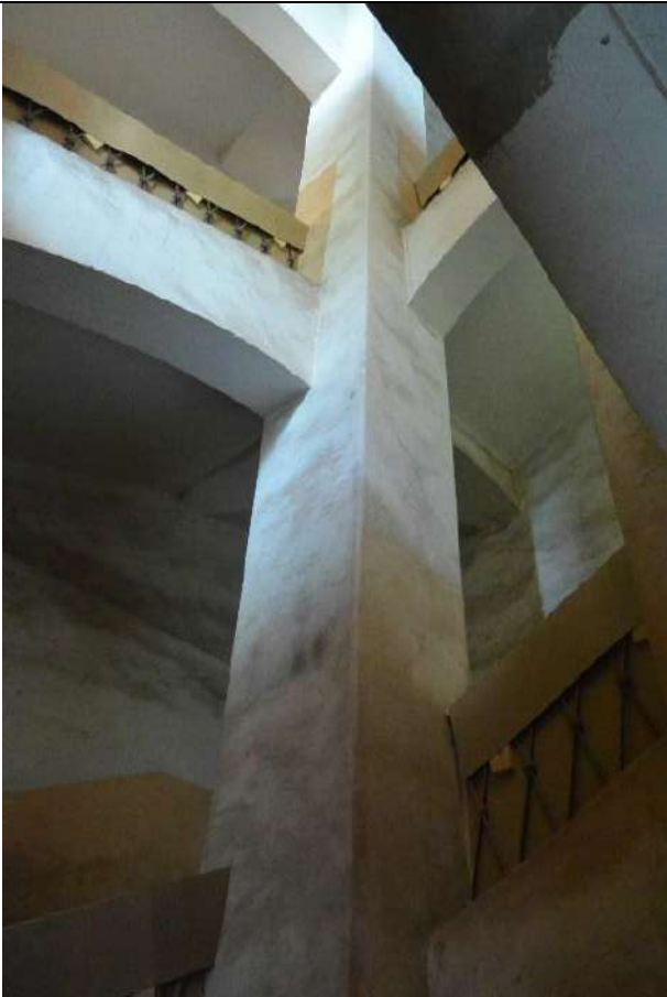
40. Фрагмент интерьера лестничного объёма Л-10 в уровне 1-го этажа. Южная часть восточного лицевого корпуса.
