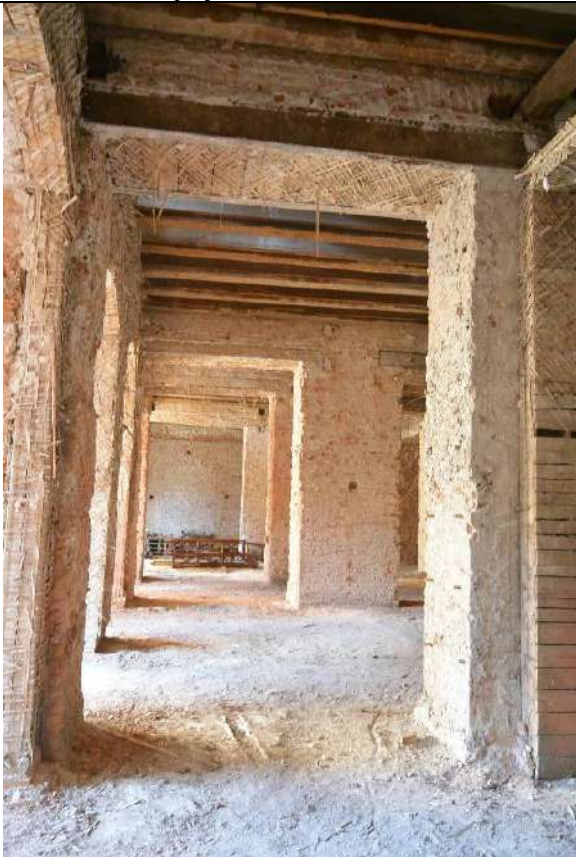
47. Общий вид пом. 37-Н (59) в уровне 1-го этажа. Вестибюль в центральной части восточного лицевого корпуса.
