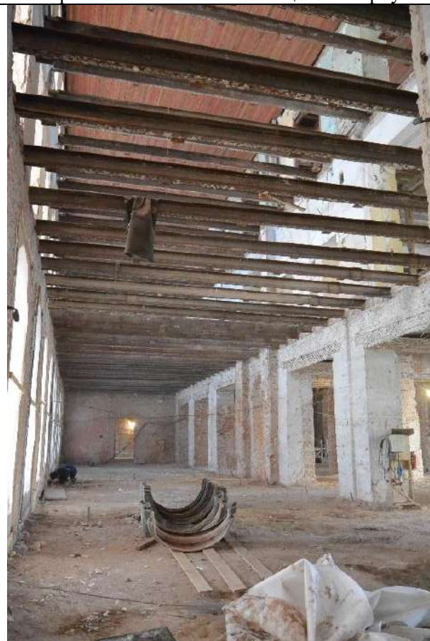
57. Общий вид пом. 33- Н (3, 4, 5, 6, 7, 8, 9, 10) в уровне 1-го этажа. Северная часть восточного лицевого корпуса.
