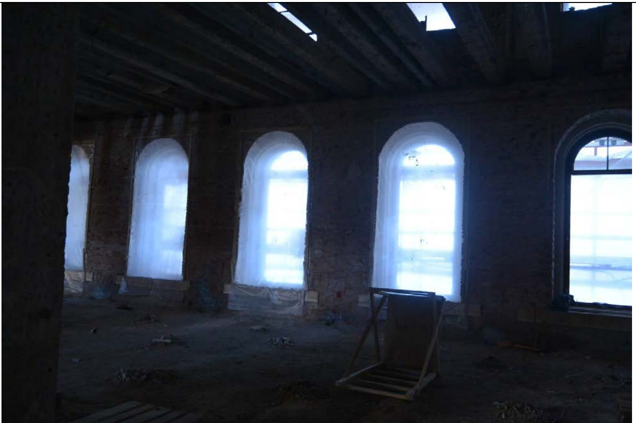
46. Общий вид пом. 37-Н (49, 50, 51) в уровне 1-го этажа. Вестибюль в центральной части восточного лицевого корпуса.
