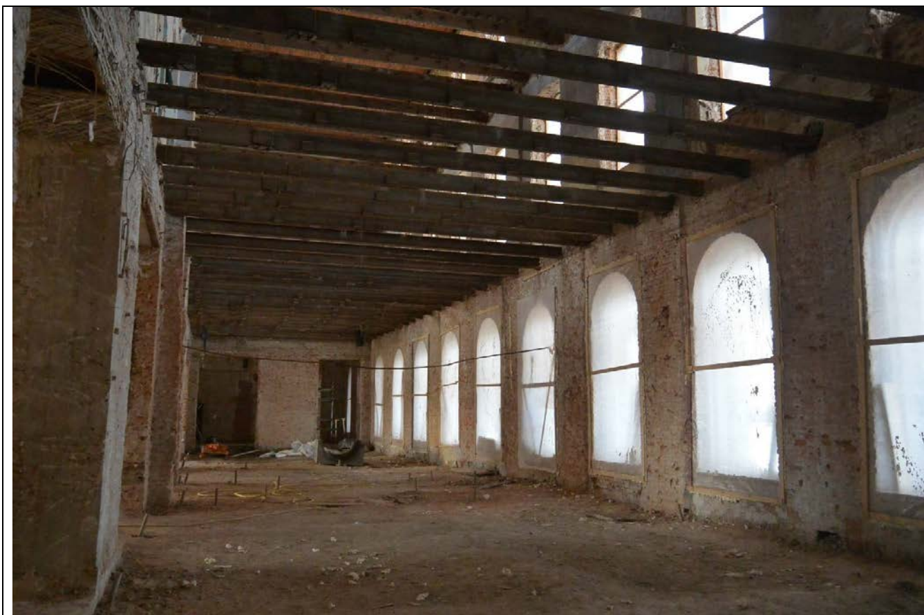
58. Общий вид пом. 33- Н (5, 6, 7, 8, 9, 10) в уровне 1-го этажа. Северная часть восточного лицевого корпуса.
