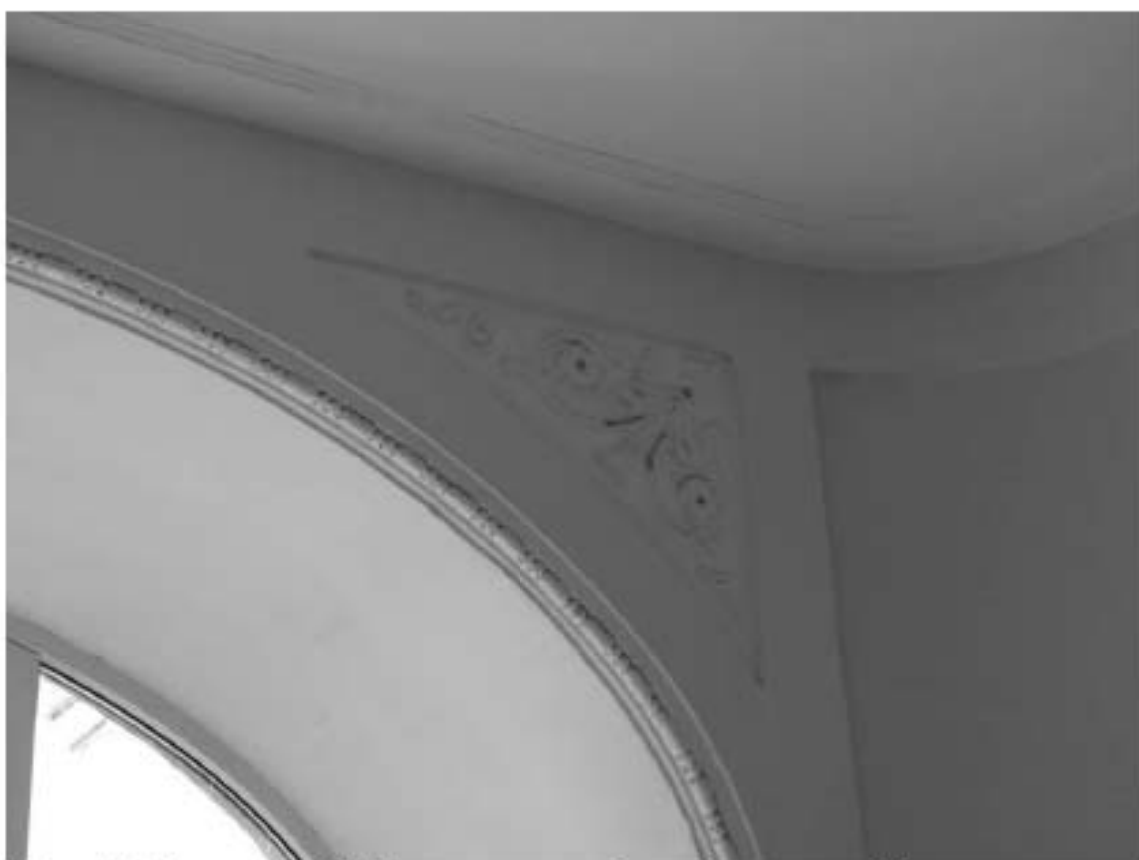
Фото 134. Лестница № 3. Площадка между 2-м и 3-м этажом. Оформление стены. Съемка 26.04.2021 г. Михайловская Г. В.
