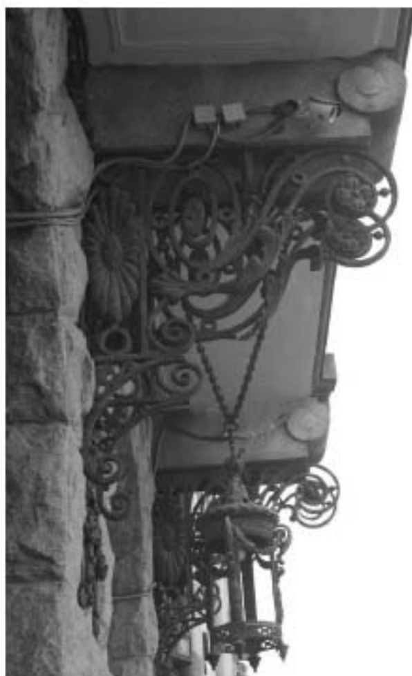
Фото 18. Гранитные кронштейны, кронштейны черного металла, поддерживающие балкон. Съемка 26.04.2021 г. Михайловская Г. В.
