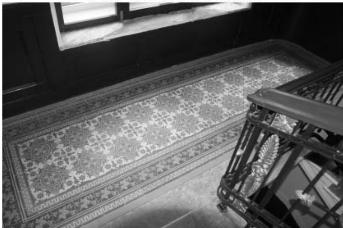
Фото 61. Лестница № 1. Площадка между 4-м и 5-м этажом. Покрытие пола. Съемка 26.04.2021 г. Михайловская Г. В.
