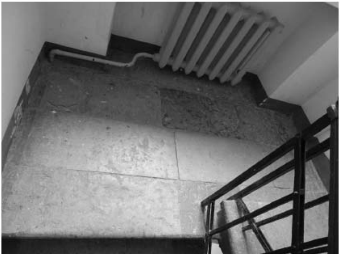
Фото 195. Лестница № 4. Площадка между 2-м и 3-м этажом. Покрытие пола. Съемка 26.04.2021 г. Михайловская Г. В.
