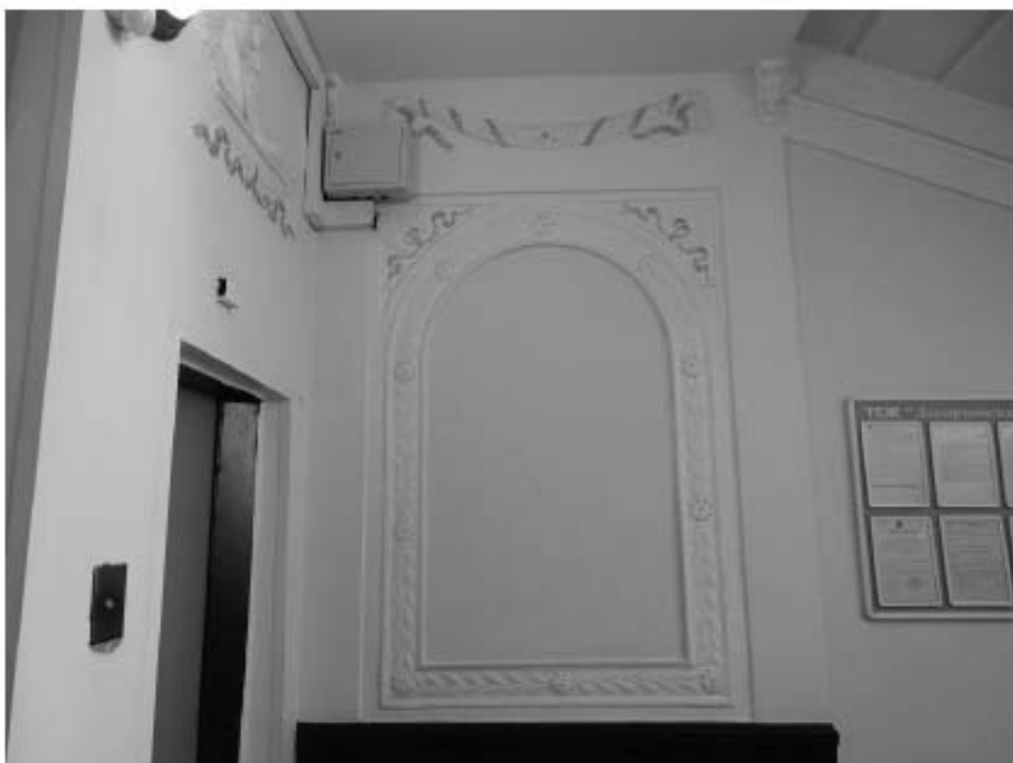
Фото 118. Лестница № 3. Площадка 1-го этажа. Панно с полуциркульным завершением. Съемка 26.04.2021 г. Михайловская Г. В.
