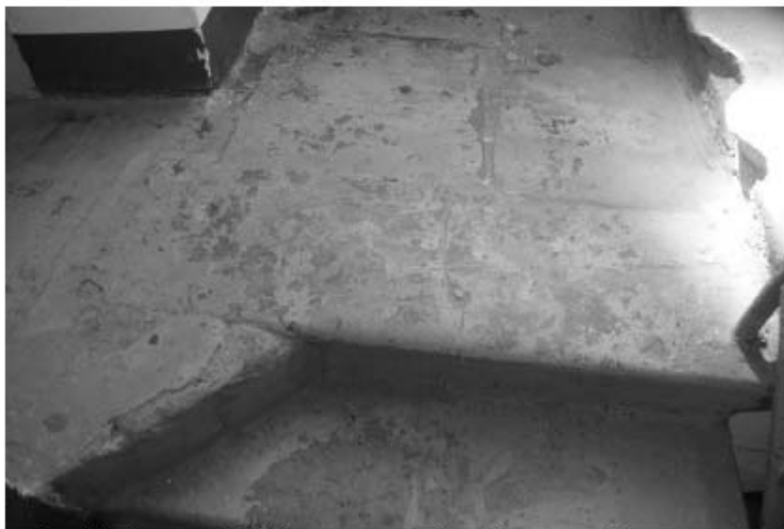
Фото 93. Лестница № 2. Площадка между 1-м и 2-м этажом. Покрытие пола. Съемка 26.04.2021 г. Михайловская Г. В.
