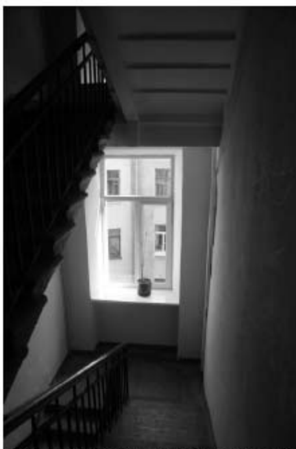
Фото 190. Лестница № 4. Площадка между 5-м и 6-м этажом. Съемка 26.04.2021 г. Михайловская Г. В.
