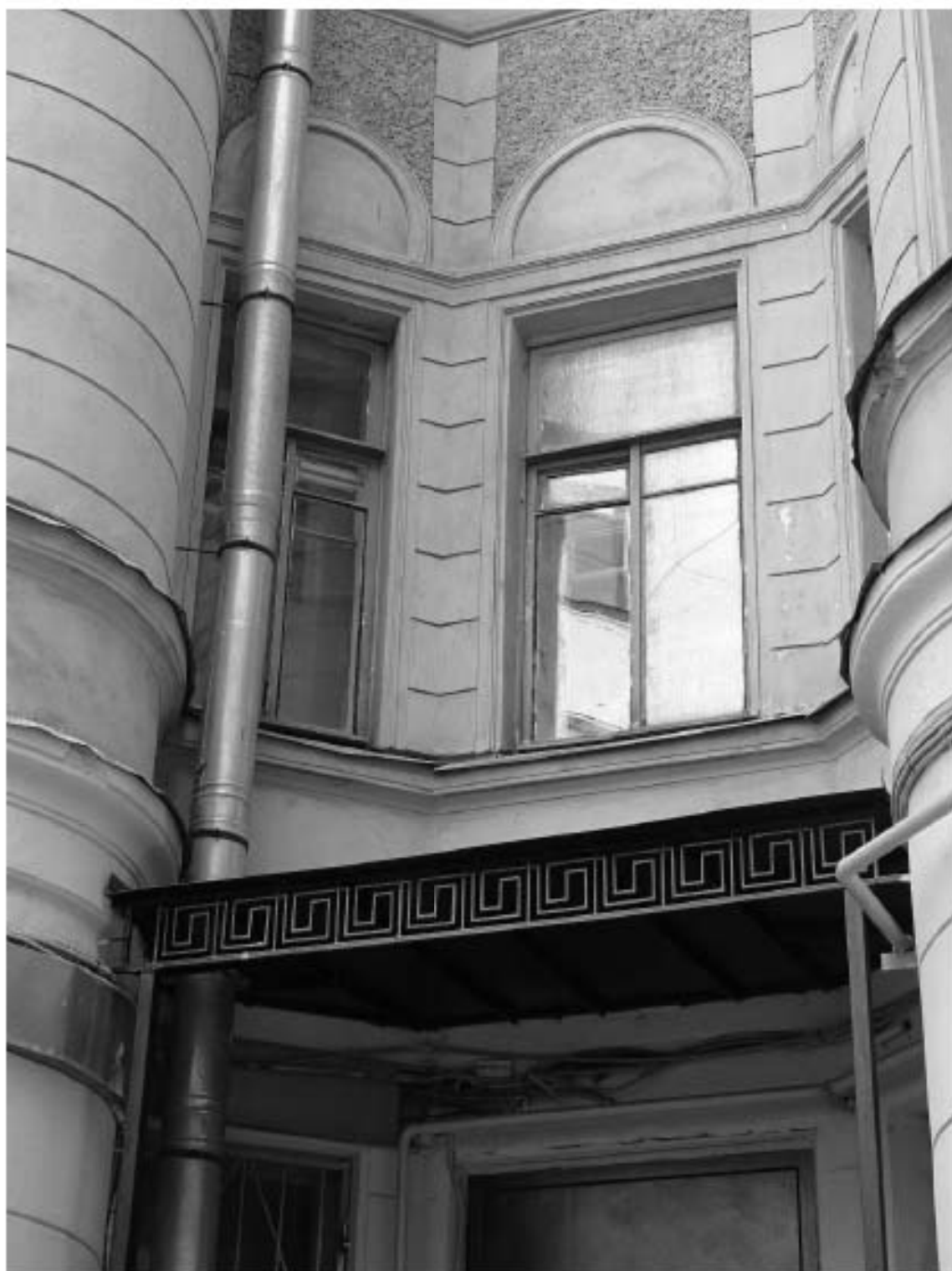
Фото 37. Фрагмент южного и восточного фасада внутреннего двора. 2-й этаж. Съемка 26.04.2021 г. Михайловская Г. В.
