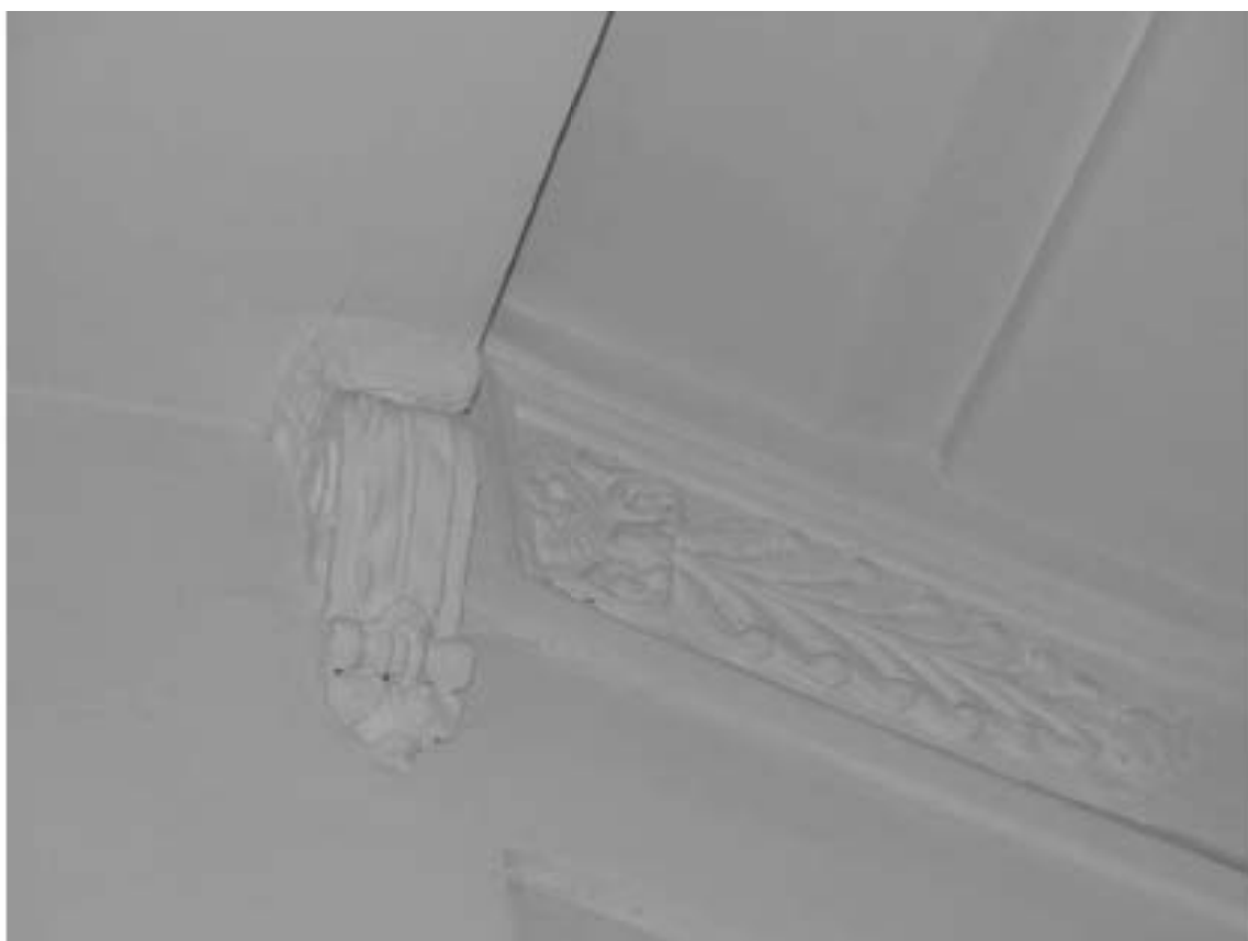
Фото 121. Лестница № 3. Площадка 1-го этажа. Орнаментированные кронштейны над дверными проемами. Съемка 26.04.2021 г. Михайловская Г. В.
