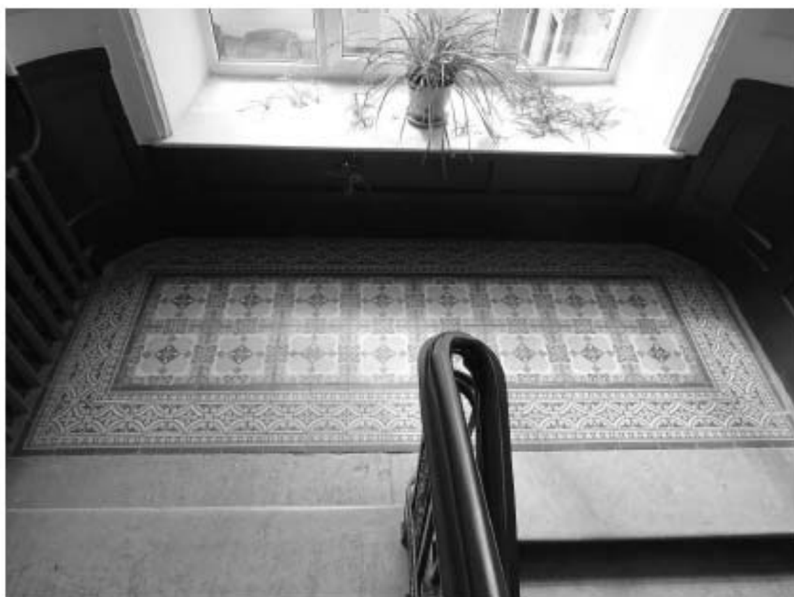
Фото 132. Лестница № 3. Площадка между 2-м и 3-м этажом. Покрытие пола. Съемка 26.04.2021 г. Михайловская Г. В.
